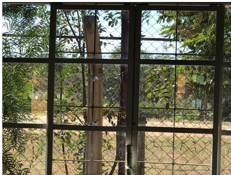
Figura 53 – Vidro quebrado em sala de aula
