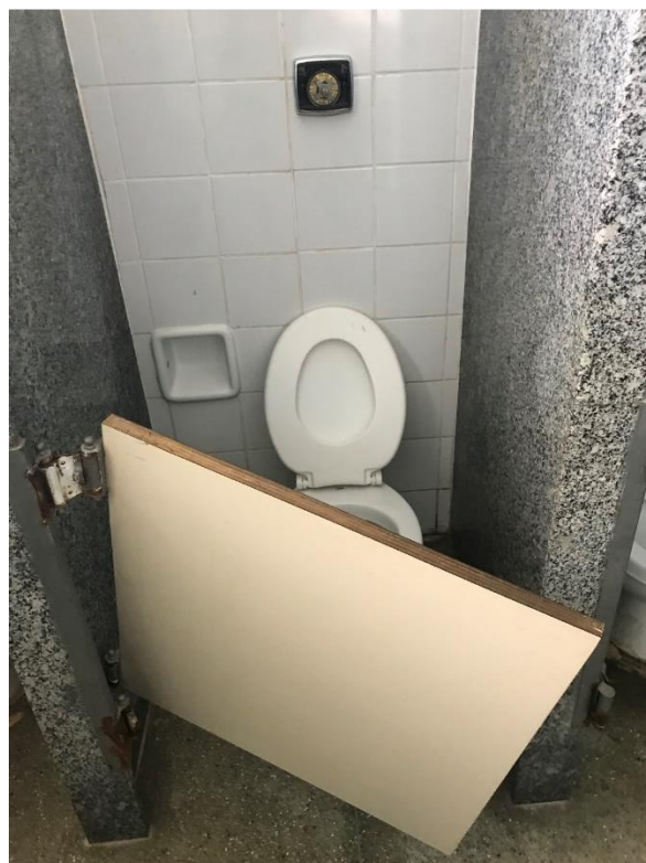
Figura 16 – Porta solta em banheiro
