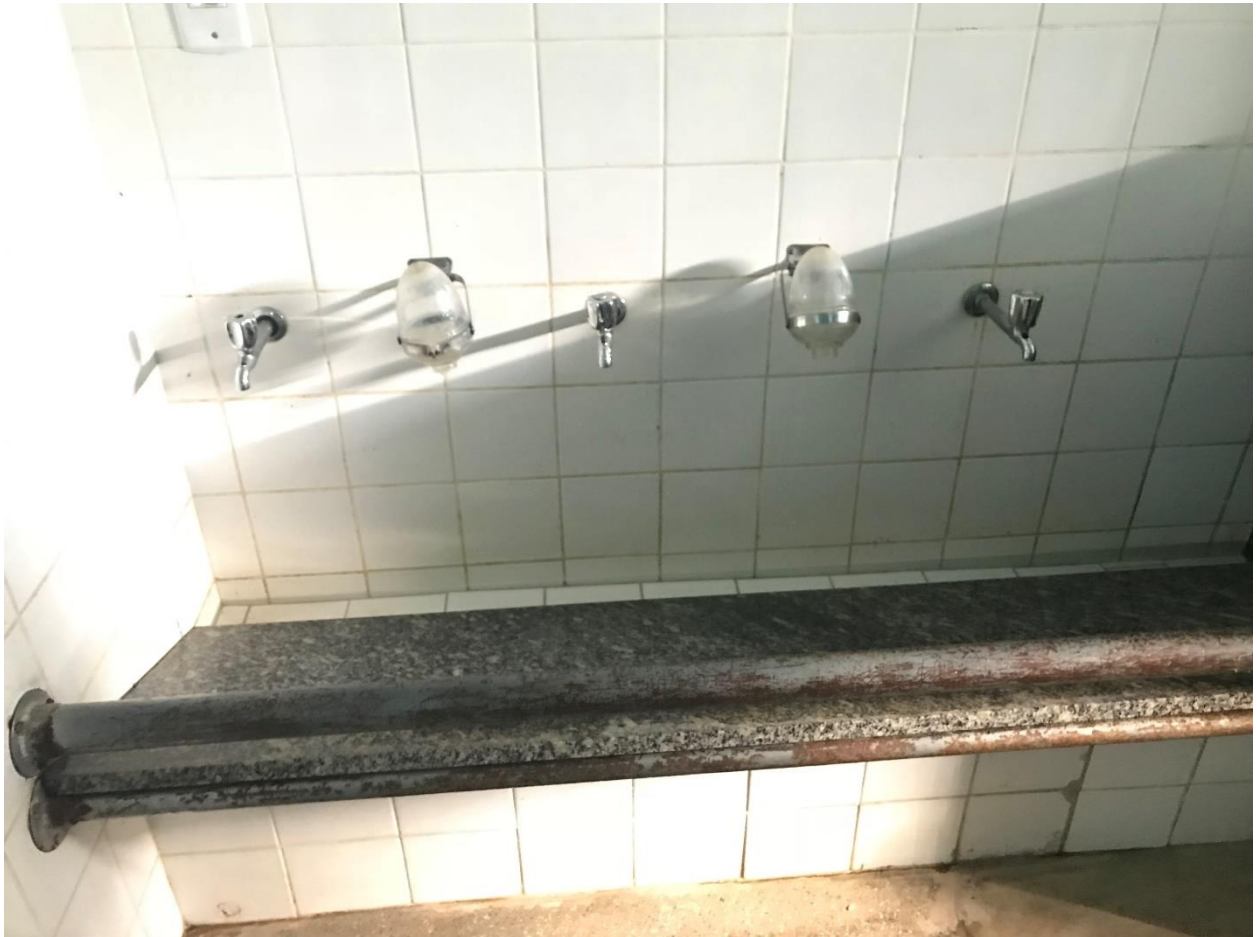
Figura 15 – Anteparos da pia com sinais de ferrugem
