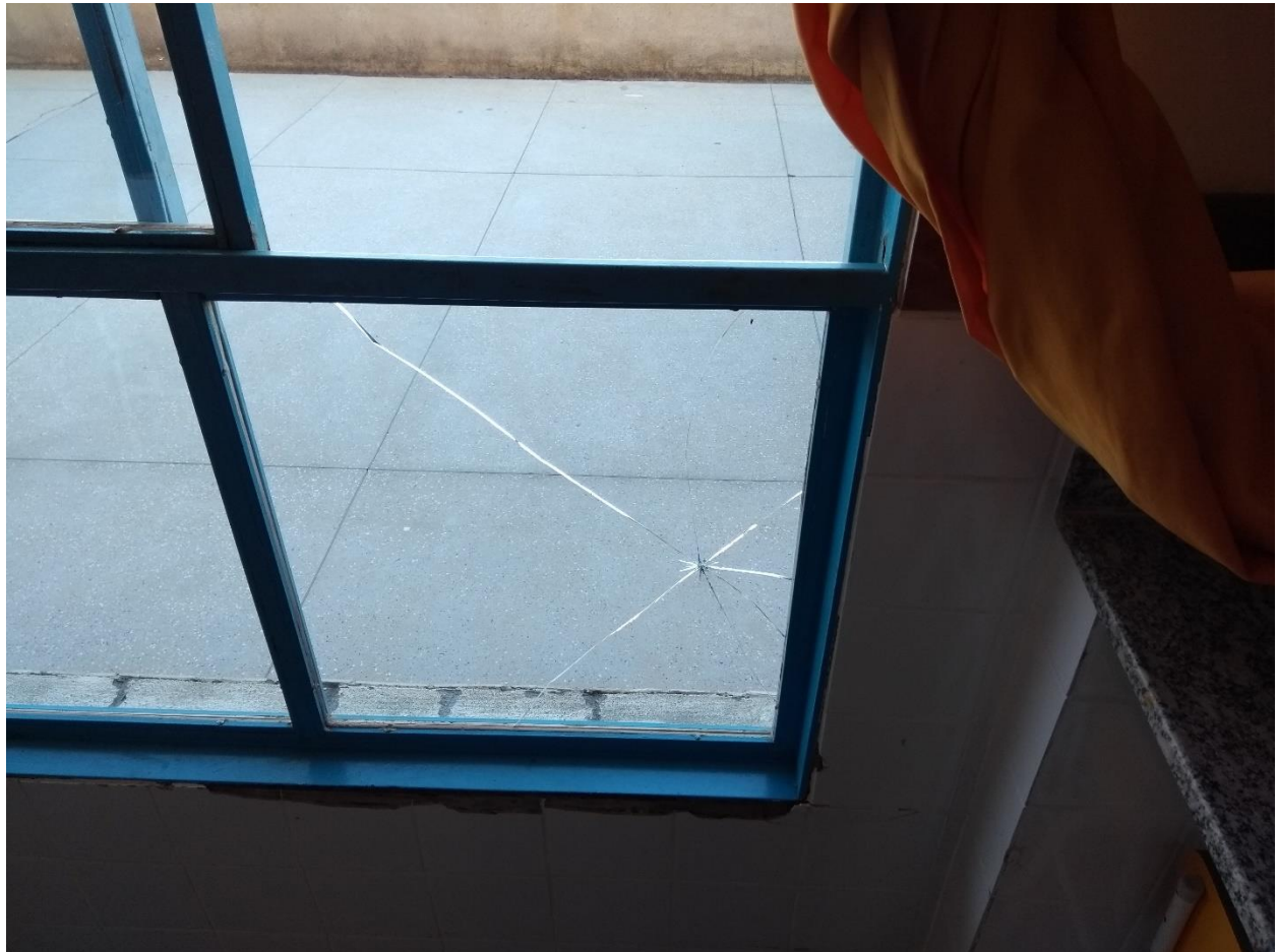
Figura 11 – Vidro quebrado na sala do maternal
