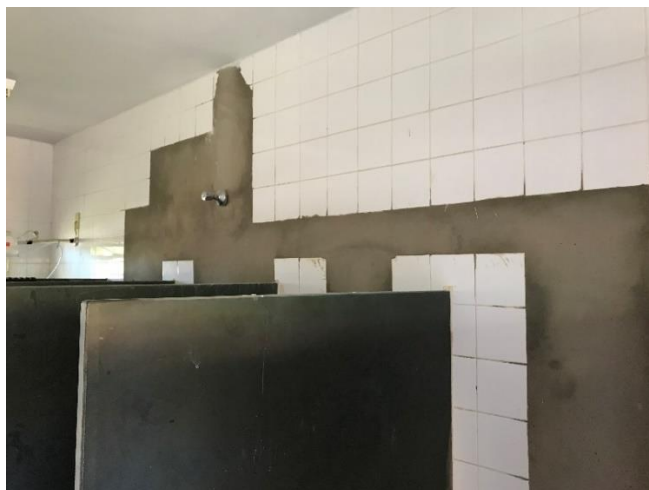
Figura 50 – Parede sem azulejos
