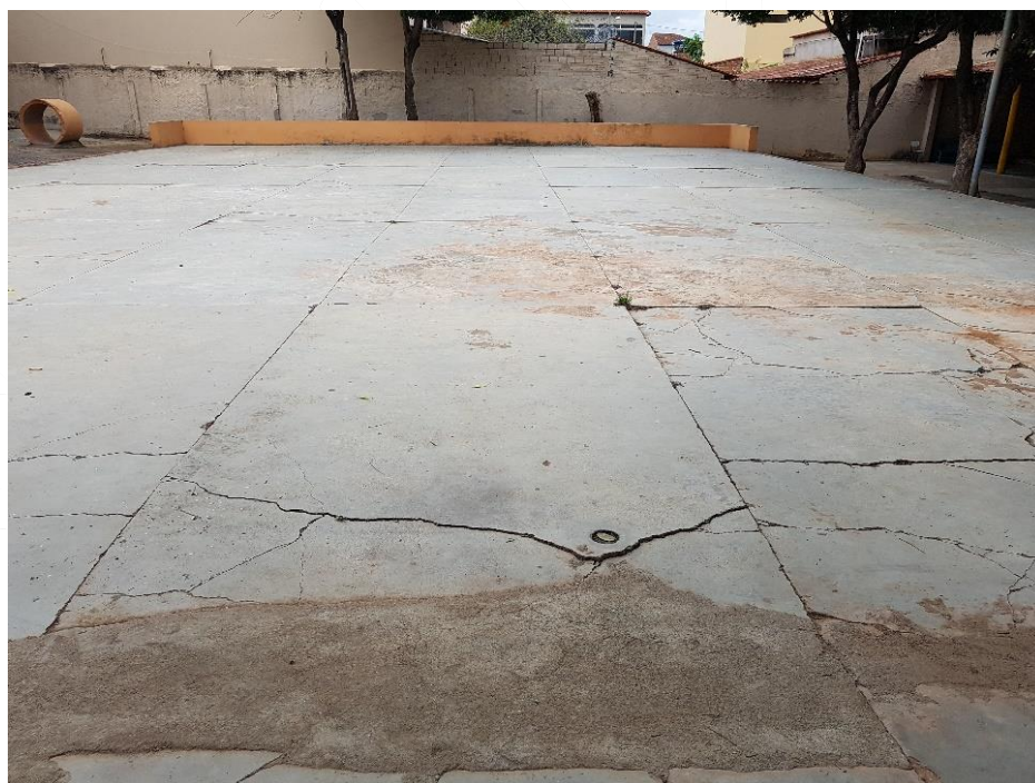
Figura 20 – Detalhe das rachaduras na quadra
