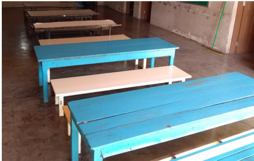
Figura 25 – Tampo de mesa danificados no refeitório
