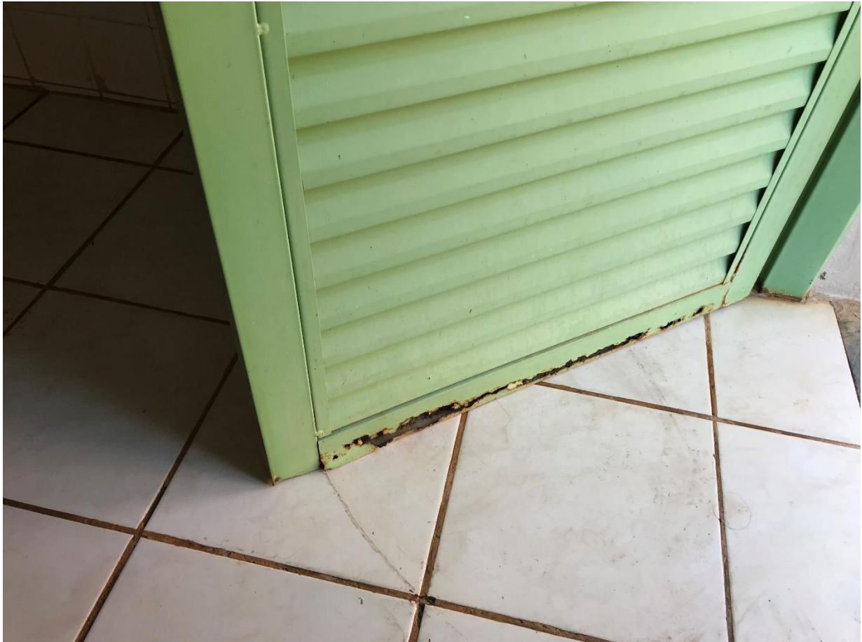
Figura 49 – Porta danificada no banheiro
