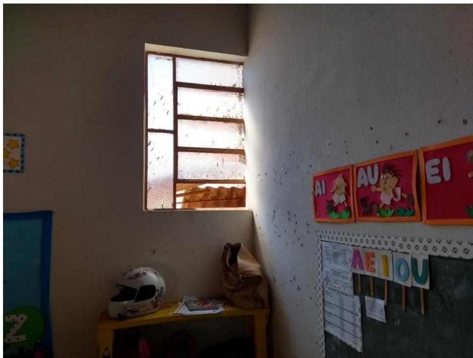
Figura 27 – Falta de vidro na janela
