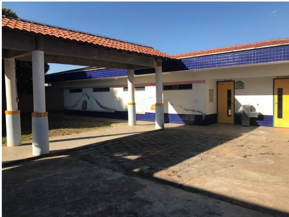
Figura 7 – Paredes descascadas na área externa
