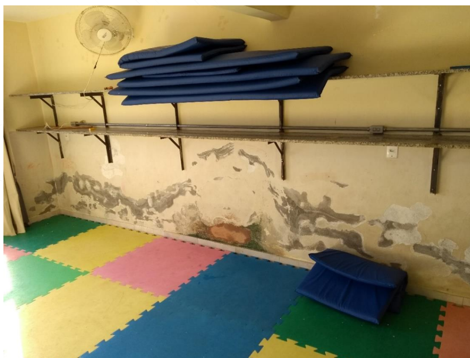
Figura 8 – Paredes descascadas na área interna
