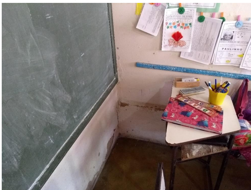
Figura 39 – Paredes descascadas em sala de aula
