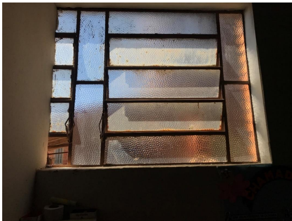
Figura 28 – Falta de vidro na janela
