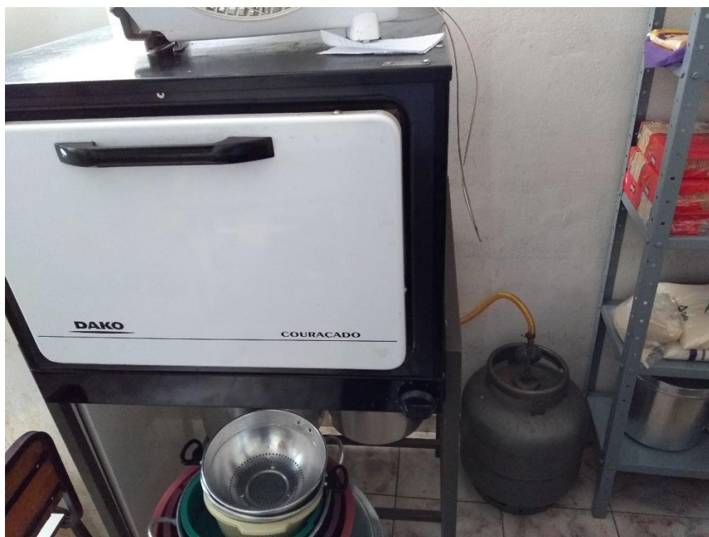
Figura 35 – Botijão instalado junto ao forno
