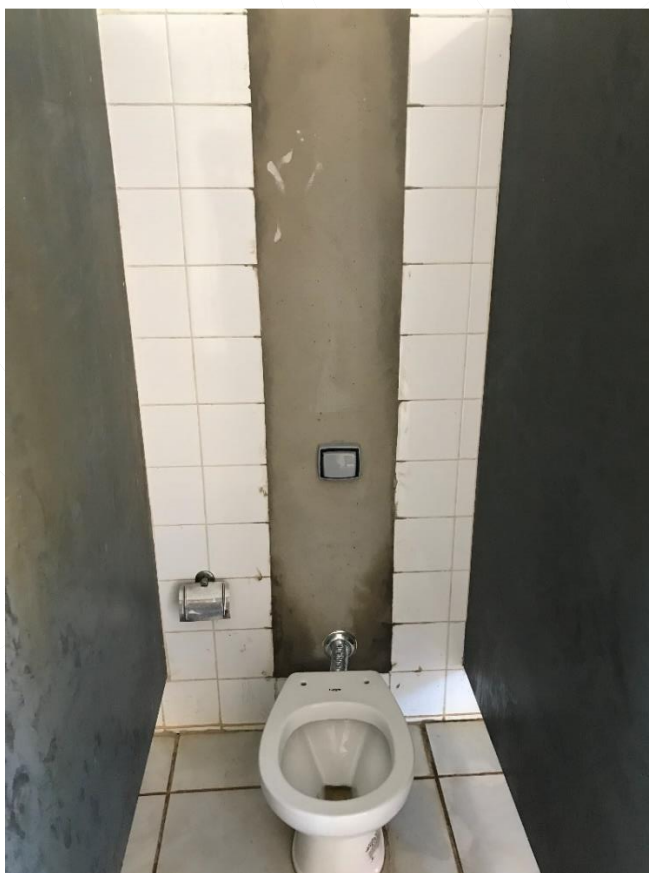
Figura 51 – Parede sem azulejos
