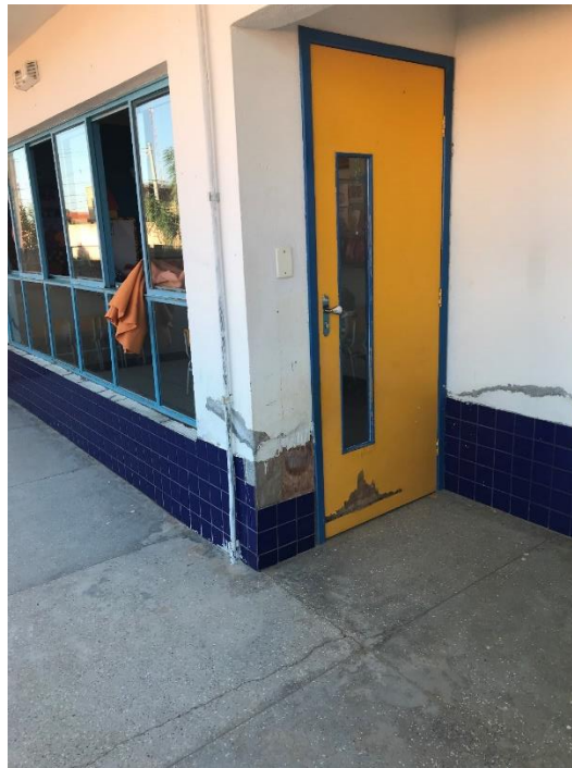
Figura 9 – Porta danificada em sala de aula
