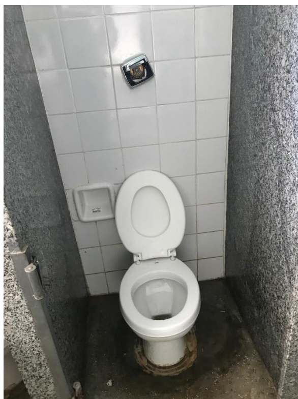
Figura 17 – Sanitário sem porta e com vazamento
