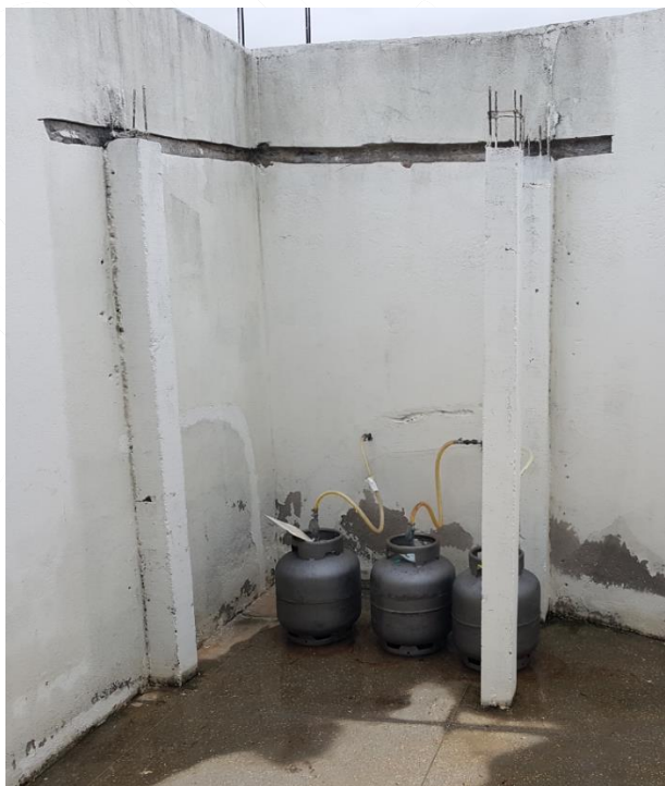
Figura 13 – Instalação externa de botijões
