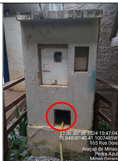
Figura 5 - Detalhe de cabos elétricos aparentes
