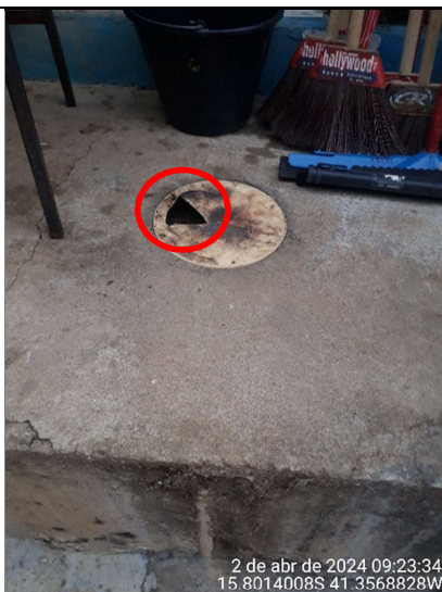
Figura 25 - Detalhe da tampa danificada da caixa de gordura
