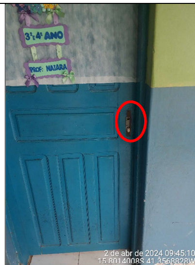
Figura 36 - Detalhe da porta sem fechadura
