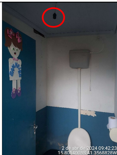
Figura 24 - Detalhe da ausência de lâmpada no banheiro feminino
