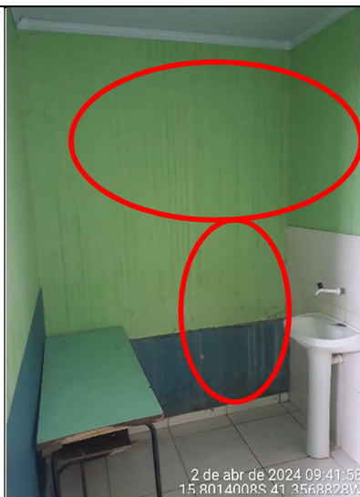
Figura 37 - Detalhe de manchas de infiltração na parede
