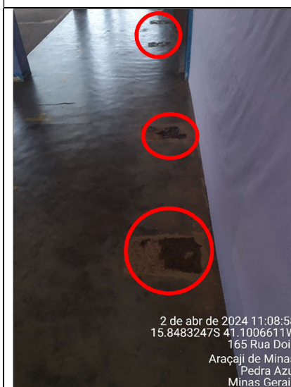
Figura 6 - Detalhe de manchas no piso do pátio
