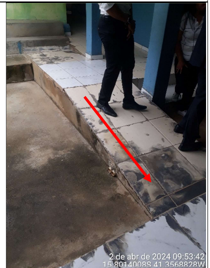
Figura 35 - Detalhe de piso liso e manchado na rampa interna
