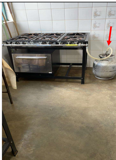
Figura 22 - Detalhe do botijão de gás no fogão e forno
