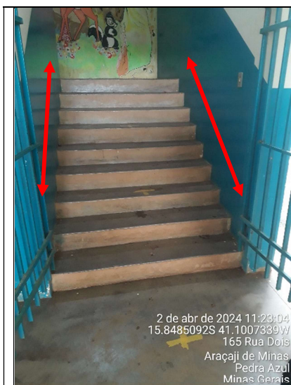
Figura 3 - Detalhe de escada sem corrimão
