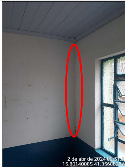
Figura 31 - Detalhe de trinca na parede da sala de aula
