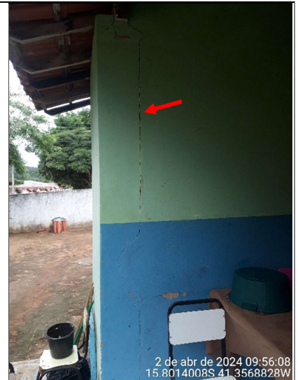
Figura 32 - Detalhe de trinca na parede, lado externo
