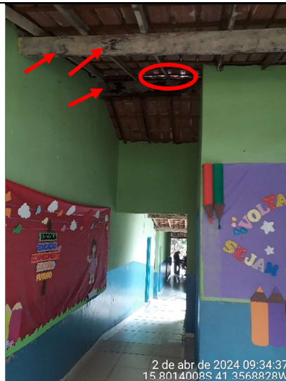
Figura 34 - Detalhes de frestas de luz na cobertura e manchas de umidade no madeiramento
