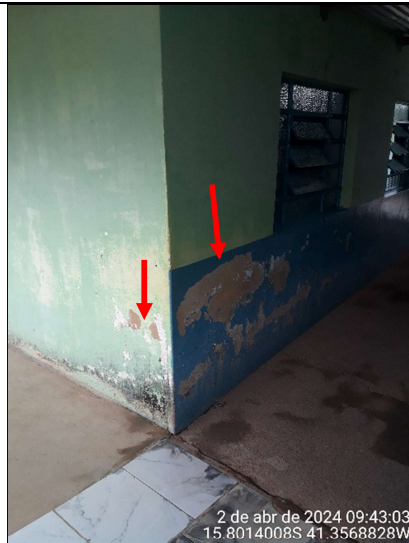
Figura 30 - Detalhes de desgaste na pintura da parede, lado externo
