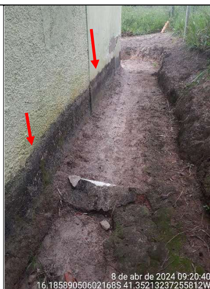
Figura 67 - Detalhe de manchas de umidade na parede, lado externo
