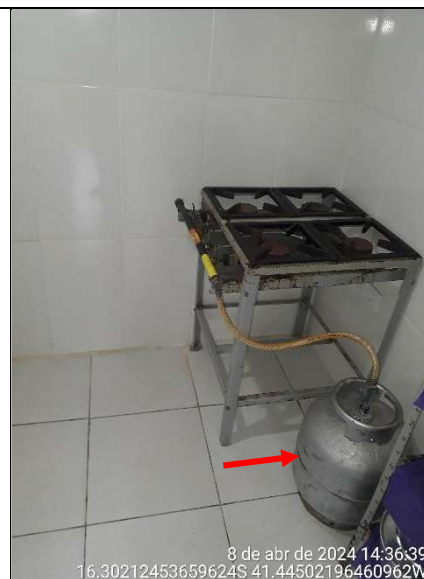
Figura 83 - Detalhe do botijão de GLP no fogão
