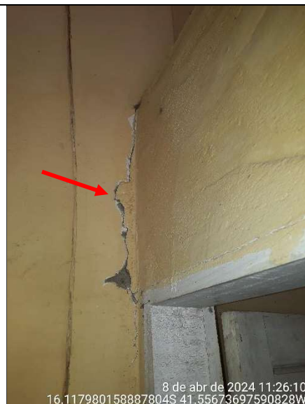
Figura 23 - Detalhe de trinca na parede, lado interno
