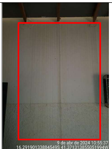
Figura 52 - Detalhe de marcas de infiltrações na parede
