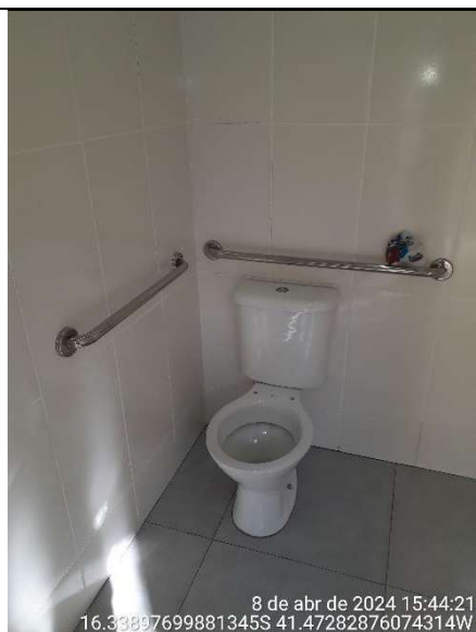
Figura 105 - Detalhe de bacia sanitária sem assento
