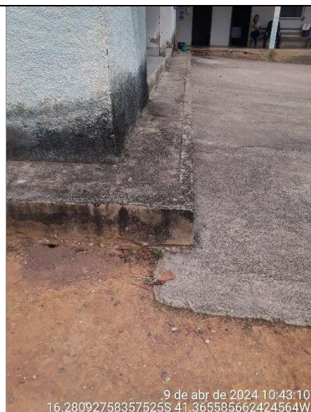
Figura 36 - Detalhe da ausência de rampa de acesso à escola
