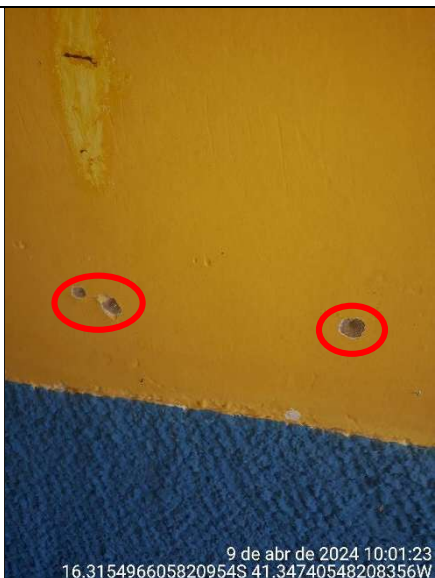
Figura 91 - Detalhe de furos na parede, lado interno
