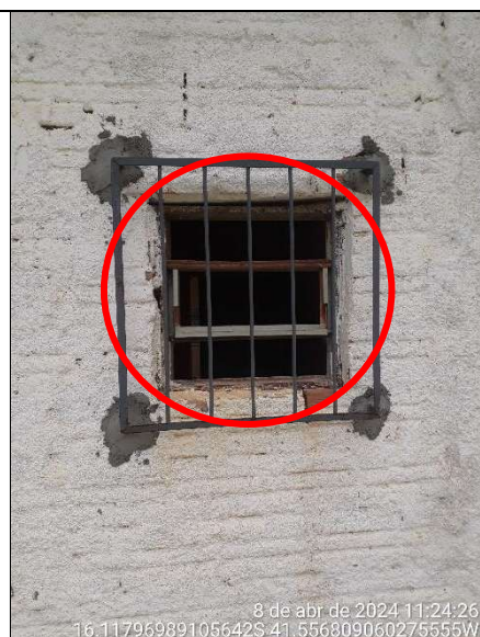
Figura 27 - Detalhe de janela sem vidros
