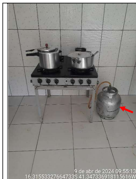
Figura 99 - Detalhe do botijão de GLP no fogão
