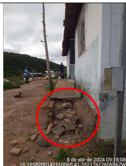
Figura 56 - Detalhe da calçada frontal quebrada
