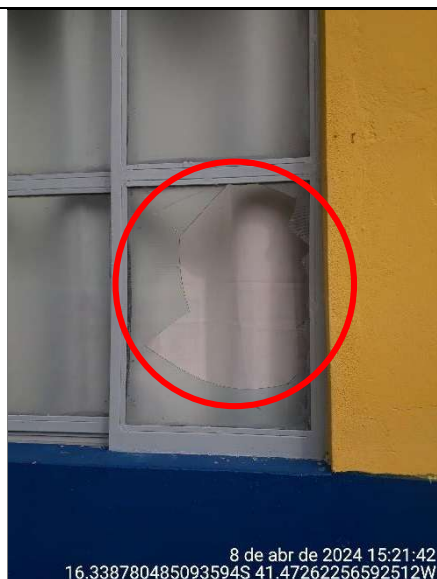
Figura 111 - Detalhe da janela da sala de aula com vidro quebrado
