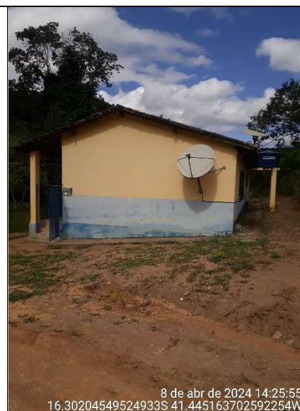
Figura 86 - Detalhe da ausência de muro ou cerca de fechamento do terreno da escola
