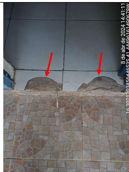
Figura 71 - Detalhe de piso da sala de aula quebrado
