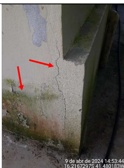
Figura 7 - Detalhe de trinca e manchas de umidade na parede, lado externo
