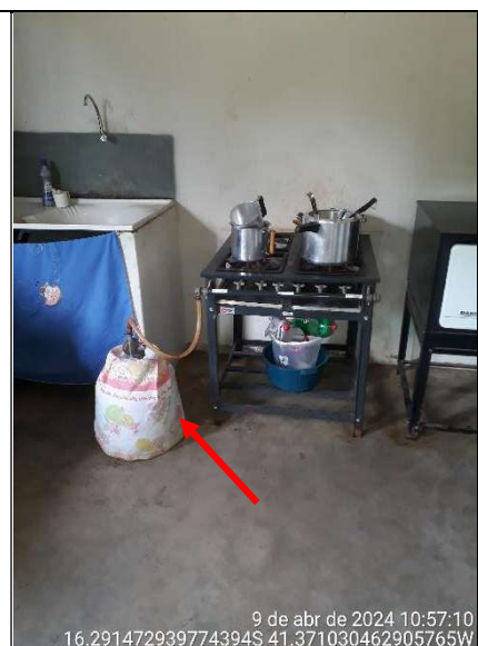
Figura 53 - Detalhe do botijão de GLP no fogão
