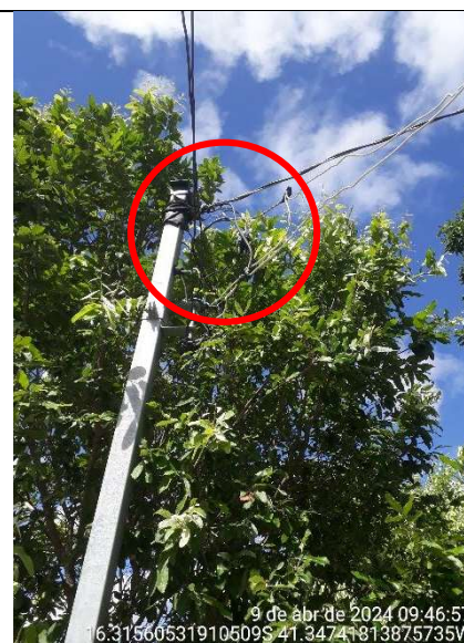
Figura 101 - Detalhe de cabos elétricos aparentes e com remendos
