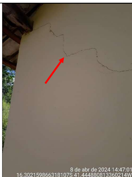
Figura 73 - Detalhe de trinca na parede, lado externo
