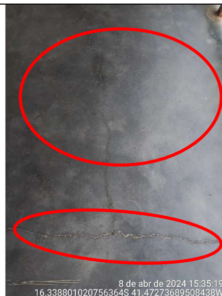
Figura 104 - Detalhe de trincas e manchas no piso da sala de aula
