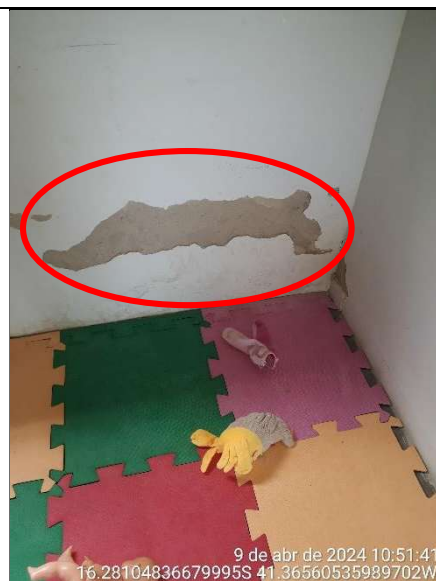
Figura 41 - Detalhe de problema na pintura da sala de aula
