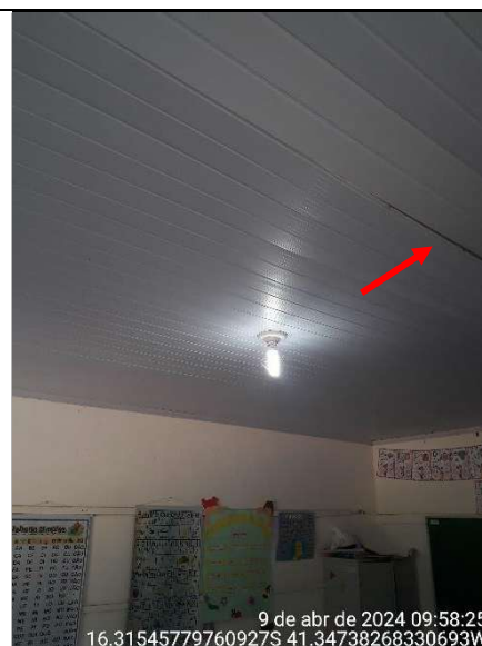
Figura 98 - Detalhe de infiltração de água no forro da sala de aula
