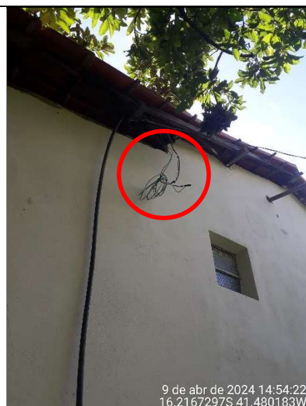
Figura 14 - Detalhe de cabo elétrico aparente
