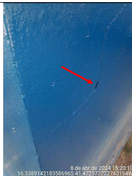
Figura 107 - Detalhe de trinca na parede, lado externo
