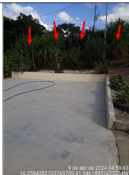
Figura 12 - Detalhe da ausência de muro de fechamento do terreno
