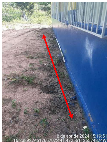
Figura 102 - Detalhe da ausência da calçada perimetral
