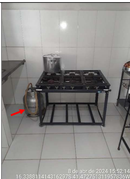
Figura 109 - Detalhe de botijão de GLP no fogão
