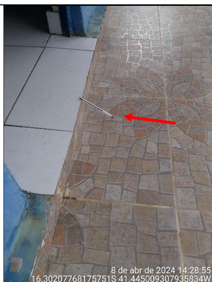
Figura 72 - Detalhe de desnível entre piso da sala de aula e área externa
