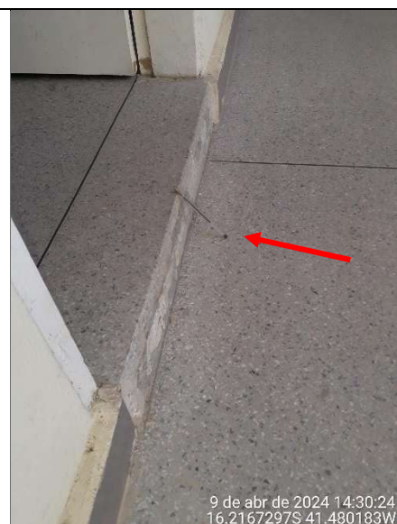
Figura 5 - Detalhe de desnível na entrada da sala de aula
