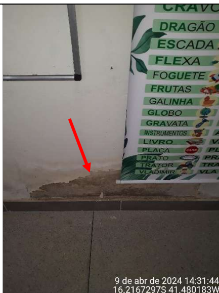
Figura 10 - Detalhe de desgaste no revestimento e pintura da sala de aula
