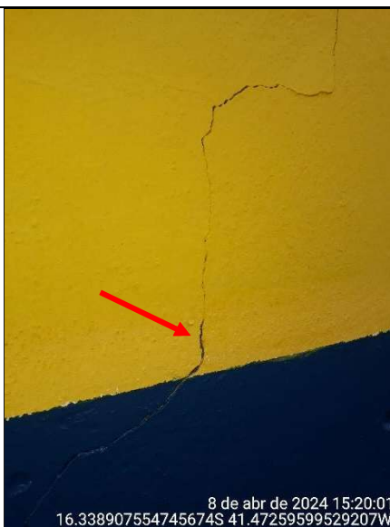
Figura 106 - Detalhe de trinca na parede, lado externo
