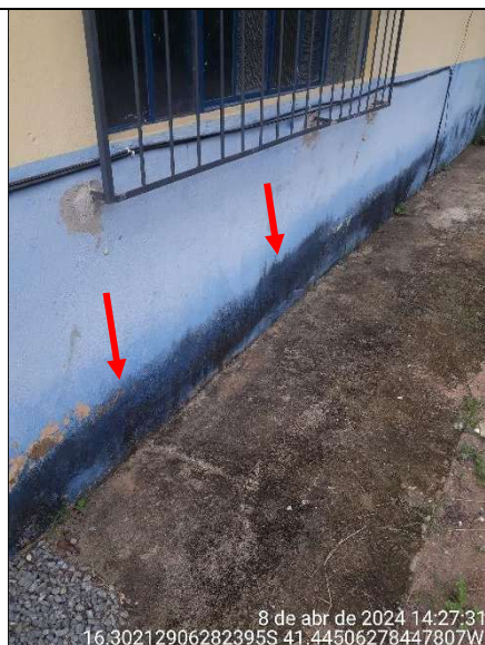
Figura 70 - Detalhe manchas de umidade na parede, lado externo
