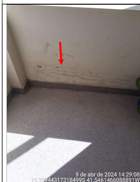
Figura 6 - Detalhe de mancha de umidade na parede, lado interno
