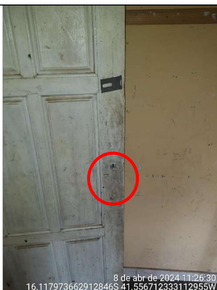
Figura 28 - Detalhe da ausência de maçaneta na porta
