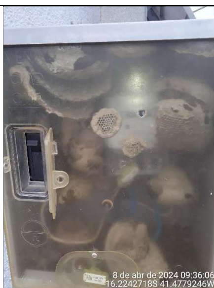
Figura 64 - Detalhe de colmeias de abelhas dentro do quadro de entrada de energia da escola
