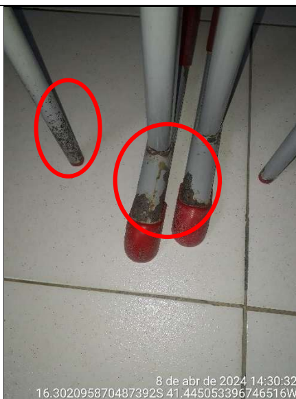
Figura 79 - Detalhe de ferrugem nos pés das mesas e cadeiras da sala de aula
