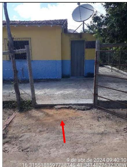
Figura 87 - Detalhe da ausência da rampa de acesso à escola
