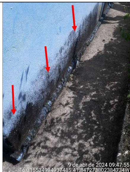
Figura 90 - Detalhe de manchas de umidade na parede, lado externo
