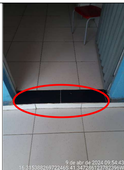
Figura 93 - Detalhes de desnível para acesso ao piso da cantina
