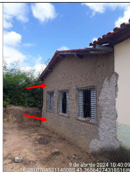
Figura 38 - Detalhe da ausência de revestimento e pintura na alvenaria do bloco "novo"
