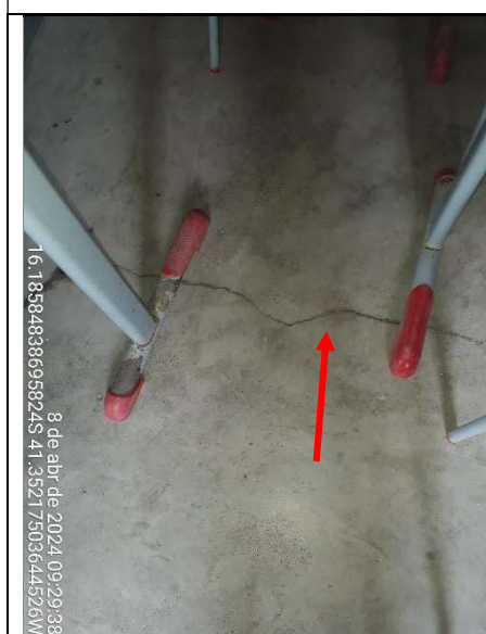
Figura 57 - Detalhe de trinca no piso da sala de aula
