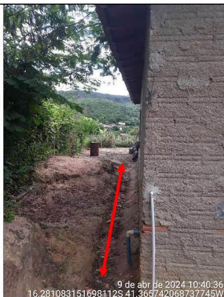
Figura 37 - Detalhe da ausência de calçada na lateral de bloco "novo"
