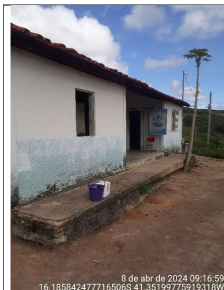
Figura 54 - Detalhe da ausência de rampa de acesso à escola
