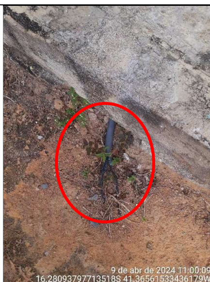
Figura 46 - Detalhe de cabo elétrico aparente
