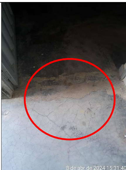
Figura 103 - Detalhes de remendos e fissuras no piso da entrada da sala de aula
