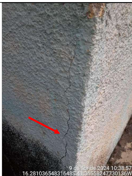
Figura 40 - Detalhe de trinca na parede, lado externo
