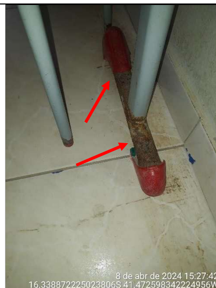
Figura 113 - Detalhe de ferrugem em pé de mesa da sala de aula
