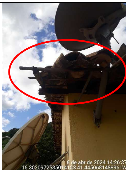
Figura 78 - Detalhe de problemas no beiral da cobertura
