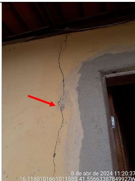
Figura 22 - Detalhe de trinca na parede, lado interno
