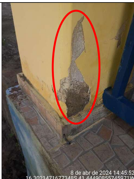
Figura 76 - Detalhe de problemas no revestimento e pintura da parede, lado externo
