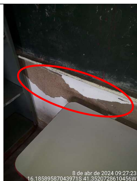
Figura 59 - Detalhe de parede da sala de aula com problema de revestimento e pintura
