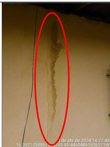
Figura 75 - Detalhe de mancha de umidade na parede, lado interno
