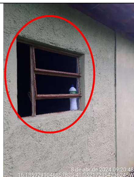
Figura 62 - Detalhe de janela sem vidros
