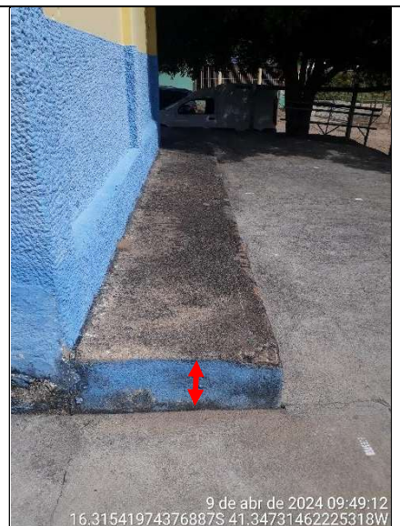
Figura 92 - Detalhe de desnível entre pisos das calçadas
