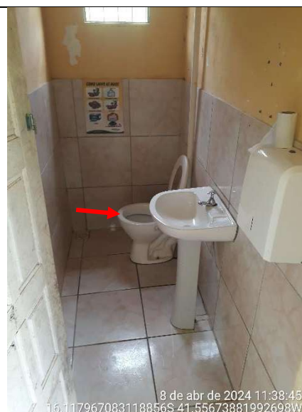
Figura 35 - Detalhe da ausência de assento na bacia sanitária do banheiro masculino
