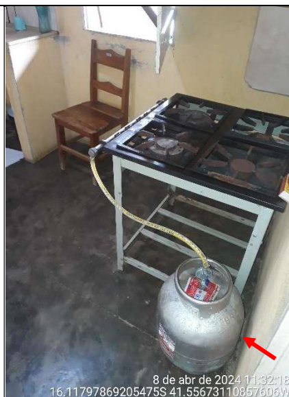
Figura 31 - Detalhe do botijão de GLP no fogão
