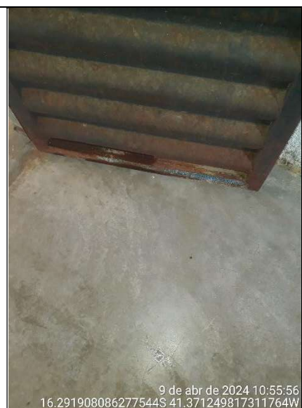
Figura 50 - Detalhe de porta tomada por ferrugem
