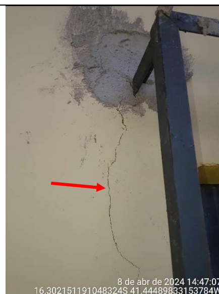
Figura 74 - Detalhe de trinca na parede, lado externo
