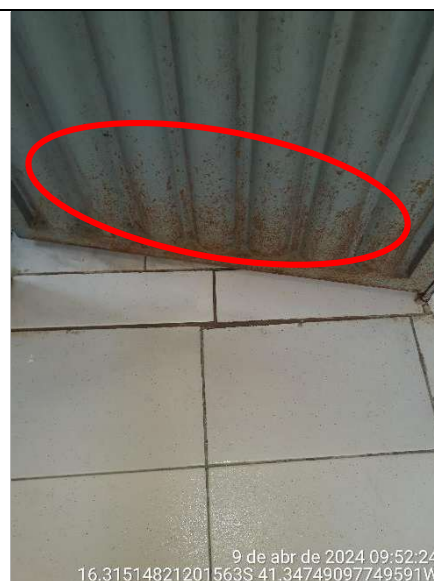
Figura 95 - Detalhe de ferrugem na porta do banheiro
