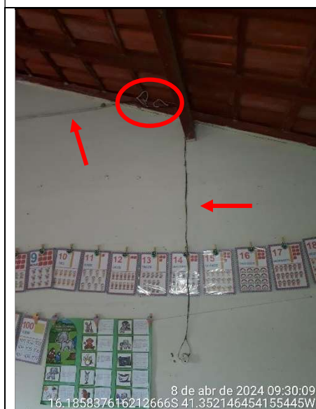
Figura 63 - Detalhe de cabos elétricos aparentes
