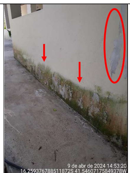
Figura 8 - Detalhe de manchas de umidade e desgaste da pintura
