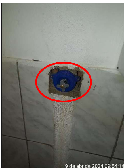
Figura 94 - Detalhes da falta de acabamento da válvula de descarga
