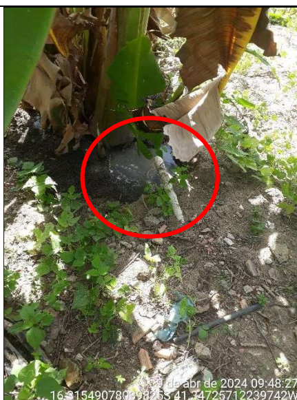
Figura 97 - Detalhe de lançamento in natura de esgoto da cozinha devido à ausência de caixa de gordura
