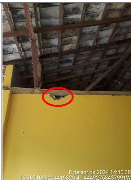
Figura 84 - Detalhe de dano na alvenaria
