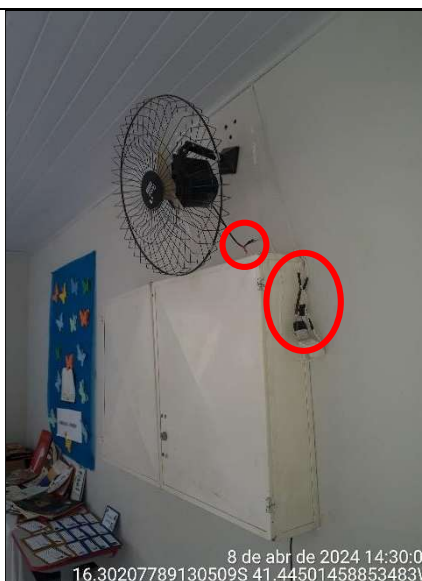
Figura 85 - Detalhe de cabo elétrico aparente e com remendo
