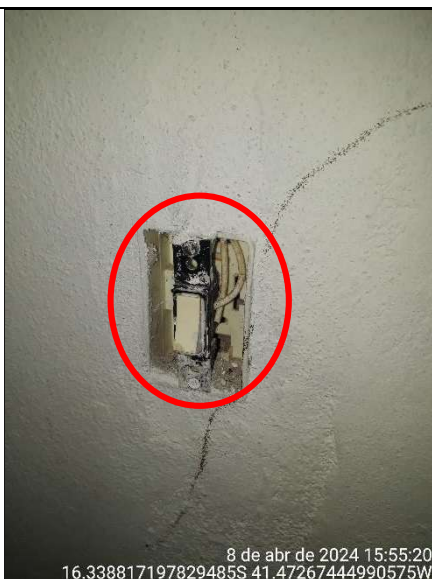
Figura 112 - Detalhe de cabo elétrico aparente
