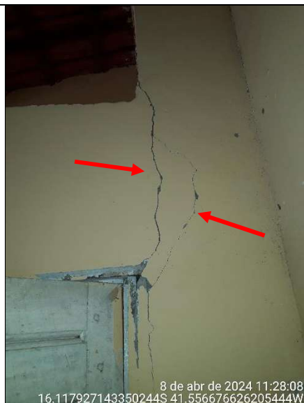
Figura 21 - Detalhe de trincas na parede, lado interno
