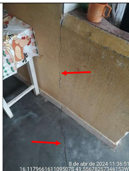
Figura 24 - Detalhe de trincas no piso e parede
