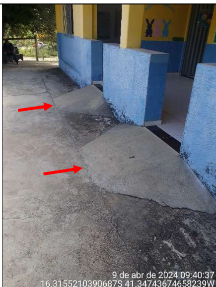
Figura 88 - Detalhe das rampas com inclinações elevadas
