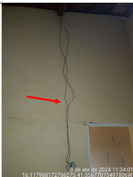
Figura 25 - Detalhe de cabo elétrico aparente
