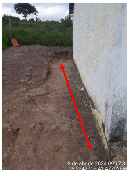
Figura 55 - Detalhe da ausência de calçada na lateral
