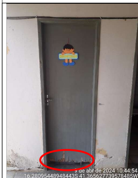
Figura 45 - Detalhe de problema de umidade na parte inferior da porta do banheiro
