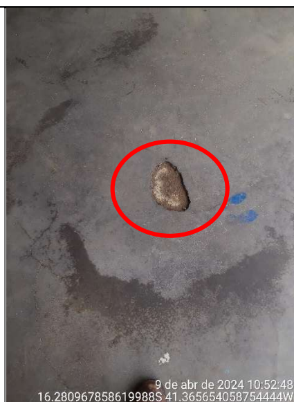
Figura 43 - Detalhe de buraco no piso
