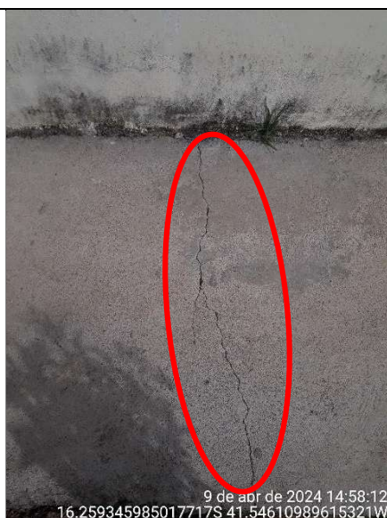
Figura 4 - Detalhe de trinca na calçada
