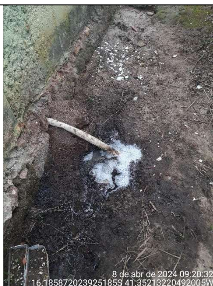
Figura 61 - Detalhe lançamento in natura de esgoto da cozinha devido à ausência de caixa de gordura
