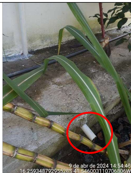
Figura 9 - Detalhes de lançamento in natura de efluente da cozinha, uma vez que não há caixa de gordura
