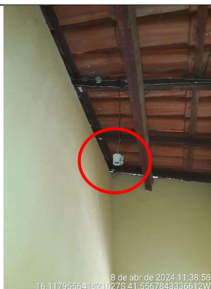
Figura 34 - Detalhe de ausência de lâmpada no banheiro masculino
