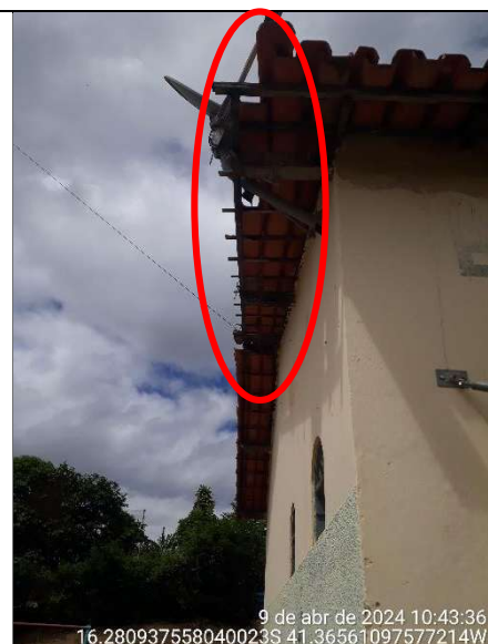
Figura 44 - Detalhe de ausência de telhas no beiral da cobertura
