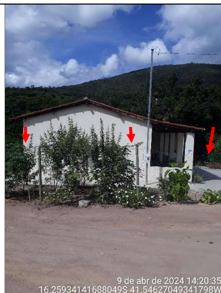
Figura 11 - Detalhe de ausência de muro de divisa do terreno. Há tela do tipo galinheiro no fechamento do terreno da escola
