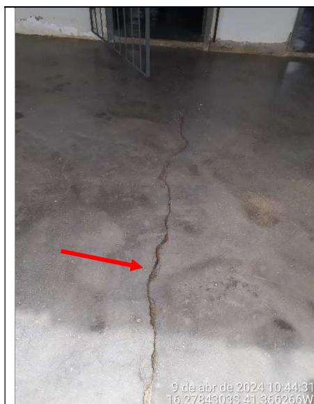
Figura 42 - Detalhe de trinca do piso
