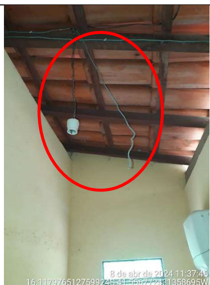
Figura 33 - Detalhe da ausência de lâmpada no banheiro feminino
