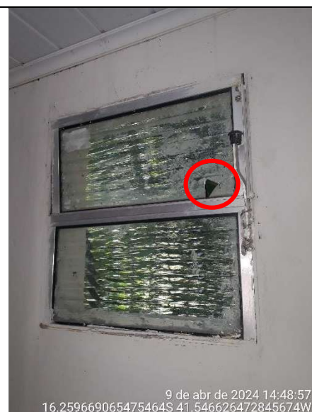
Figura 17 - Detalhe de janela com vidro quebrado
