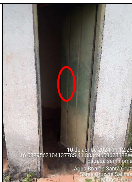
Figura 28 - Detalhe da ausência de fechadura e maçaneta na porta do banheiro
