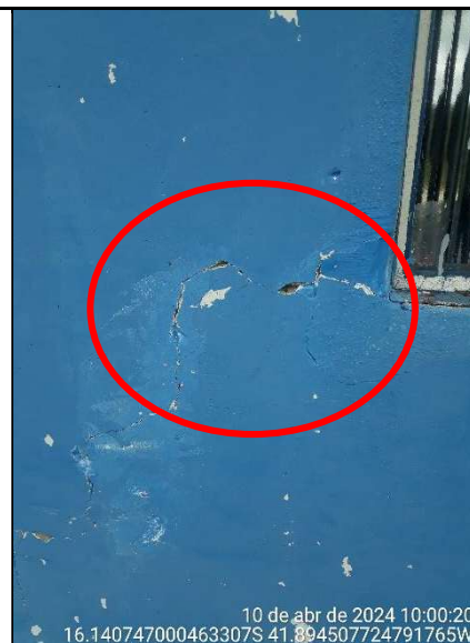
Figura 5 - Detalhe de trinca na parede, lado externo
