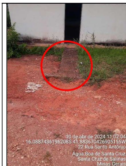
Figura 21 - Detalhe da rampa de acesso à escola, em desacordo com a Norma
