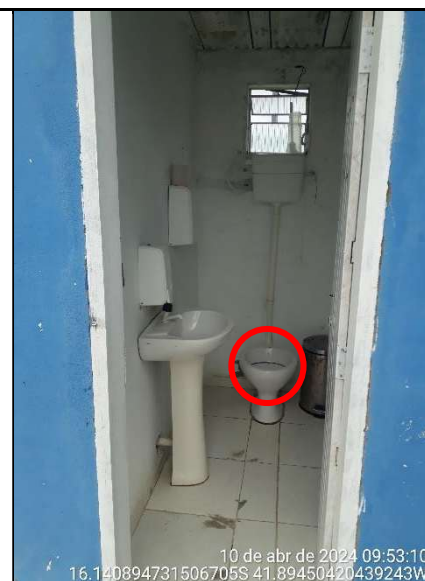
Figura 11 - Detalhe da ausência de assento na bacia sanitária
