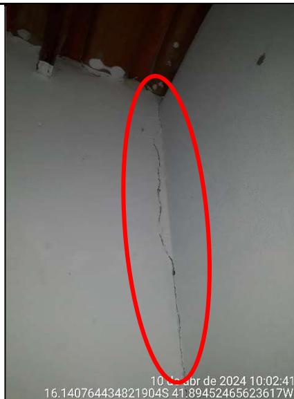
Figura 6 - Detalhe de trinca na parede, lado interno
