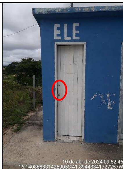
Figura 10 - Detalhes de ausência de maçaneta na porta do banheiro masculino
