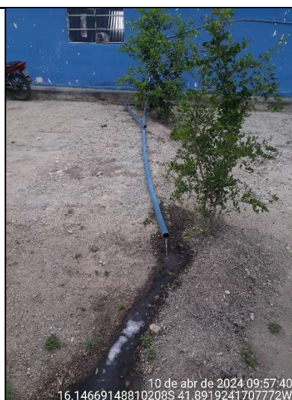
Figura 13 - Detalhe de lançamento diretamente sobre o solo, do efluente de esgoto da cozinha devido à ausência de caixa de gordura
