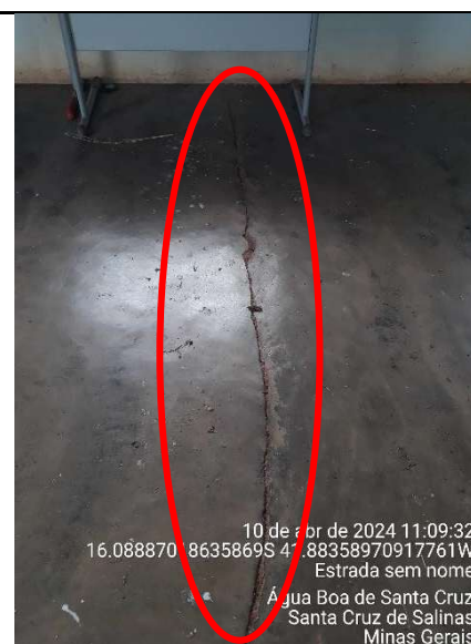
Figura 32 - Detalhe de rachadura no piso da sala de aula
