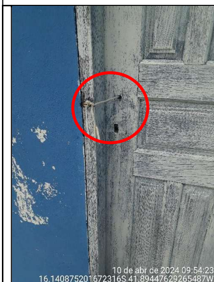
Figura 12 - Detalhe de barbante para fechamento da porta do banheiro feminino
