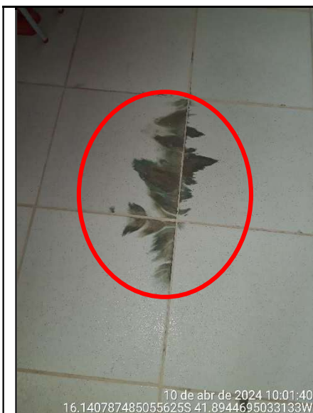
Figura 15 - Detalhe de manchas no piso da sala de aula
