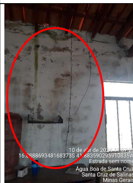
Figura 26 - Detalhe de manchas de umidade e desgaste na pintura da parede da sala de aula
