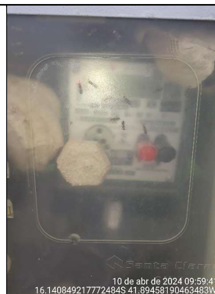
Figura 17 - Detalhe de colmeia de abelhas dentro de quadro de medidor de energia
