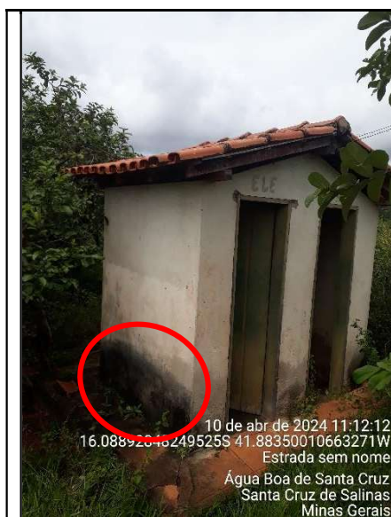
Figura 27 - Detalhe de mancha de umidade na parede do banheiro
