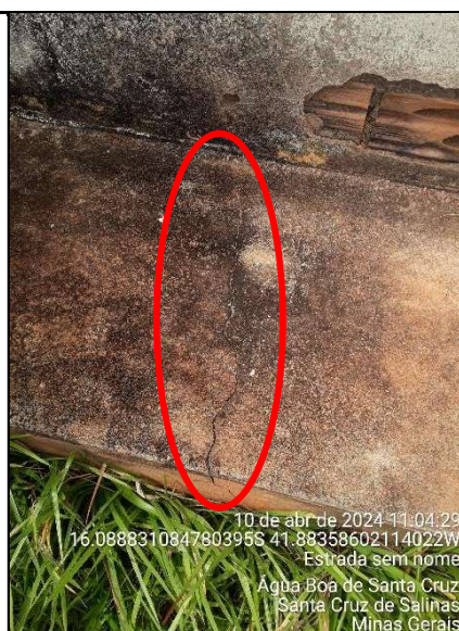
Figura 31 - Detalhe de trinca na calçada
