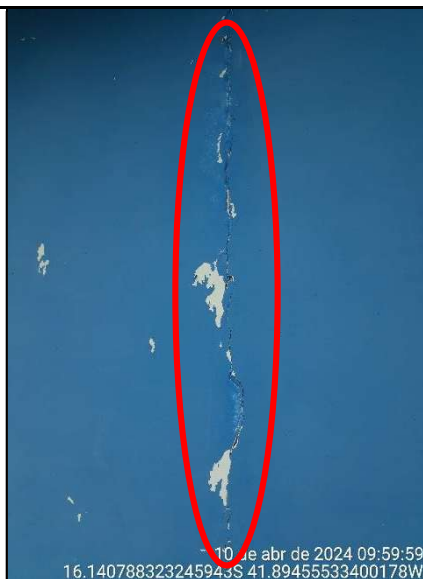
Figura 4 - Detalhe de trinca na parede, lado externo
