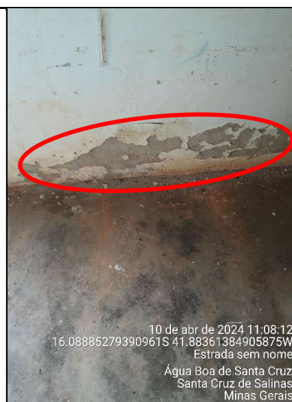
Figura 25 - Desgaste na pintura da sala de aula
