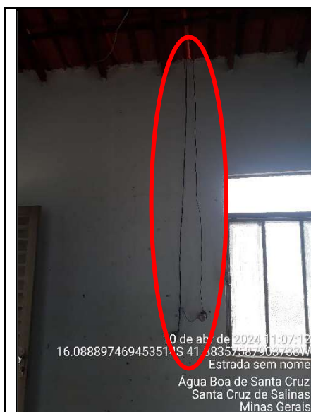
Figura 33 - Detalhe de cabo elétrico aparente
