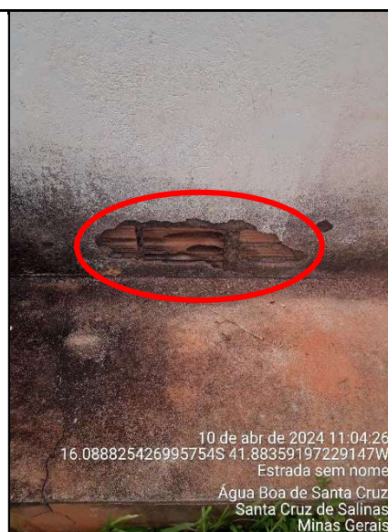
Figura 22 - Detalhe de patologia no revestimento da parede, lado externo
