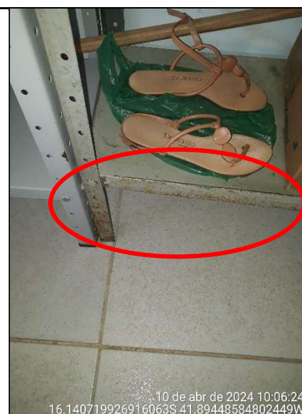
Figura 14 - Detalhe de armário de aço com ferrugem
