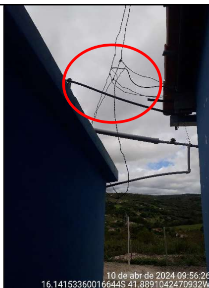
Figura 16 - Detalhe de cabos elétricos aparentes e com remendos
