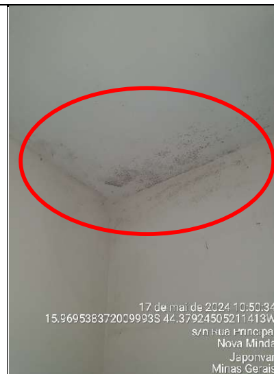
Figura 17 – Detalhe de manchas de umidade na parede e laje da sala de aula
