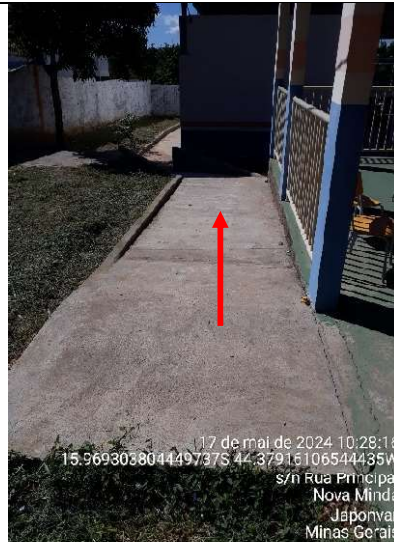
Figura 10 - Detalhe da ausência de corrimão na rampa de acesso à quadra poliesportiva
