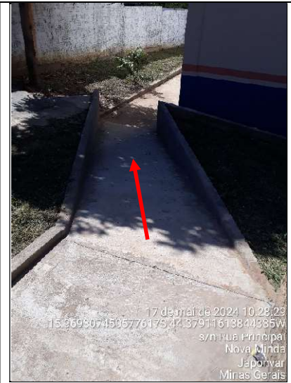
Figura 11 - Detalhe da ausência de corrimão na continuidade da rampa de acesso à quadra
