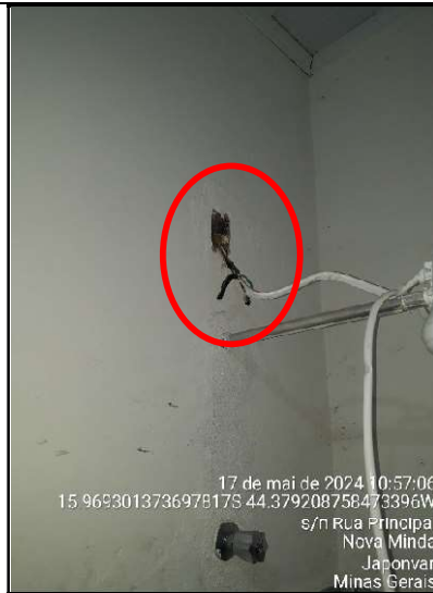
Figura 22 - Detalhe de cabo elétrico aparente e com remendo
