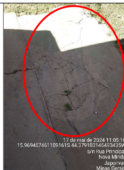
Figura 8 - Detalhe de trecho quebrado da calçada
