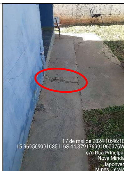
Figura 7 – Detalhe de trecho quebrado da calçada
