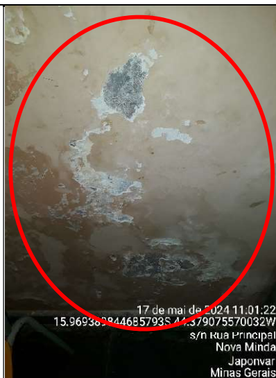
Figura 16 – Detalhe de infiltração na parede da sala de aula
