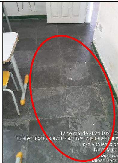
Figura 13 - Detalhe de desgaste no piso da sala de aula
