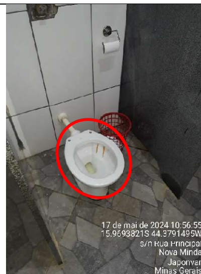
Figura 20 - Detalhe da ausência de assento na bacia sanitária
