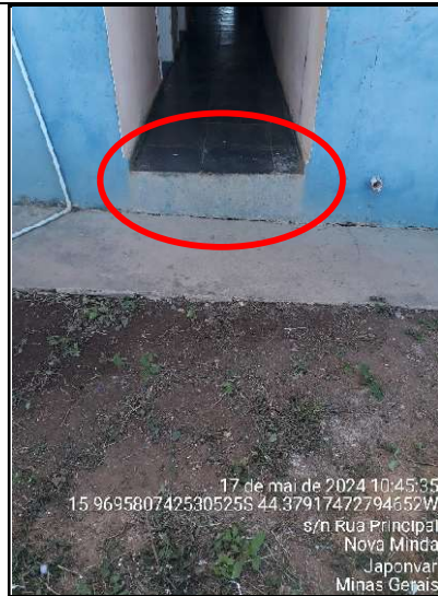
Figura 9 - Detalhe do desnível entre a calçada e o piso da escola
