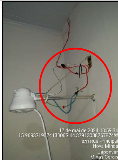
Figura 21 - Detalhe de cabos elétricos aparentes e com remendo
