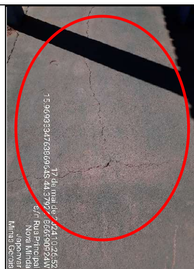
Figura 5 - Detalhe de rachaduras no piso da rampa, lado interno
