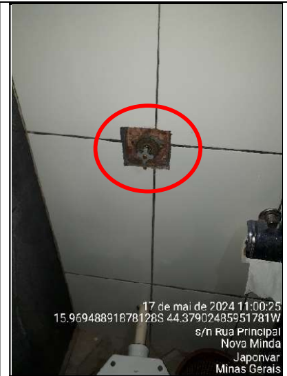
Figura 23 - Detalhe de válvula de descarga sem acabamento
