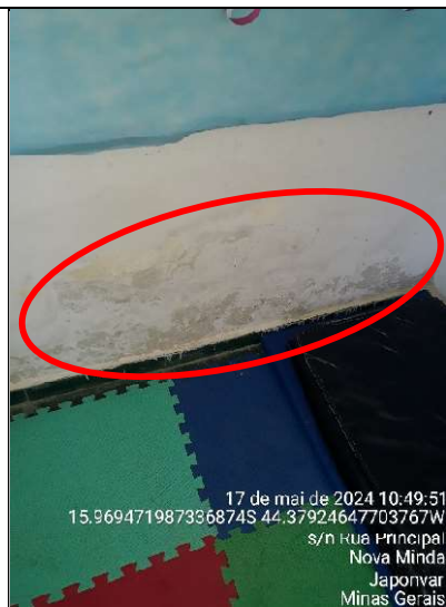
Figura 15 – Detalhe de manchas de umidade na parede da sala de aula
