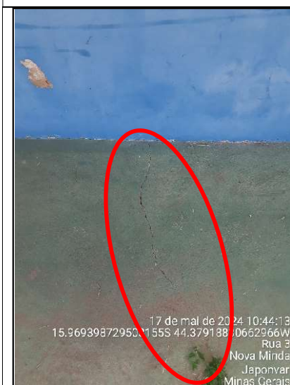
Figura 6 – Detalhe de rachadura na calçada perimetral
