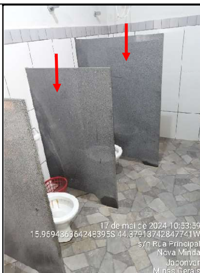
Figura 19 – Detalhe da ausência de portas nos boxes do banheiro
