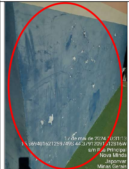
Figura 14 - Detalhe de desgaste na pintura da parede, lado externo
