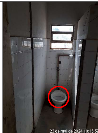
Figura 415 – Detalhe da ausência de assento na bacia sanitária
