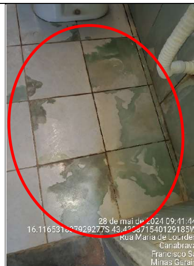
Figura 424 – Detalhe de manchas no piso do banheiro
