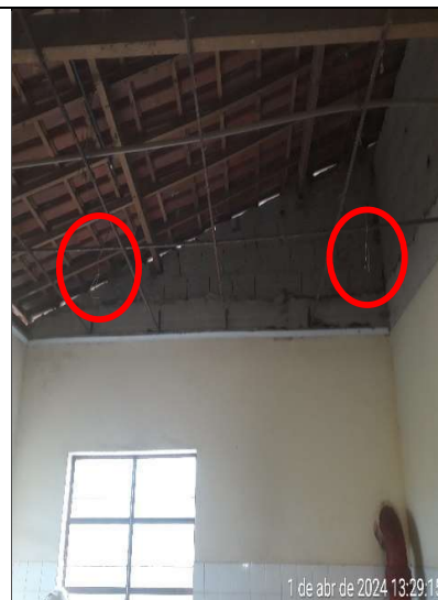
Figura 61 - Detalhes de cabos elétricos pendurados em função da queda parcial do forro de PVC
