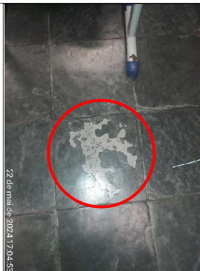
Figura 311 – Detalhe de desgaste do piso da sala de aula...
