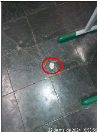
Figura 309 – Detalhe de buraco no piso da sala de aula
