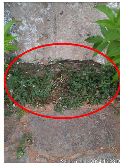
Figura 313 – Detalhe de problemas no revestimento do muro, lado interno
