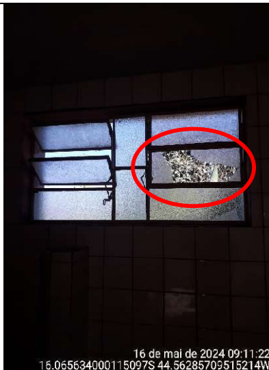
Figura 198 – Detalhe da janela do banheiro masculino com vidro quebrado
