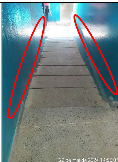
Figura 330 – Detalhe de rampa sem corrimão
