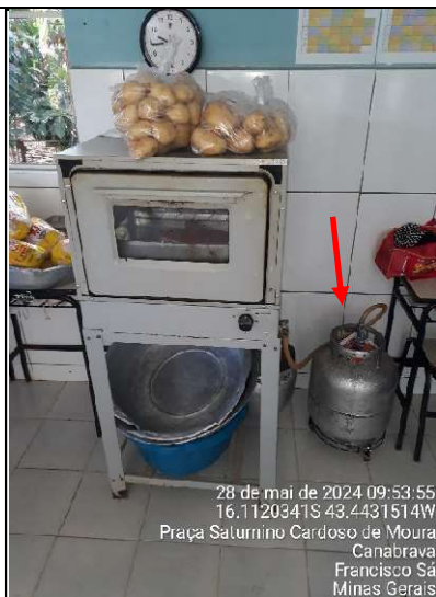
Figura 444 - Detalhe de botijão de GLP no forno
