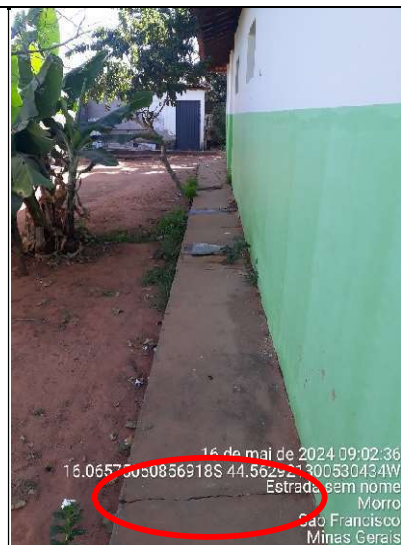
Figura 179 - Detalhe de rachadura na calçada
