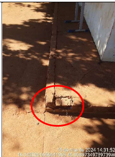
Figura 204 - Detalhe de trecho quebrado da calçada, lado interno
