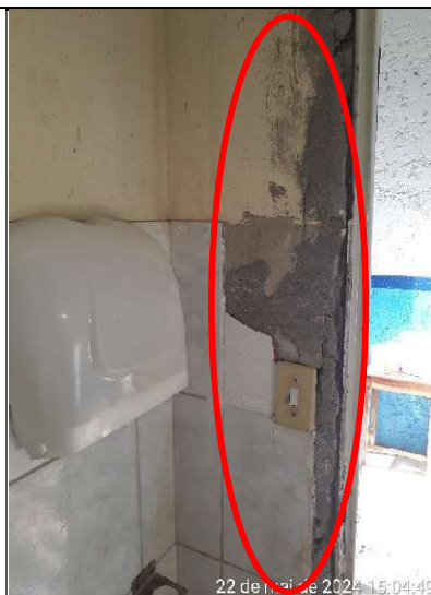
Figura 333 – Detalhes de problemas nos revestimentos da parede do banheiro
