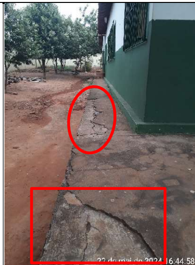
Figura 308 – Detalhes de trechos quebrados da calçada
