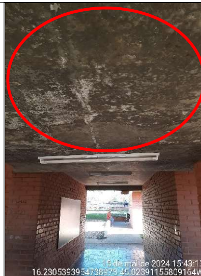
Figura 246 – Detalhe de manchas de infiltração na laje da corredor
