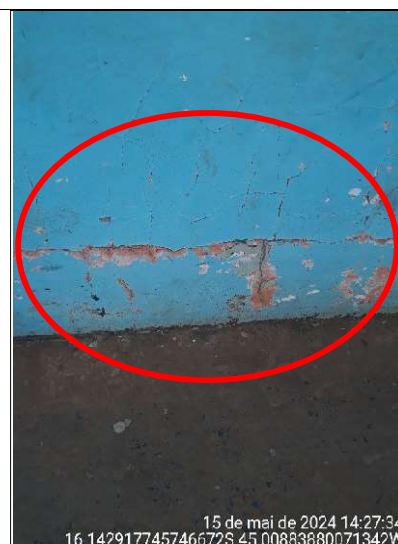
Figura 208 - Detalhe do desgaste na pintura da parede, lado externo
