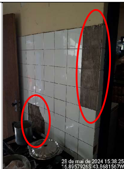
Figura 146 - Detalhe de trechos sem azulejos na cozinha
