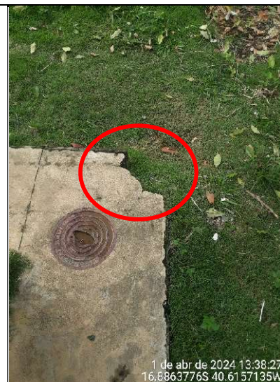
Figura 43 - Detalhe de trecho quebrado da calçada
