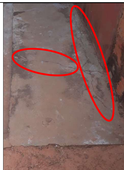
Figura 262 – Detalhes de rachaduras na calçada
