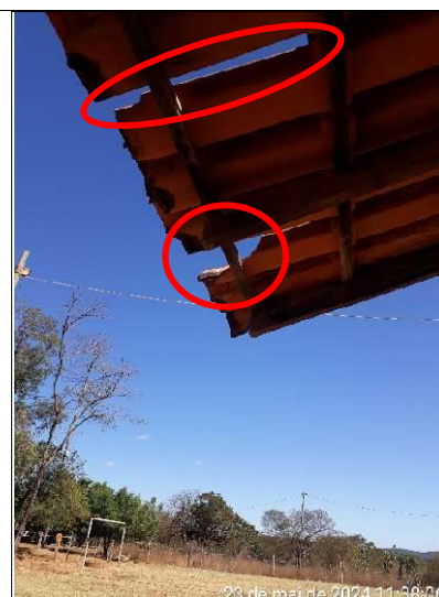
Figura 370 – Detalhes de problemas no beiral da cobertura
