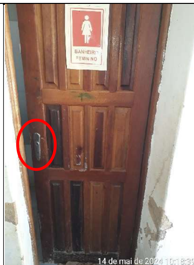
Figura 123 – Detalhe de ausência de maçaneta na porta do banheiro feminino
