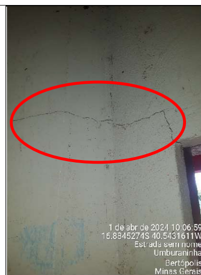
Figura 22 - Detalhe de rachadura na parede do banheiro, lado interno
