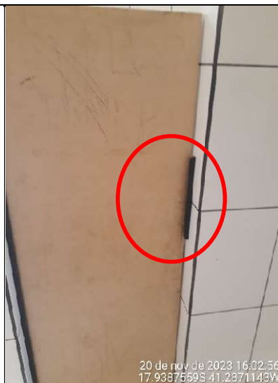
Figura 9 - Detalhe da ausência de trinco na porta do box do banheiro
