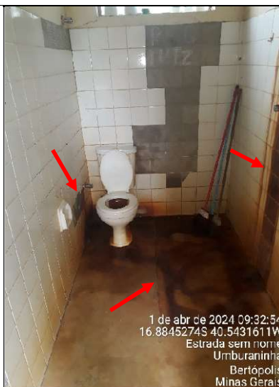
Figura 39 - Detalhe da falta de condições de higiene no banheiro
