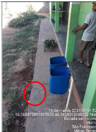
Figura 177 - Detalhe de rachadura na calçada
