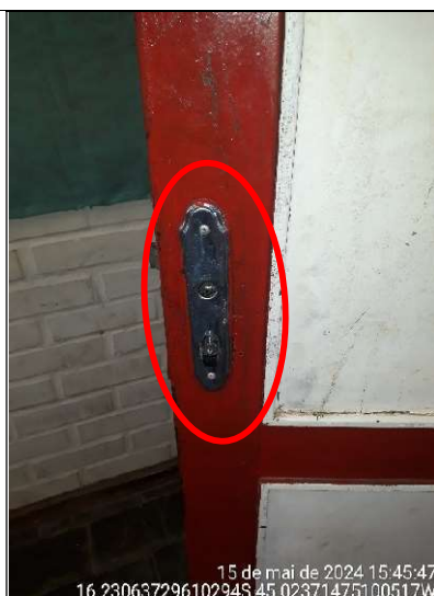
Figura 252 - Detalhe da ausência de maçaneta na porta da sala de aula
