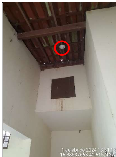
Figura 59 - Detalhe de ponto de luz sem lâmpada
