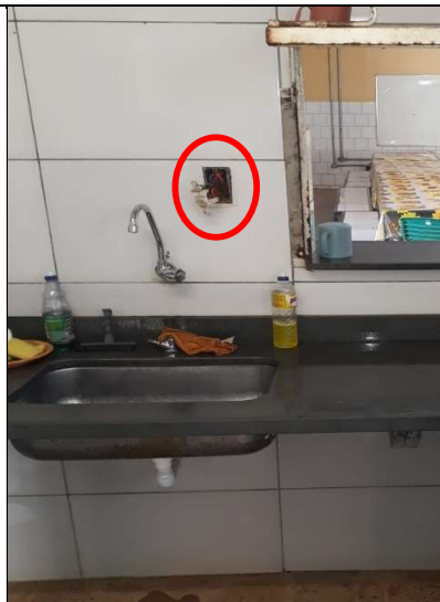
Figura 221 – Detalhe de cabos elétricos aparentes
