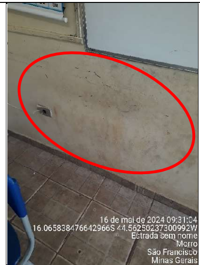
Figura 187 - Detalhe do desgaste da pintura da parede da sala de aula
