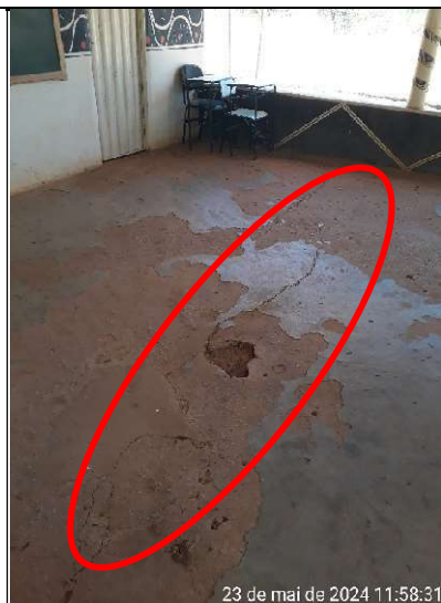
Figura 353 – Detalhes de buracos e rachaduras no piso da sala de aula externa
