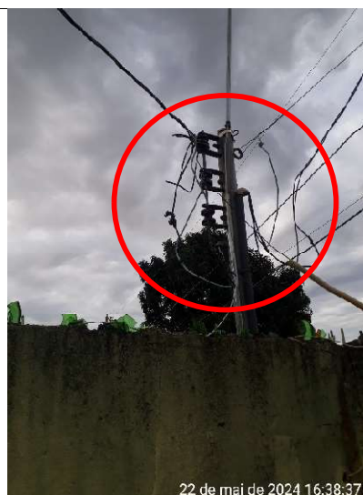
Figura 317 – Detalhes de remendos de cabos elétricos no poste de entrada de energia
