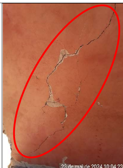
Figura 386 – Detalhe de rachadura na parede, lado externo
