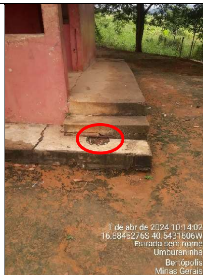
Figura 17 – Detalhes dos degraus da calçada e escada para acesso à escola, com destaque para o buraco na calçada
