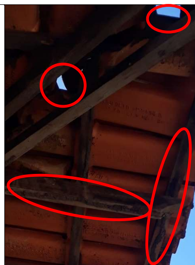
Figura 121 - Detalhes de problemas no beiral da cobertura, com detalhes dos cupins no madeiramento
