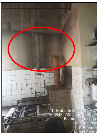
Figura 27 - Detalhe da precariedade da pintura da parede da cozinha
