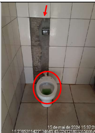
Figura 240 - Detalhes do descolamento de azulejos e ausência de assento na bacia sanitária no banheiro masculino
