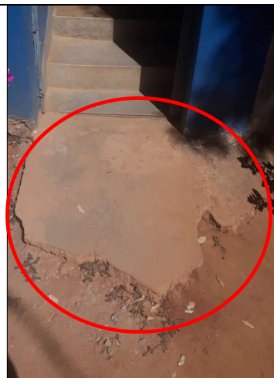
Figura 289 – Detalhe de trecho quebrado da calçada
