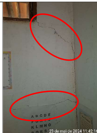
Figura 358 – Detalhes de rachaduras na parede da sala de aula
