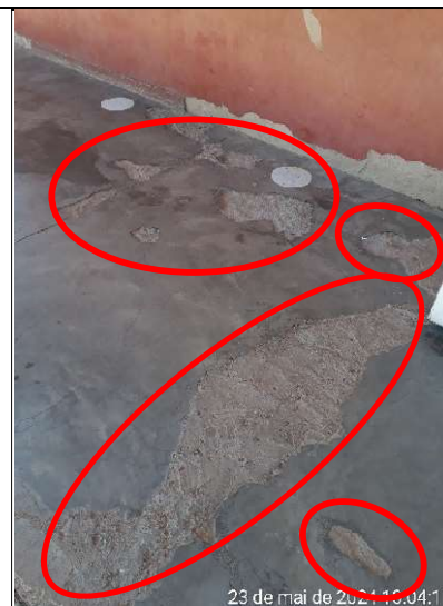
Figura 379 – Detalhes de buracos e remendos no piso da varanda
