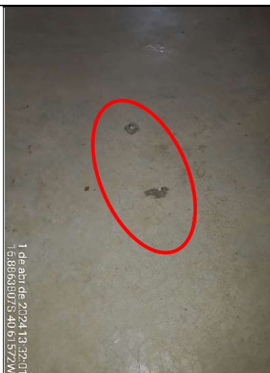
Figura 45 - Detalhe de furos no piso da sala de aula
