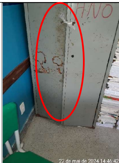
Figura 341 – Detalhe de ferrugem no armário da sala de aula
