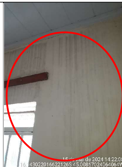
Figura 211 - Detalhe de manchas de infiltração na parede, lado interno
