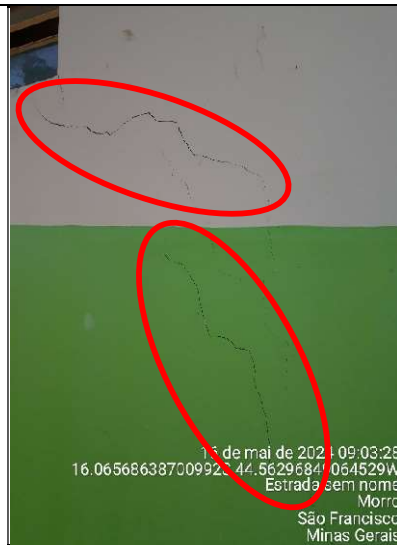
Figura 186 - Detalhes de rachaduras na parede, lado externo
