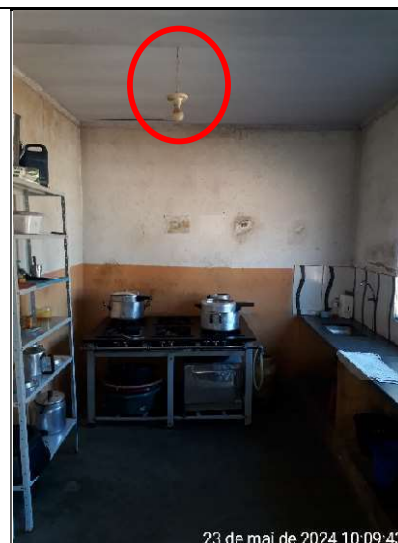
Figura 412 - Detalhe da lâmpada queimada na cozinha
