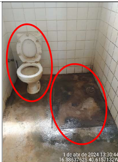
Figura 57 - Detalhes da falta de condições de higiene da bacia sanitária e piso do banheiro
