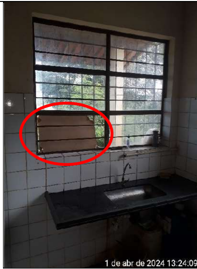
Figura 53 - Detalhe da janela da cozinha com vão sem vidro
