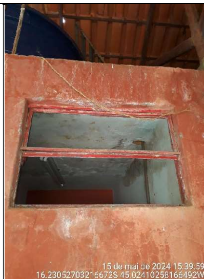
Figura 248 – Detalhe da janela do banheiro sem vidros
