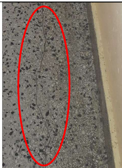
Figura 69 - Detalhe de trinca no piso da sala de aula
