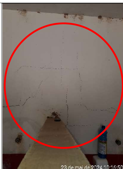
Figura 393 – Detalhes de trincas e rachaduras na parede do banheiro
