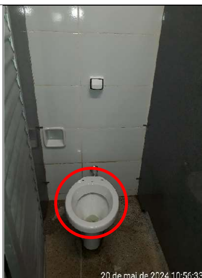
Figura 297 – Detalhe da ausência de assento na bacia sanitária
