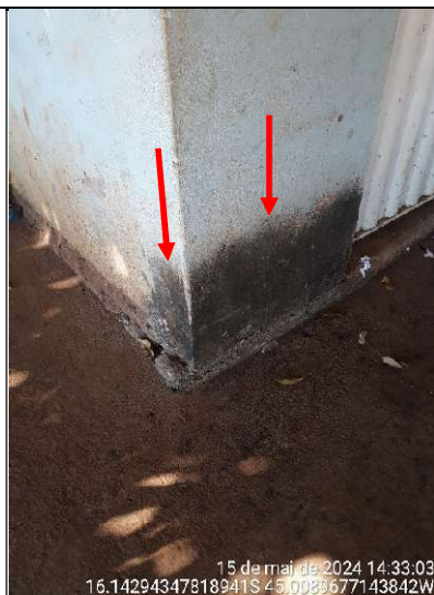
Figura 210 - Detalhe de manchas de infiltração na parede, lado externo...
