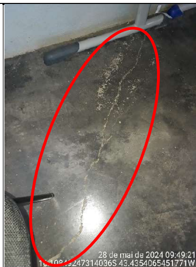
Figura 425 – Detalhes de rachaduras e manchas no piso da sala de aula
