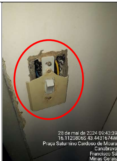
Figura 438 – Detalhe de cabo elétrico aparente devido ao espelho da tomada quebrado
