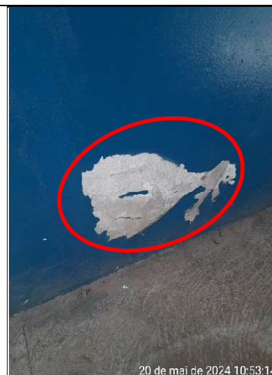
Figura 292 – Detalhe de desgaste da pintura da parede, lado externo
