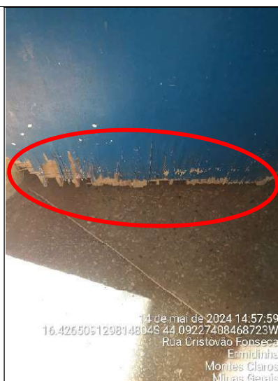
Figura 90 - Detalhe de desgaste devido à umidade na parte inferior da porta do banheiro masculino
