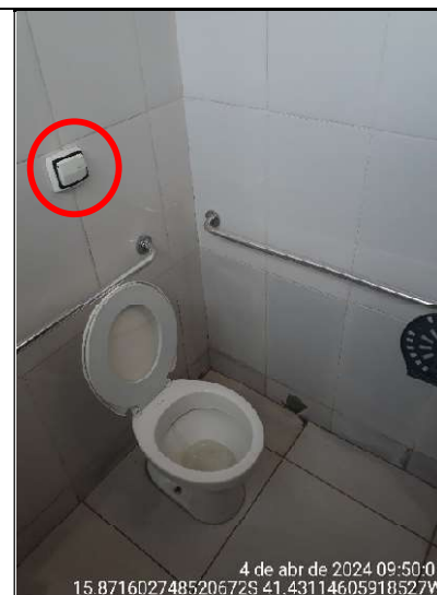
Figura 76 - Detalhe da ausência de metal para acionamento da válvula de descarga para PcD
