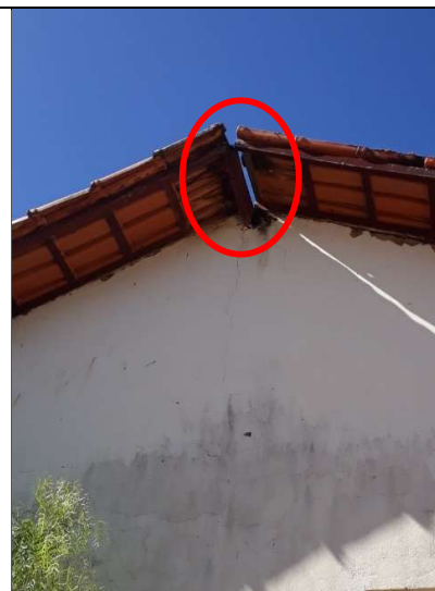
Figura 406 – Detalhe da ausência de cumeeira na cobertura
