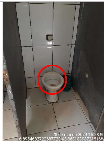
Figura 166 – Detalhe da ausência de assento na bacia sanitária...
