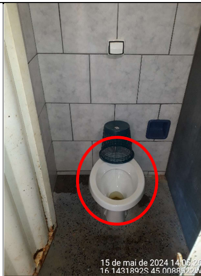
Figura 222 - Detalhe da ausência de assento na bacia sanitária
