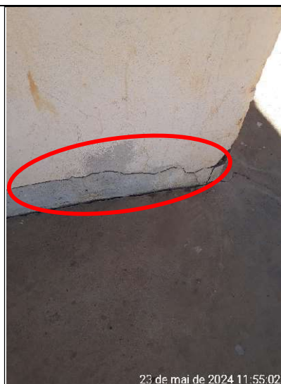
Figura 356 – Detalhe de rachadura na parede, lado externo
