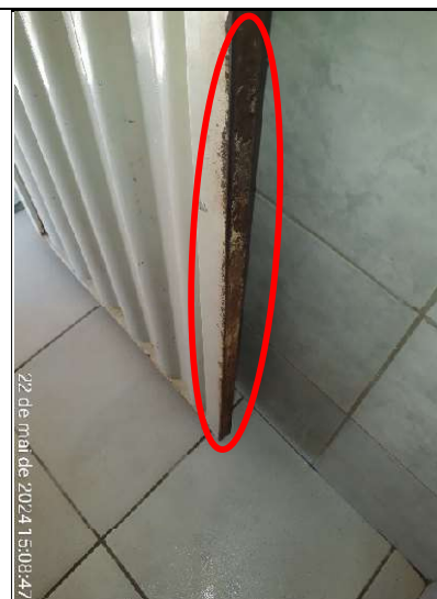
Figura 337 – Detalhe de ferrugem na porta do banheiro
