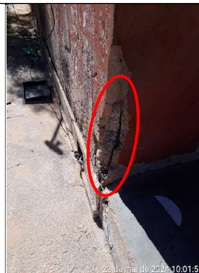
Figura 385 – Detalhe de pilar sem recobrimento
