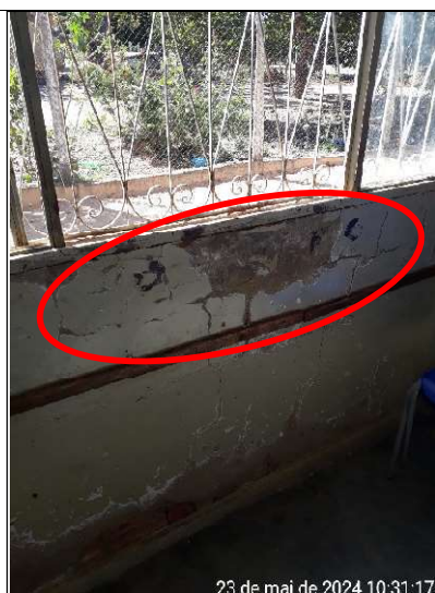
Figura 398 – Detalhe de trincas na parede da sala de aula
