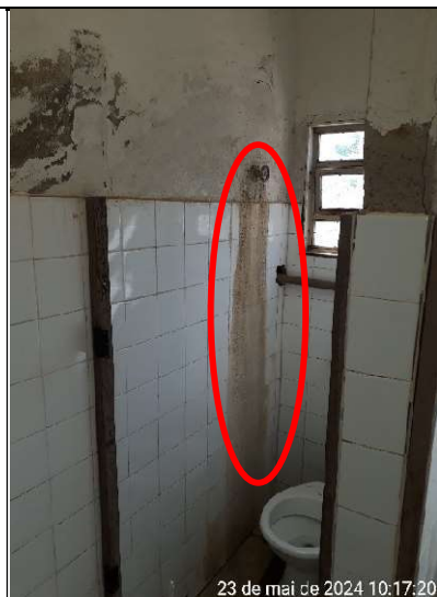
Figura 413 – Detalhe de vazamento no registro
