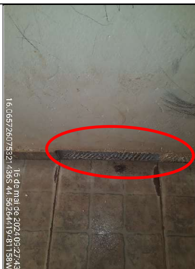
Figura 183 - Detalhe do descolamento do rodapé da sala de aula
