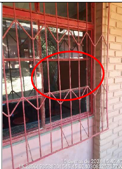
Figura 249 – Detalhe da janela da sala de aula sem vidro
