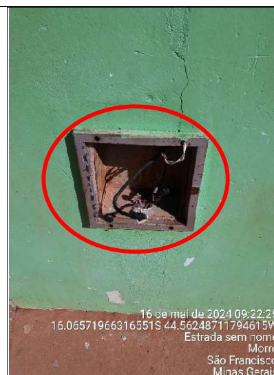
Figura 196 - Detalhe de cabos elétricos aparentes e com remendos
