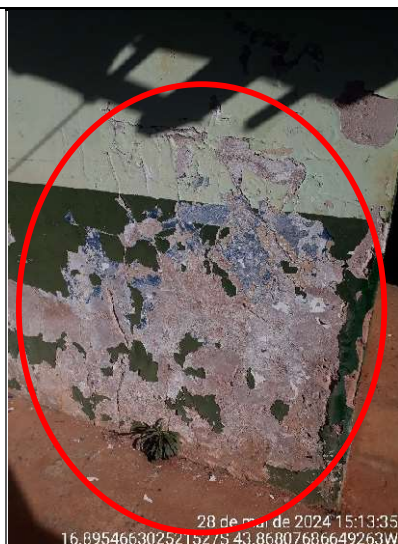
Figura 150 - Detalhes de problemas na pintura e revestimento da parede, lado externo
