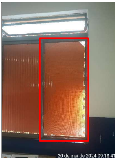
Figura 276 – Detalhe da janela da sala de aula com vidro quebrado
