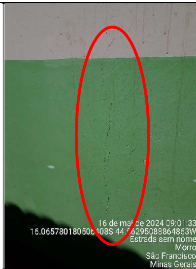
Figura 185 - Detalhe de trinca na parede, lado externo
