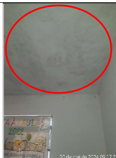
Figura 280 – Detalhe de manchas de infiltração na laje da sala de aula
