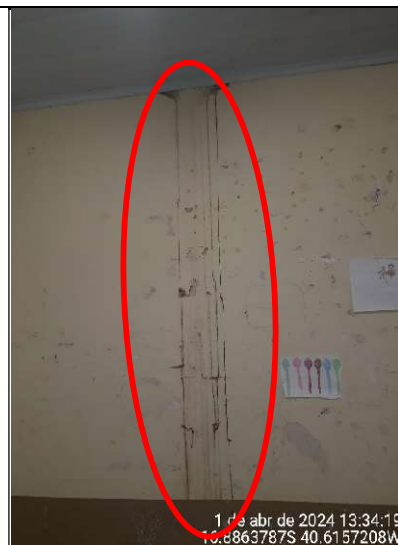
Figura 49 - Detalhe de manchas de infiltração na parede da sala de aula
