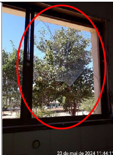
Figura 366 – Detalhe da janela do banheiro com vidro quebrado
