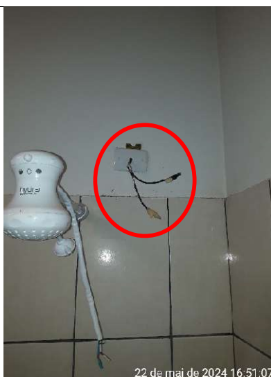
Figura 318 – Detalhe de cabos elétricos com remendos
