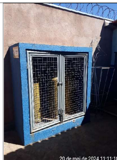
Figura 298 – Detalhe da casa de gás GLP
