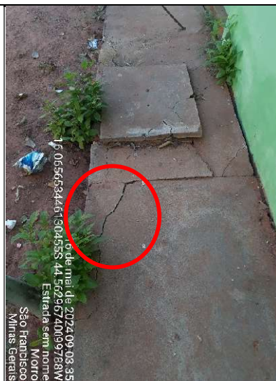
Figura 180 - Detalhe de rachadura na calçada...
