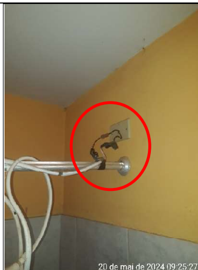
Figura 272 – Detalhe de cabo elétrico aparente e com remendo
