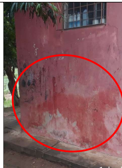
Figura 25 - Detalhe da precariedade da pintura da parede, lado externo
