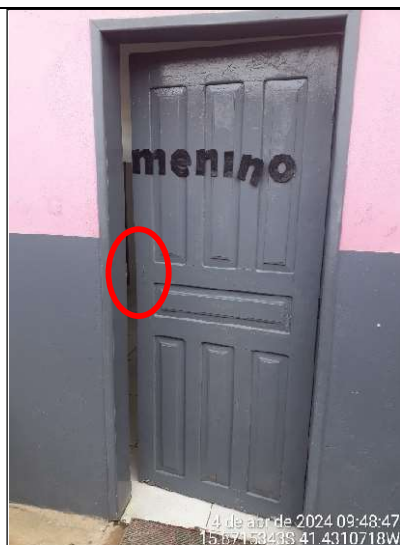
Figura 74 - Detalhe da ausência de maçaneta na porta do banheiro masculino
