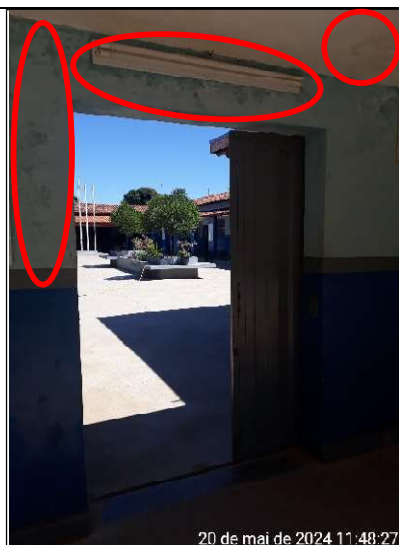
Figura 290 – Detalhe da precariedade da pintura na parede e laje da entrada da escola
