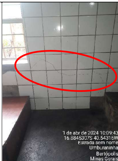
Figura 24 - Detalhe de trinca na parede da cozinha
