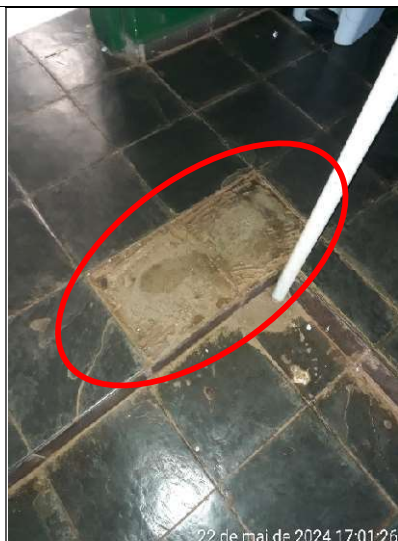
Figura 312 – Detalhe de descolamento de pisos no pátio
