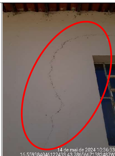
Figura 119 - Detalhe da rachadura na parede, lado externo
