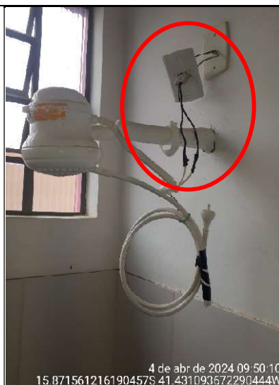
Figura 75 - Detalhe de cabo elétrico aparente e com remendo
