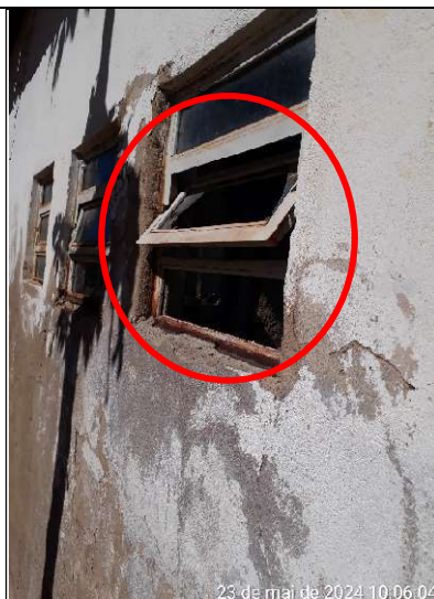
Figura 405 – Detalhes da janela do banheiro: um vão sem vidro e outro com vidro quebrado
