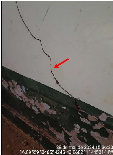
Figura 152 – Detalhe de rachadura na parede, lado externo
