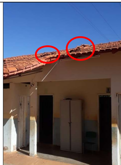
Figura 217 - Detalhe de telhas soltas na cobertura
