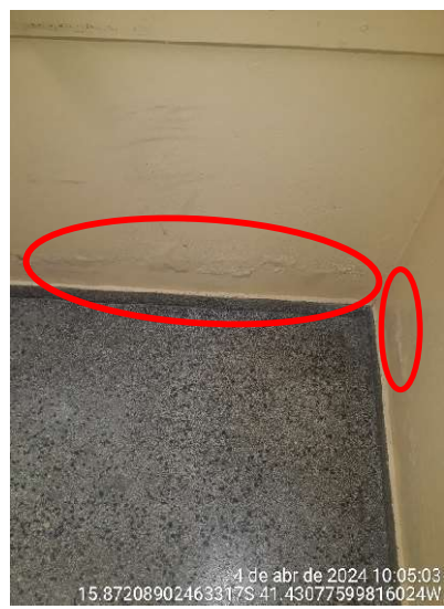
Figura 71 - Detalhe de umidade na parede da sala de aula
