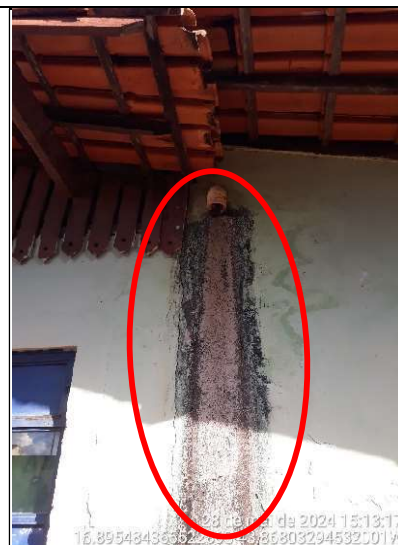
Figura 148 - Detalhe de mancha de umidade na parede, lado externo
