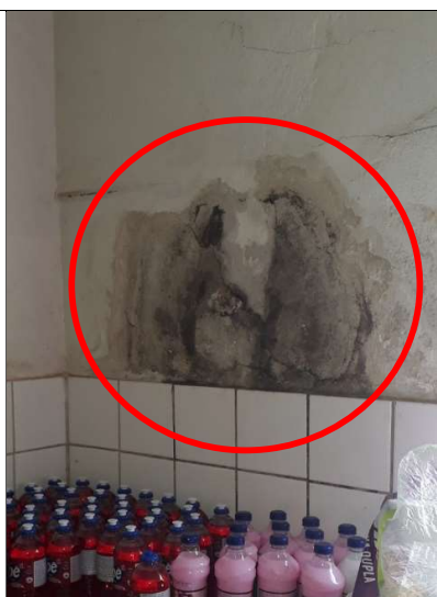
Figura 399 – Detalhe de mancha de infiltração na parede da cozinha
