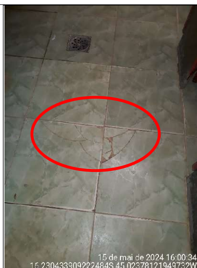
Figura 233 - Detalhe dos pisos quebrados no banheiro feminino
