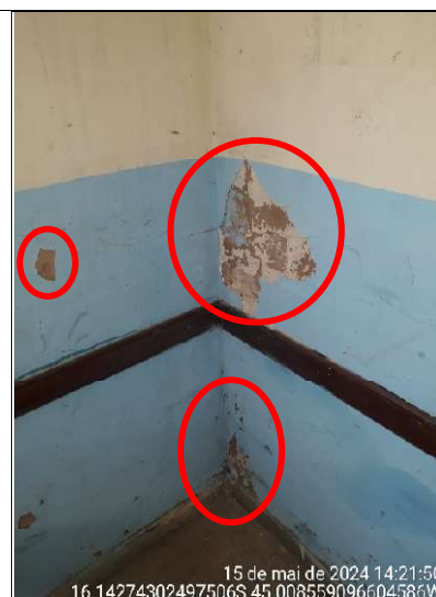
Figura 214 - Detalhe do desgaste da pintura da parede da sala de aula
