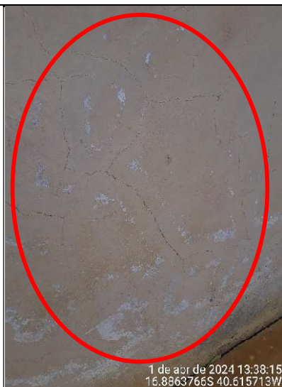
Figura 48 - Detalhe de trincas na parede, lado externo
