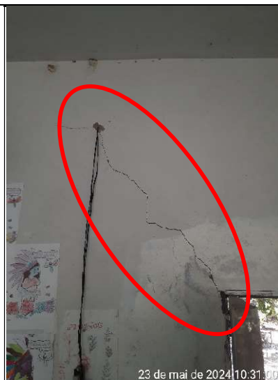
Figura 395 – Detalhe de rachadura na parede da sala de aula
