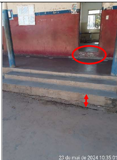
Figura 378 – Detalhes da escada de acesso à escola, com altura do espelho em desacordo com a Norma. Ao fundo o desnível para acesso à sala de aula
