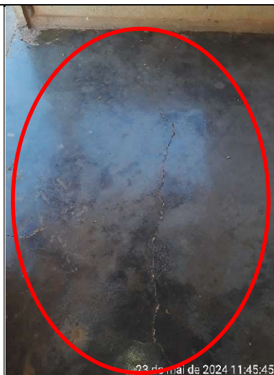
Figura 354 – Detalhes de rachaduras e manchas no piso do pátio
