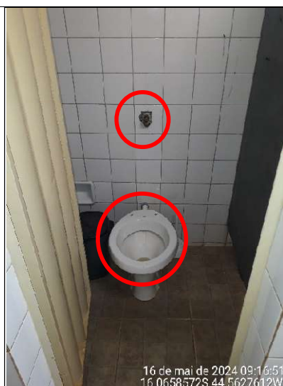
Figura 194 - Detalhes das ausências de assento na bacia sanitária e do acabamento da válvula de descarga
