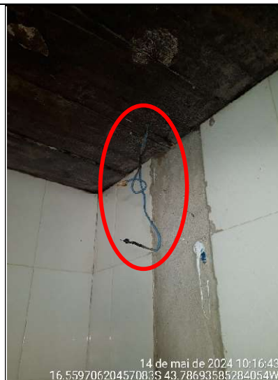
Figura 126 - Detalhe de cabo elétrico aparente e com remendo...
