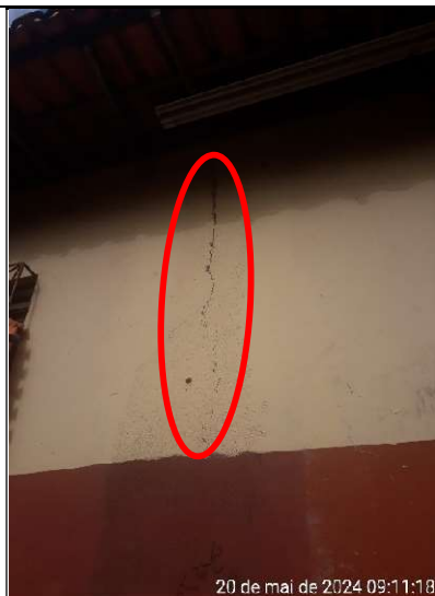
Figura 267 – Detalhe de rachadura na parede, lado externo
