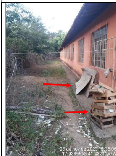
Figura 5 – Detalhe de trecho obstruído da calçada
