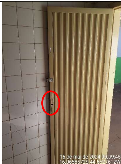
Figura 197 – Detalhe de ausência de maçaneta na porta do banheiro masculino
