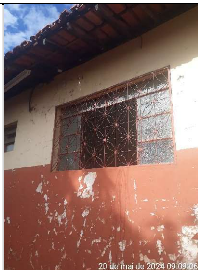
Figura 269 – Detalhe de desgaste da pintura da parede, lado externo
