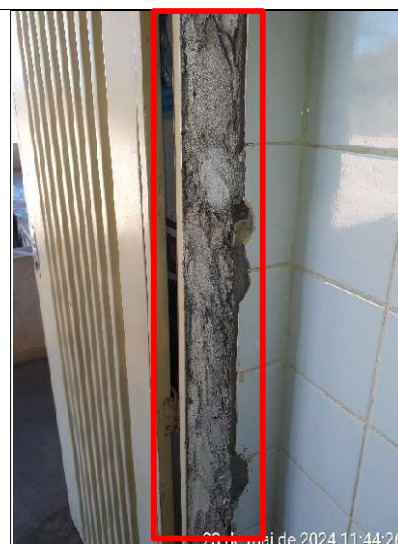
Figura 364 – Detalhe da falta de acabamento da argamassa da parede do banheiro
