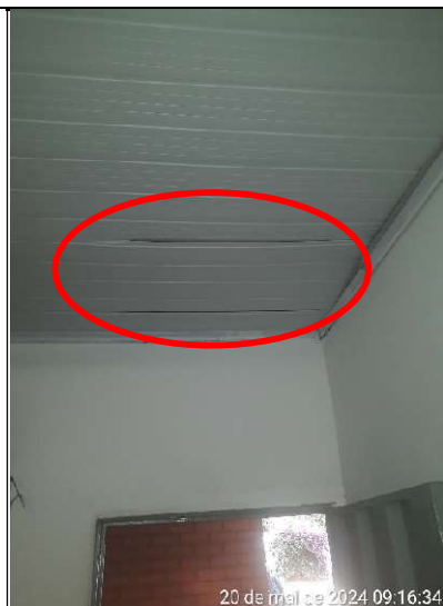
Figura 281 – Detalhe do deslocamento do forro de PVC da sala de aula devido a infiltração
