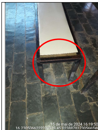
Figura 254 – Detalhe do mau estado de conservação do banco do refeitório
