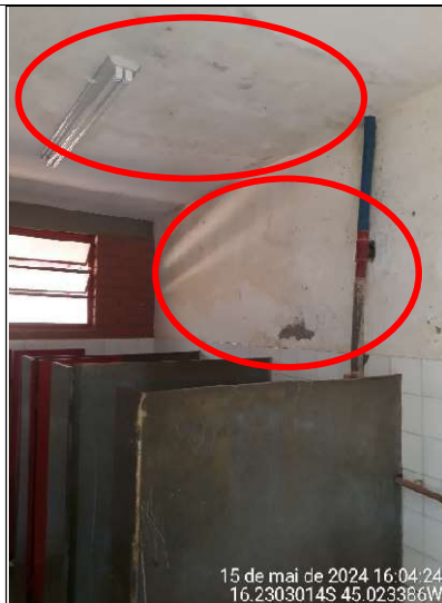
Figura 245 – Detalhes das manchas de infiltração na laje e parede do banheiro masculino
