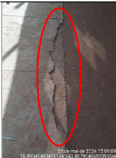
Figura 138 - Detalhe de trecho quebrado da borda da calçada perimetral
