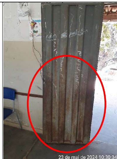
Figura 404 – Detalhes da porta da sala de aula: com ferrugem e sem fechadura e maçaneta
