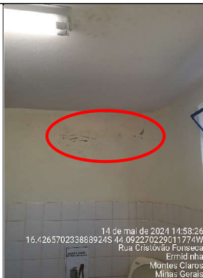
Figura 87 - Detalhe de manchas de umidade na parede do banheiro
