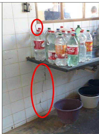
Figura 362 – Detalhe de rachadura na parede da cozinha
