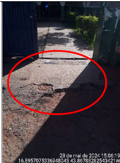
Figura 135 - Detalhe de irregularidade no concreto da rampa de acesso à escola
