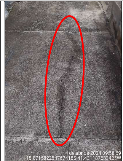
Figura 67 - Detalhe de rachadura na calçada, lado interno
