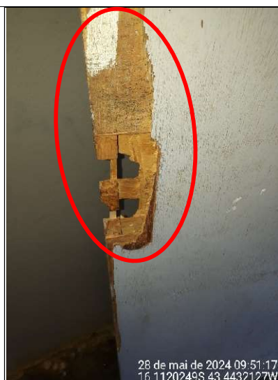
Figura 434 – Detalhe da precariedade da porta da sala de aula
