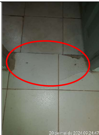
Figura 264 – Detalhe de piso quebrado na entrada do banheiro feminino
