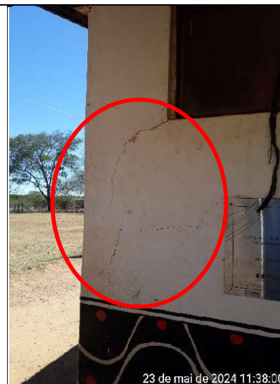
Figura 355 – Detalhes de rachaduras na parede frontal
