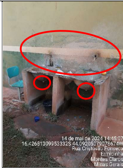
Figura 98 - Detalhes da precariedade da pintura da parede e das instalações sanitárias do tanque, sem sifões
