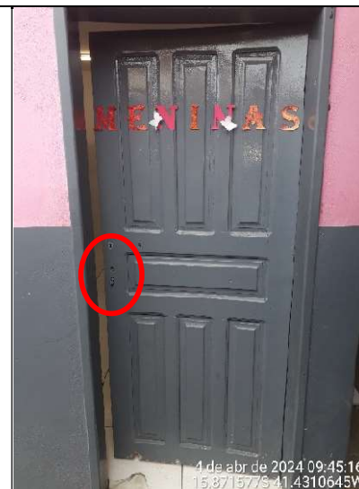
Figura 73 - Detalhe da ausência de maçaneta na porta do banheiro feminino
