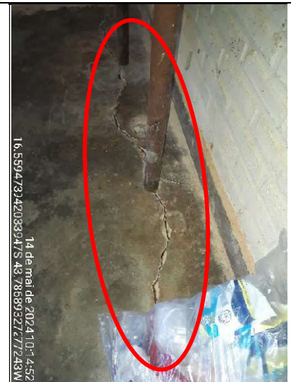
Figura 109 - Detalhe de rachadura no piso da despensa de alimentos
