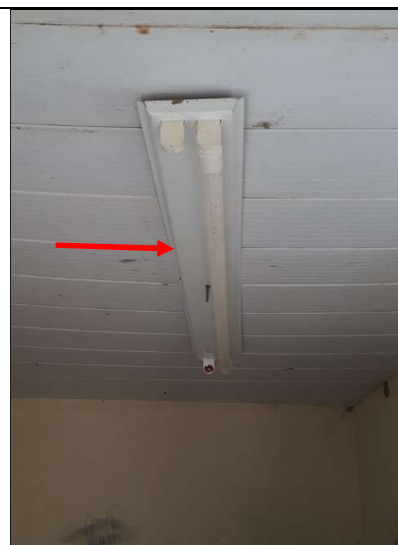
Figura 343 – Detalhe de ausência de lâmpada na luminária do banheiro
