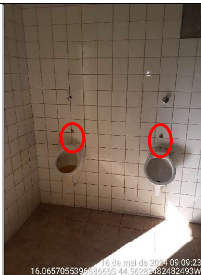
Figura 192 - Detalhe dos mictórios sem uso, devido a falta dos engates
