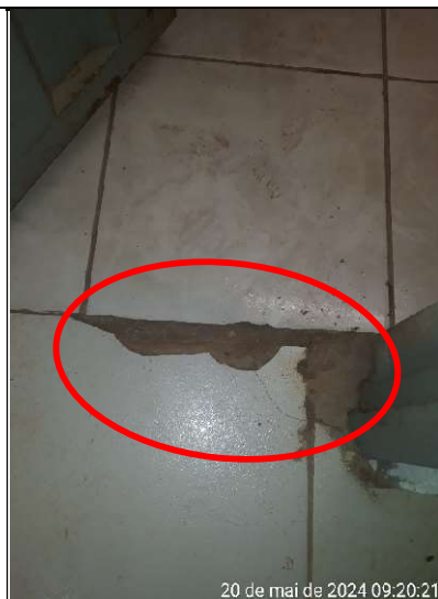
Figura 263 – Detalhes de pisos quebrados na entrada do banheiro masculino
