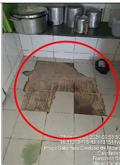
Figura 429 – Detalhes de pisos quebrados e descolamento de pisos na cozinha
