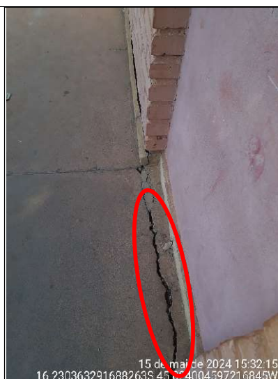
Figura 227 - Detalhe de rachadura na calçada
