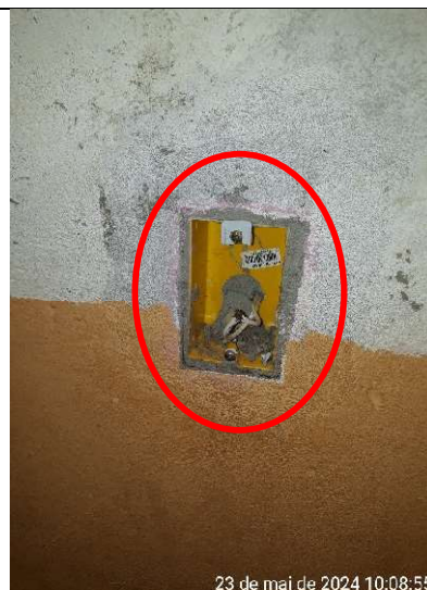
Figura 411 - Detalhe de cabo elétrico aparente devido ausência de espelho da caixa
