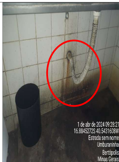
Figura 38 – Detalhe de vazamento de efluente de esgoto, sob a pia da cozinha
