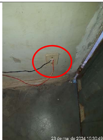
Figura 410 - Detalhe de cabos elétricos conectados diretamente na tomada sem conector (plug)
