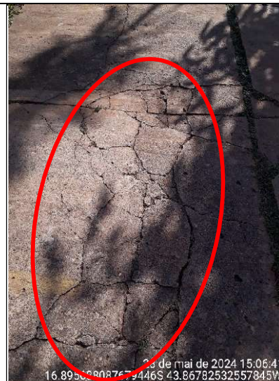
Figura 136 - Detalhe de trecho quebrado da calçada interna de acesso à escola, logo após a rampa
