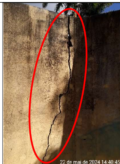
Figura 335 – Detalhe de rachadura no muro de divisa
