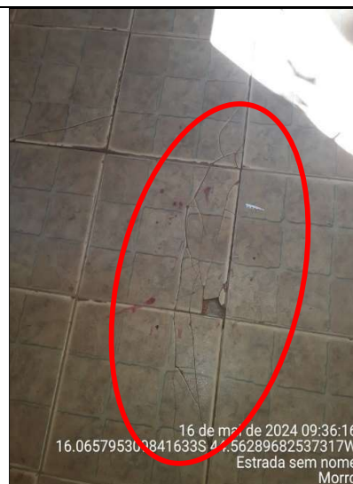
Figura 184 - Detalhe de piso quebrado na sala de aula
