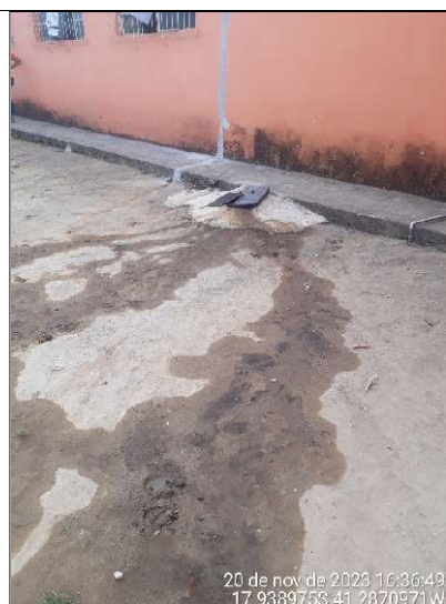
Figura 11 - Detalhe de transbordamento de efluente de esgoto da caixa de gordura
