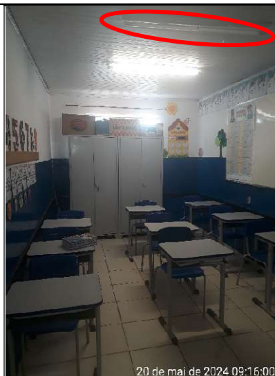
Figura 273 – Detalhe de lâmpada queimada na sala de aula
