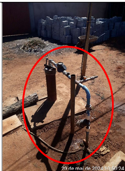
Figura 299 – Detalhe do poço da escola
