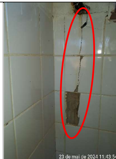
Figura 361 – Detalhe de rachadura na parede do banheiro
