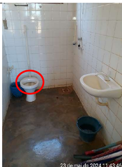
Figura 374 – Detalhe da ausência de assento na bacia sanitária
