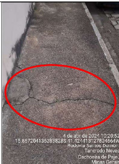
Figura 68 - Detalhe de rachaduras na calçada, lado externo
