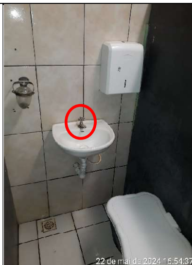
Figura 321 - Detalhe da ausência de metal para acionamento da torneira do lavatório para PcD
