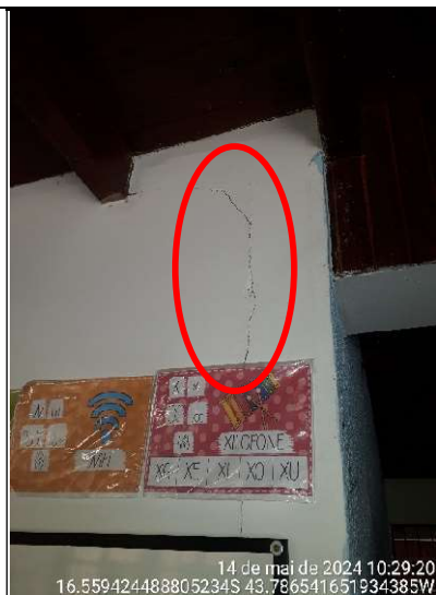
Figura 116 - Detalhe de rachadura na parede da sala de aula
