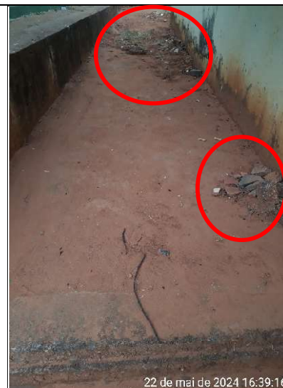
Figura 307 – Detalhe de resíduos jogados entre o muro e calçada
