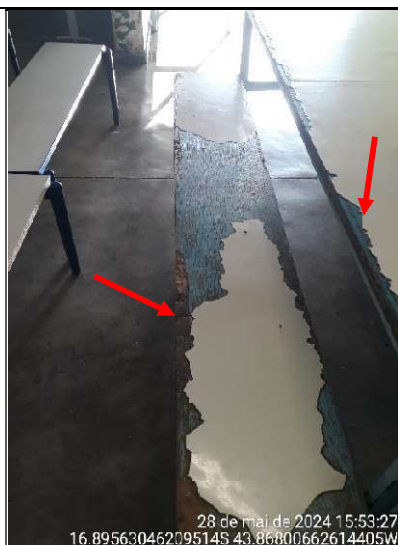
Figura 162 – Detalhes do mau estado de conservação da mesa e banco do refeitório
