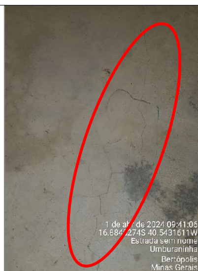
Figura 20 – Detalhe de trinca no piso da sala de aula
