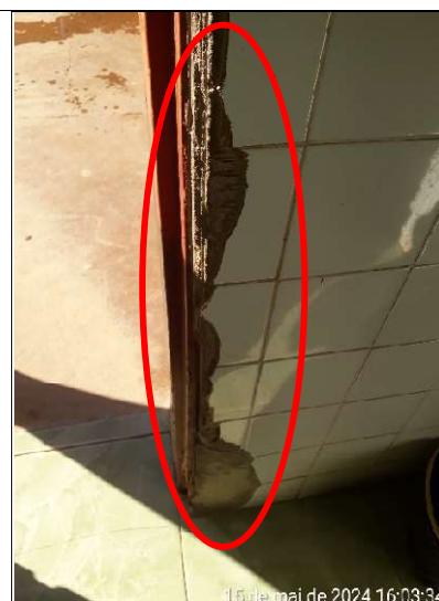
Figura 235 - Detalhe de problema no revestimento do banheiro feminino
