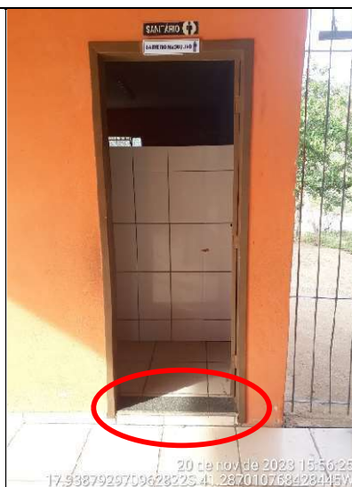
Figura 6 - Detalhe do desnível para acesso ao banheiro
