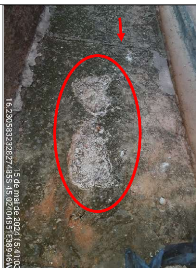
Figura 228 - Detalhes de buracos e rachadura na calçada
