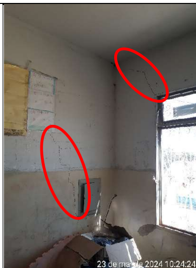
Figura 396 – Detalhes de rachaduras na parede da sala de aula
