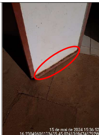
Figura 251 – Detalhe de ferrugem na porta do banheiro masculino
