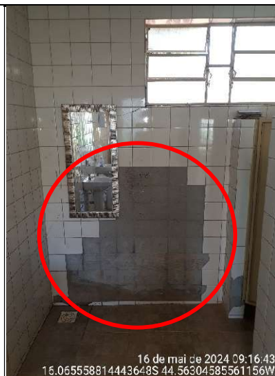
Figura 191 - Detalhe do descolamento dos azulejos do banheiro feminino
