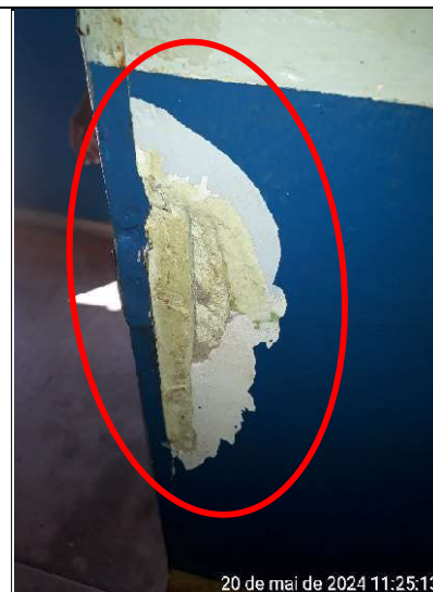
Figura 295 – Detalhe de desgaste da pintura da parede da sala de aula...
