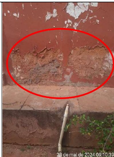
Figura 270 – Detalhes de problemas no revestimento e pintura da parede, lado externo
