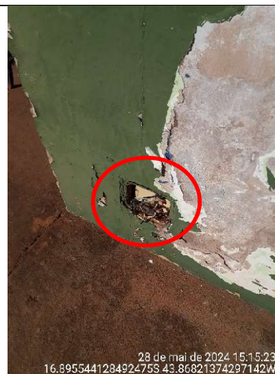
Figura 169 – Detalhe de cabo elétrico aparente pela ausência de espelho na tomada
