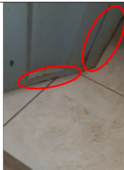
Figura 277 – Detalhe de ferrugem na porta do banheiro masculino
