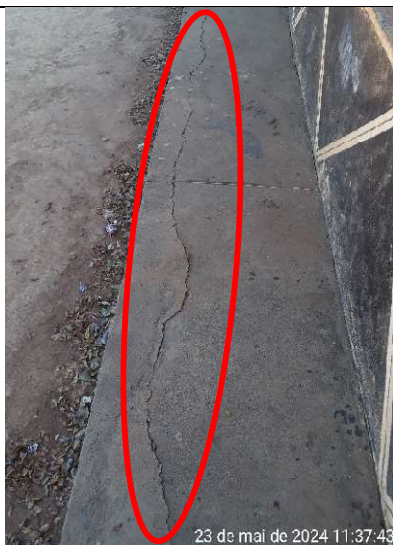
Figura 348 – Detalhe de rachadura na calçada
