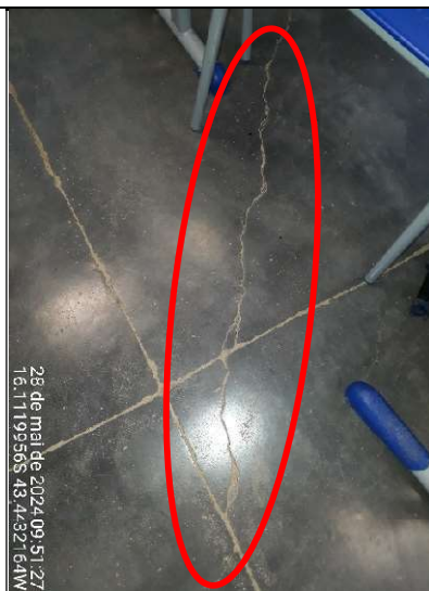
Figura 426 – Detalhe de rachadura no piso da sala de aula
