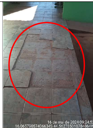
Figura 181 - Detalhe do descolamento de pisos no corredor de acesso às salas de aula
