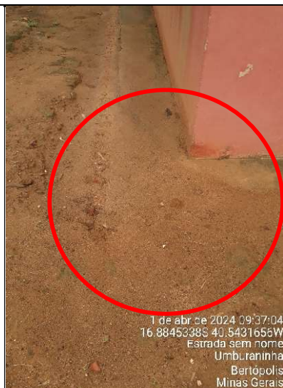
Figura 18 – Detalhe de trecho da calçada coberto por terra
