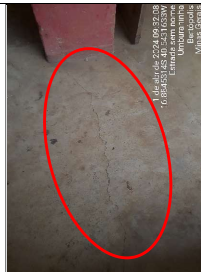
Figura 19 - Detalhe de trinca no piso da cozinha
