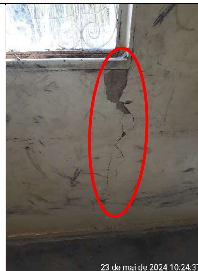
Figura 397 – Detalhe de rachadura na parede da sala de aula
