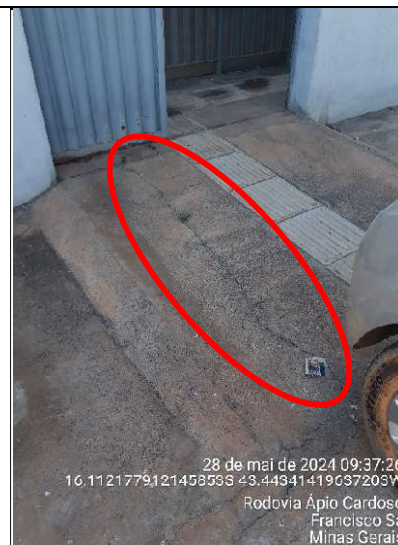
Figura 421 – Detalhe de rachadura na rampa da entrada principal da escola
