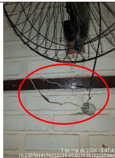
Figura 238 - Detalhes de cabos elétricos aparentes e com remendos na sala de aula...
