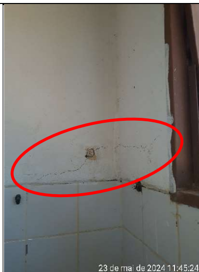
Figura 360 – Detalhe de rachadura na parede do banheiro
