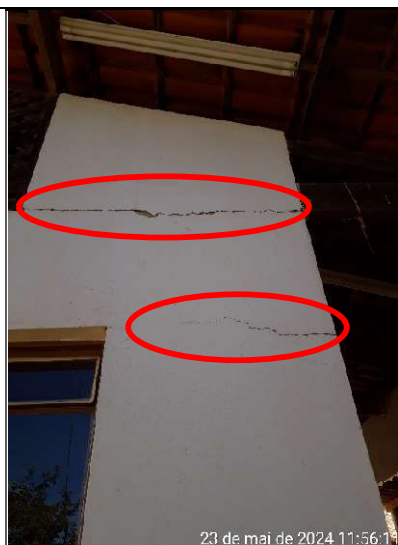
Figura 357 – Detalhes de rachaduras na parede, lado externo
