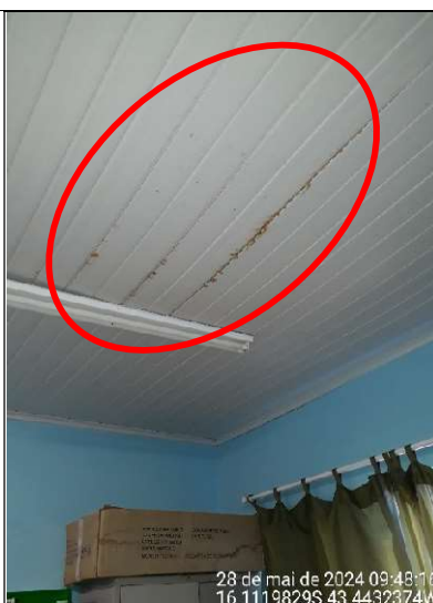
Figura 435 – Detalhe de manchas de infiltrações no forro da sala de aula
