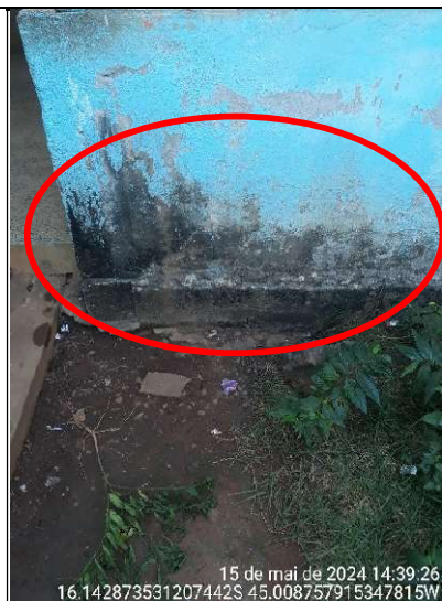
Figura 209 - Detalhe de manchas de infiltração na parede, lado externo
