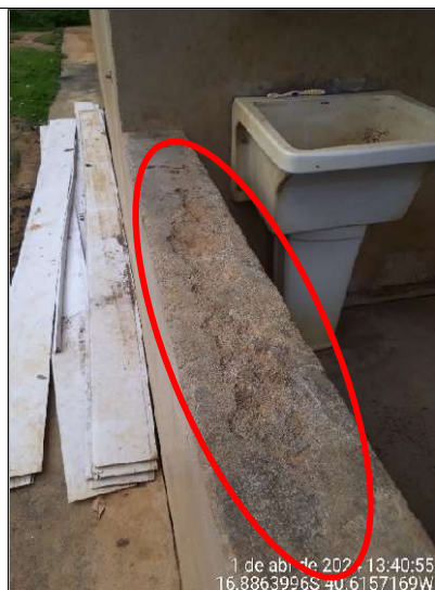
Figura 50 - Detalhe de desgaste de revestimento na face superior da mureta
