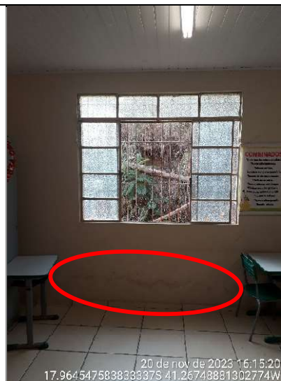
Figura 8 - Detalhe de manchas de infiltração na parede da sala de aula
