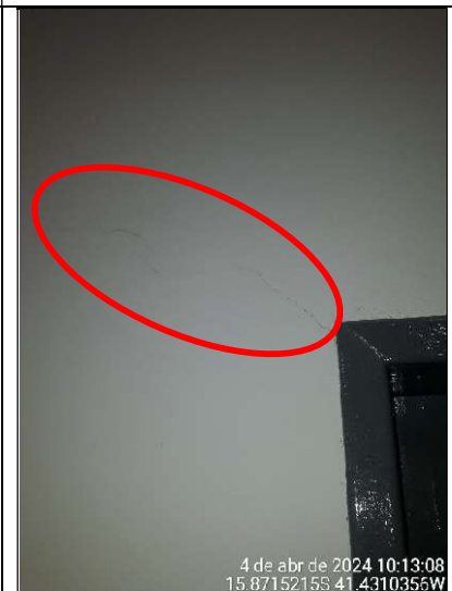
Figura 70 - Detalhe de trinca na parede da sala de aula
