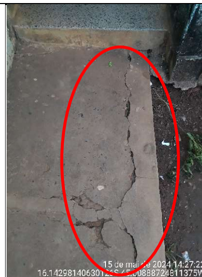
Figura 205 - Detalhe de rachaduras na calçada de acesso à sala de aula
