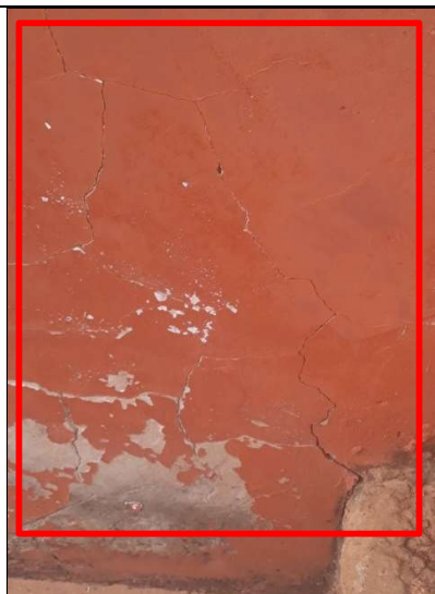
Figura 266 – Detalhes de trincas e rachaduras na parede, lado externo
