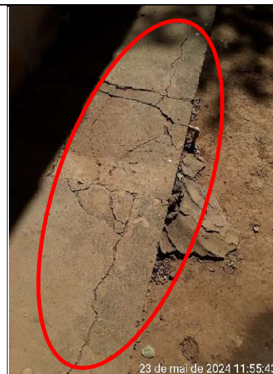
Figura 349 – Detalhes de rachaduras na calçada
