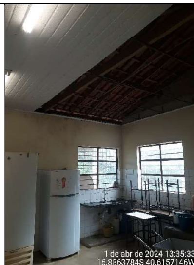
Figura 52 - Detalhe de trecho sem forro na cozinha
