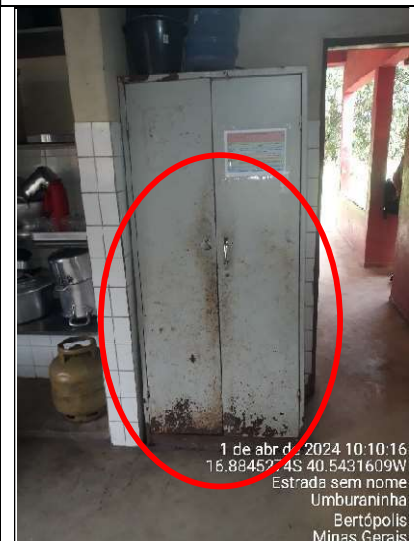
Figura 34 - Detalhe de ferrugem no armário da cozinha
