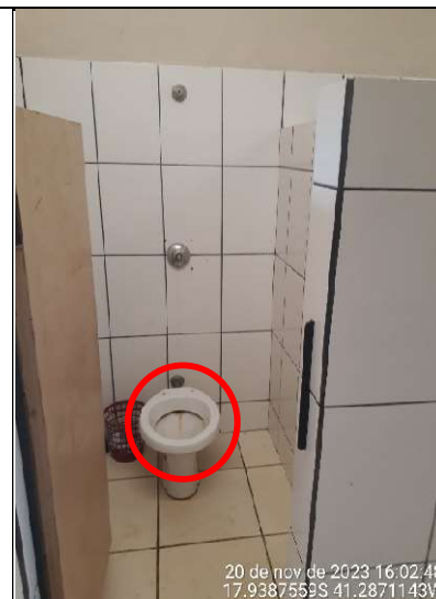
Figura 10 - Detalhe da ausência de assento na bacia sanitária
