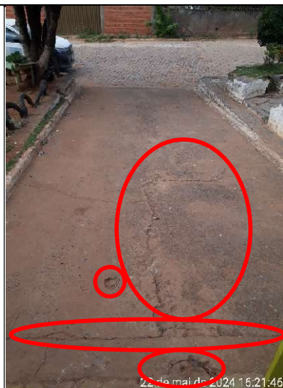
Figura 303 – Detalhes de buracos e rachaduras na rampa de acesso à escola, lado externo
