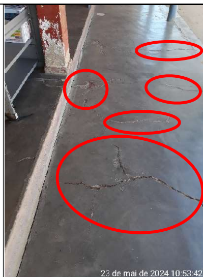
Figura 380 – Detalhes de rachaduras no piso da varanda
