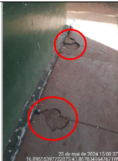
Figura 137 - Detalhes de trechos quebrados da calçada perimetral
