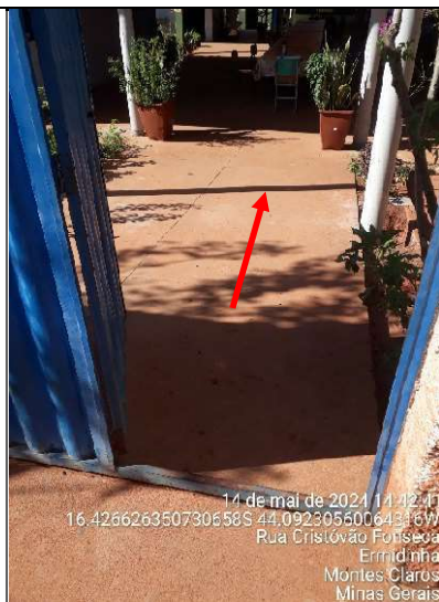
Figura 81 - Detalhe da calçada de acesso à escola, lado interno
