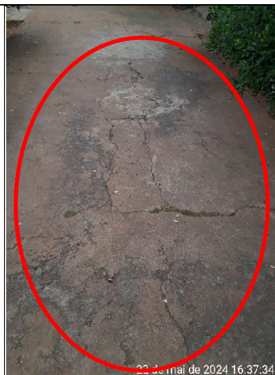
Figura 305 – Detalhes de rachaduras na rampa de acesso à escola, lado interno
