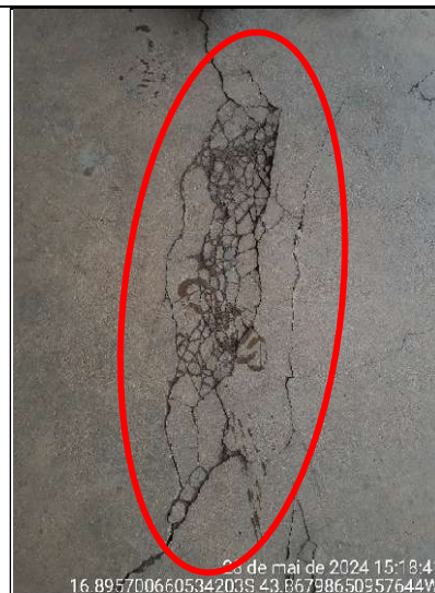
Figura 139 - Detalhe de trecho quebrado do piso do pátio
