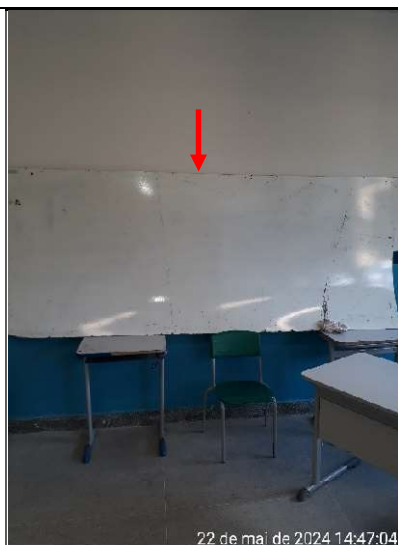
Figura 342 – Detalhe do quadro (lousa) da sala de aula solto da parede
