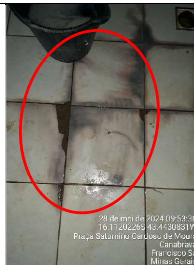
Figura 427 – Detalhes de pisos quebrados e manchados na cozinha
