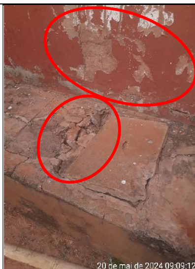
Figura 261 – Detalhes de trechos com buracos na calçada e na parede
