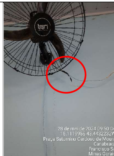
Figura 439 – Detalhe de cabo elétrico aparente e com remendo
