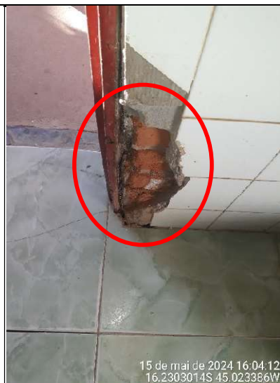
Figura 236 – Detalhe de trecho quebrado da parede do banheiro masculino
