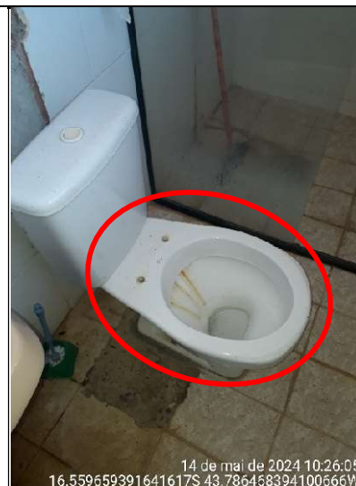
Figura 130 - Detalhe da ausência de assento na bacia sanitária
