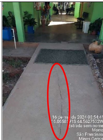
Figura 176 - Detalhe de rachadura na calçada de acesso à escola
