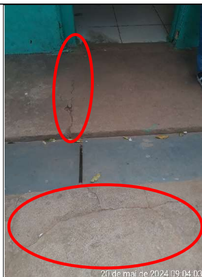
Figura 260 – Detalhes de trincas e rachadura na calçada
