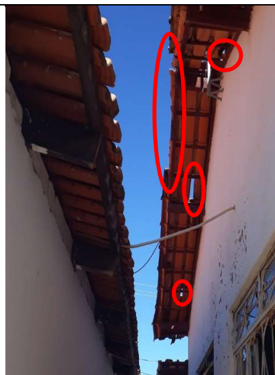
Figura 407 - Detalhes de problemas no beiral da cobertura
