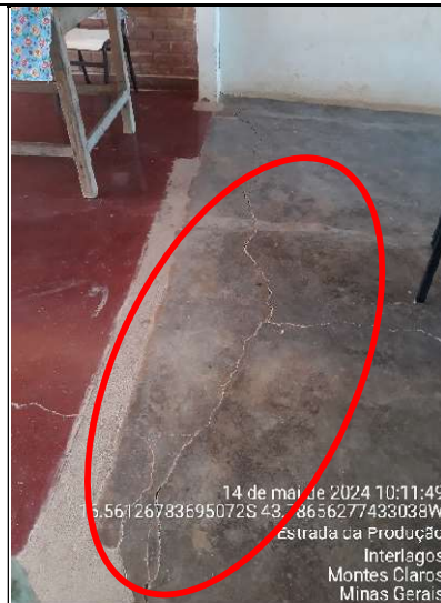
Figura 108 - Detalhe de rachaduras no piso da varanda externa...
