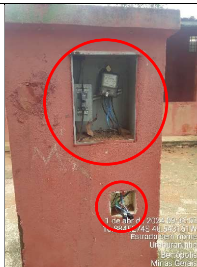
Figura 35 – Detalhes do quadro de entrada de energia sem tampa, com cabos elétricos aparentes e com remendos
