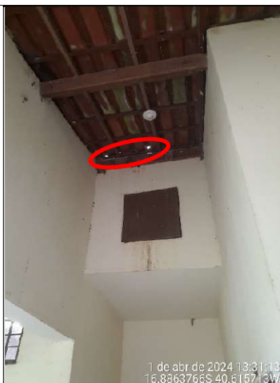
Figura 51 - Detalhe de frestas de luz na cobertura
