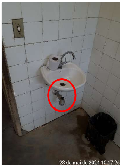
Figura 414 – Detalhe da ausência do copo do sifão do lavatório
