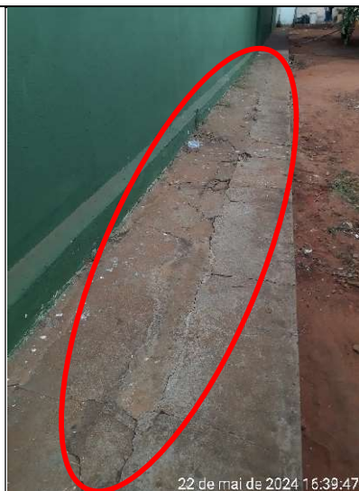
Figura 306 – Detalhes de rachaduras na calçada perimetral
