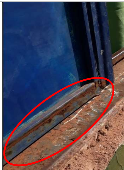
Figura 156 – Detalhe de ferrugem na janela da sala de aula
