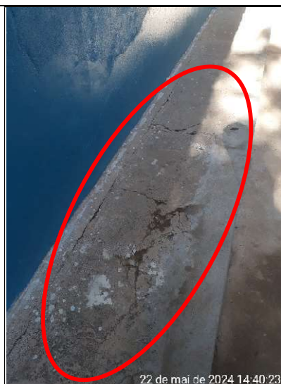
Figura 329 – Detalhes de trincas e rachaduras na calçada
