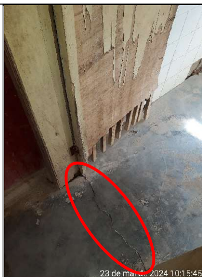
Figura 381 – Detalhe de rachadura no piso do banheiro
