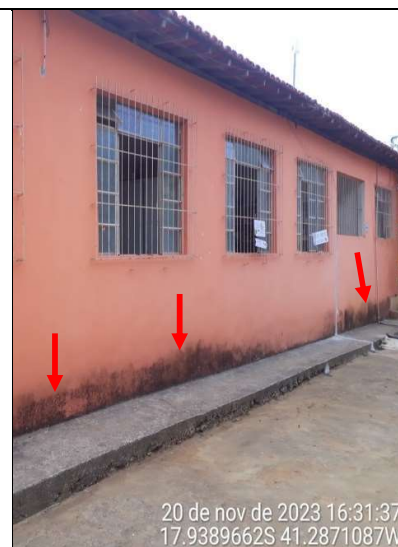
Figura 7 – Detalhe de manchas de infiltração na parede, lado externo
