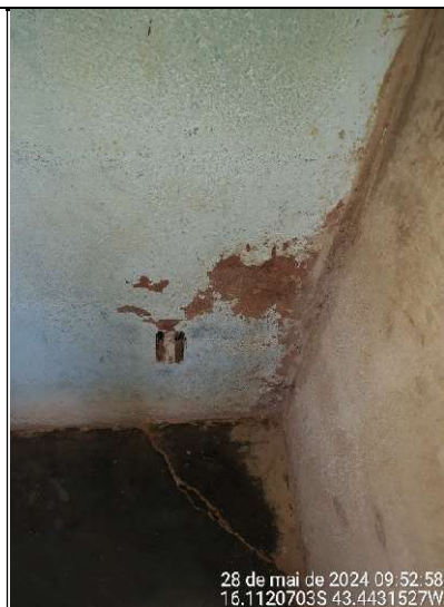
Figura 431 – Detalhe da sujeira e falta de pintura na parede da despensa
