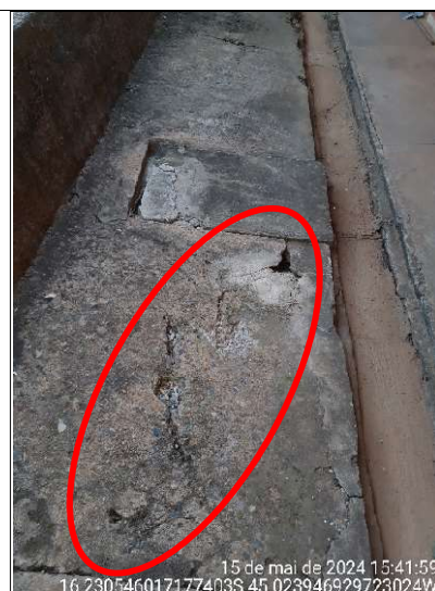
Figura 229 - Detalhes das rachaduras e buracos na calçada
