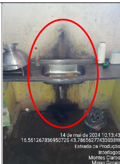
Figura 131 – Detalhe da falta de higiene na pia da cozinha
