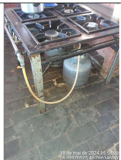
Figura 256 – Detalhes dos botijões de GLP no fogão
