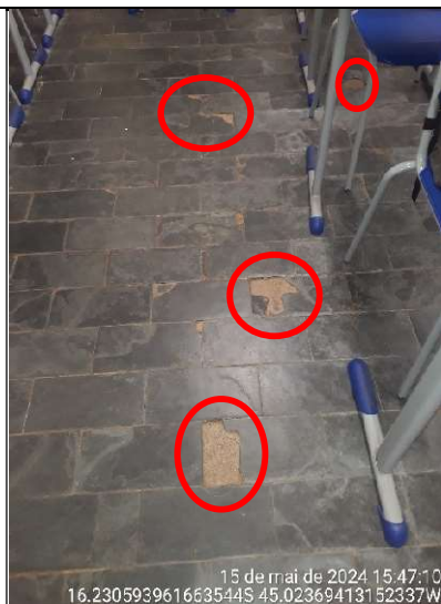
Figura 231 - Detalhes de pisos quebrados na sala de aula
