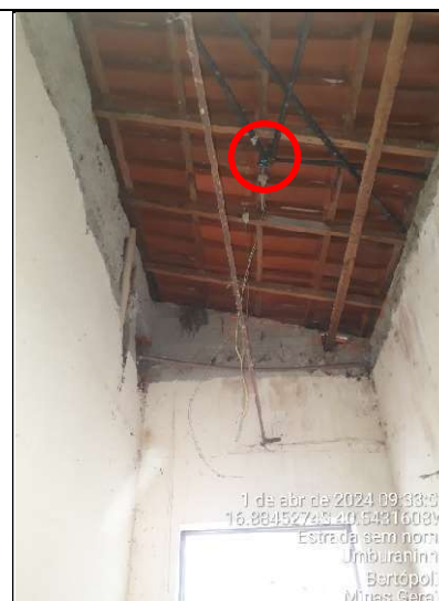
Figura 28 - Detalhes das ausências de forro e de lâmpada no banheiro
