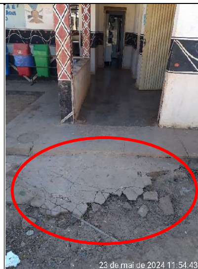
Figura 347 – Detalhe do acesso principal à escola, com concreto quebrado
