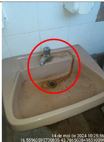
Figura 128 – Detalhe de vazamento na torneira do lavatório
