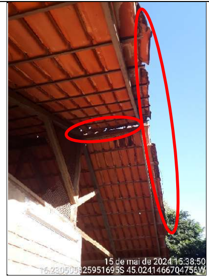
Figura 244 – Detalhes de problemas no beiral e cumeeira da cobertura
