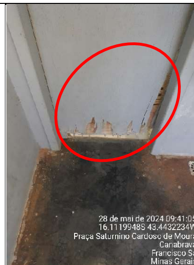
Figura 433 – Detalhe de problema de umidade na porta do banheiro
