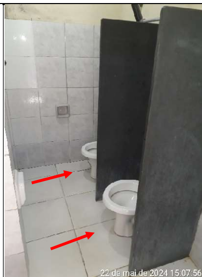
Figura 338 – Detalhes das bacias sanitárias sem assentos e boxes sem portas
