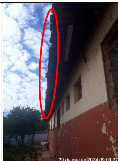
Figura 278 – Detalhe do desalinhamento das telhas do beiral da cobertura
