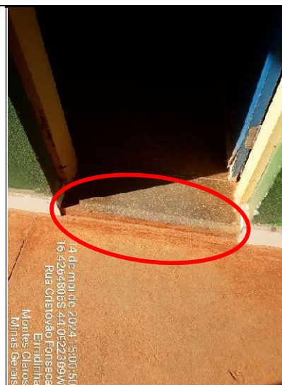
Figura 85 - Detalhe de desnível para acesso ao banheiro
