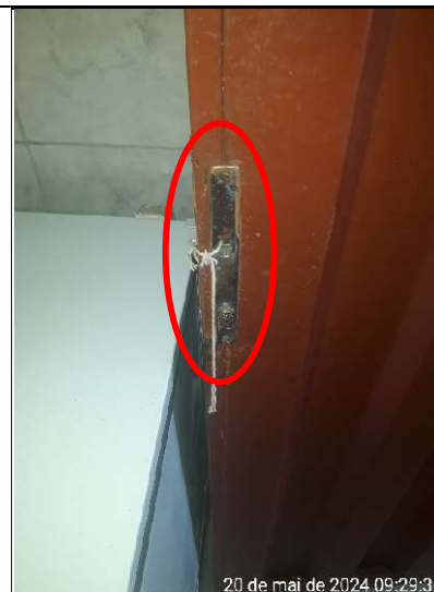
Figura 274 – Detalhe da ausência de maçaneta na porta da despensa
