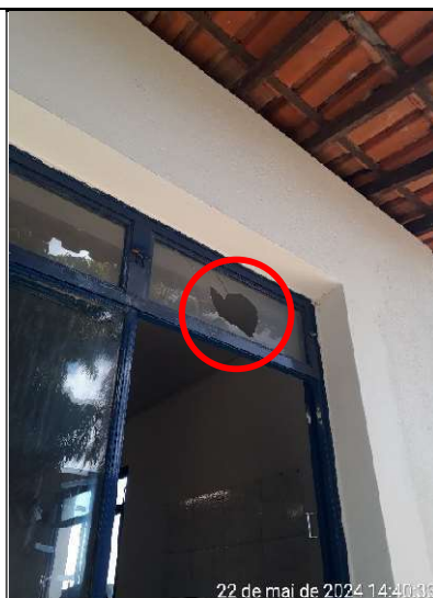
Figura 336 – Detalhe da janela da sala de aula com vidro quebrado
