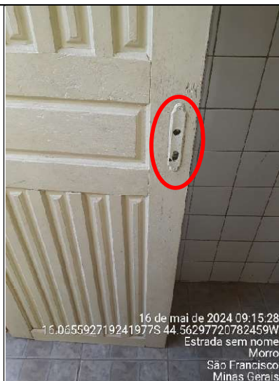
Figura 200 – Detalhe da porta do banheiro feminino sem maçaneta
