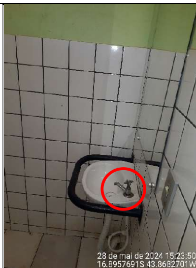
Figura 165 – Detalhe da ausência de acabamento de metal para acionamento da torneira do lavatório para PcD
