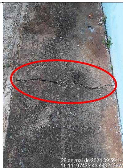
Figura 422 – Detalhe de rachadura na calçada, lado interno da escola
