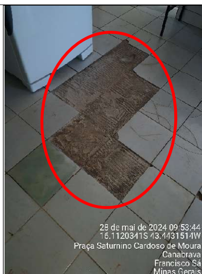
Figura 428 – Detalhe de descolamento de pisos na cozinha
