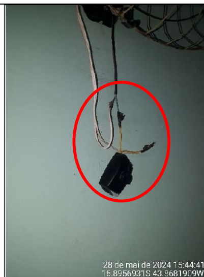
Figura 167 – Detalhe de cabos elétricos aparentes e com remendos
