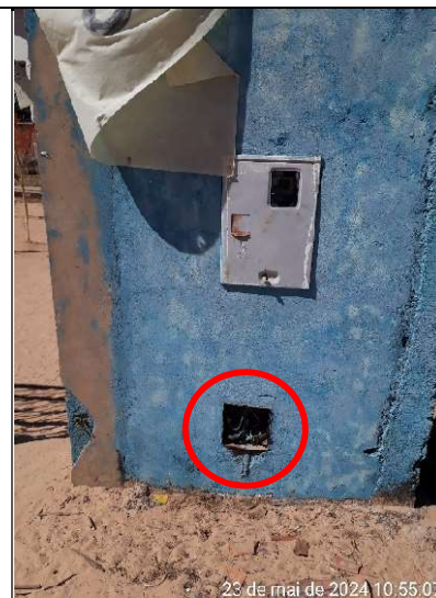
Figura 409 - Detalhe de cabos elétricos aparentes na mureta de entrada de energia da escola
