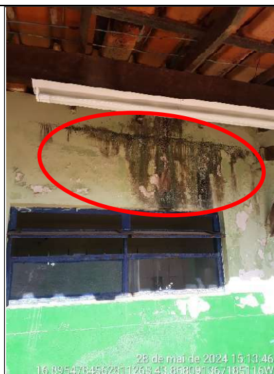
Figura 149 - Detalhe de infiltrações na parede, lado externo
