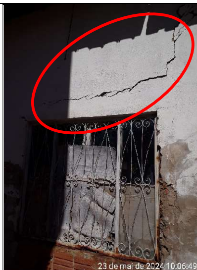
Figura 390 – Detalhe de rachadura na parede, lado externo
