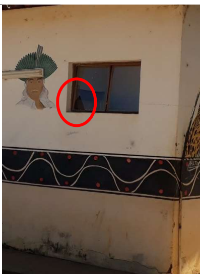
Figura 368 – Detalhe da janela do banheiro com vidro quebrado
