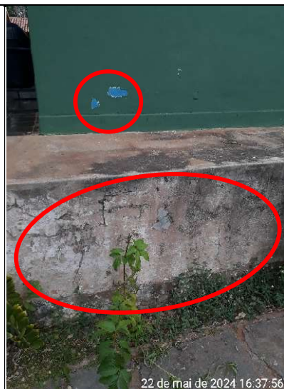
Figura 314 – Detalhe de desgaste da pintura, lado externo
