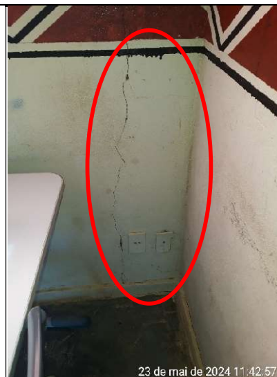
Figura 359 – Detalhe de rachadura na parede da sala de aula
