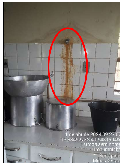
Figura 37 – Detalhe de vazamento de água no registro
