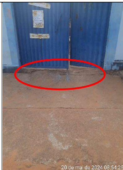
Figura 258 – Detalhe da falta de acabamento do concreto próximo ao portão de entrada
