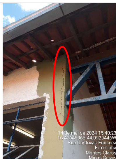
Figura 89 - Detalhe de rachadura na parede
