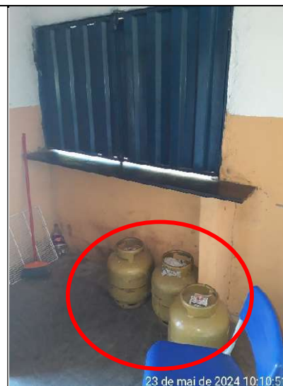
Figura 418 – Detalhe do armazenamento de três botijões de GLP na cozinha
