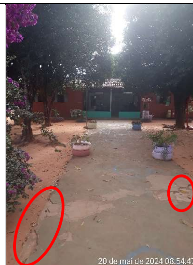
Figura 259 – Detalhes de trechos quebrados da calçada de acesso à escola
