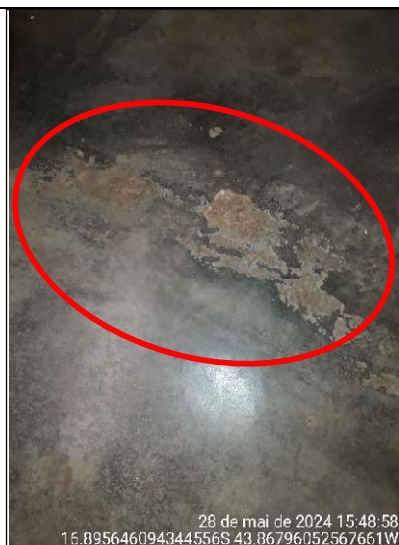
Figura 143 - Detalhe de desgaste no piso da sala de aula
