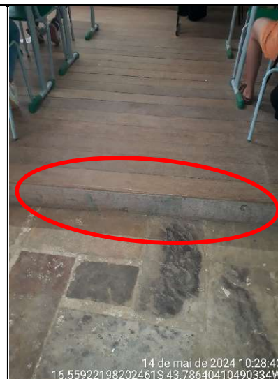
Figura 112 – Detalhe de desnível entre pisos, dentro da sala de aula
