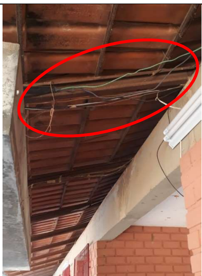
Figura 239 - Detalhes de cabos elétricos aparentes e com remendos
