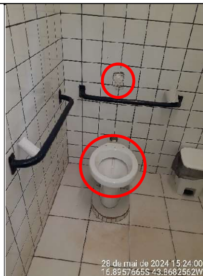
Figura 164 – Detalhes das ausências: de acabamento de metal para acionamento da válvula de descarga para PcD e de assento na bacia sanitária
