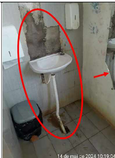
Figura 129 - Detalhe da precariedade das condições de uso do banheiro
