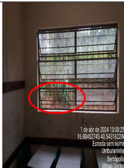
Figura 32 - Detalhe da janela da sala de aula com vão sem vidro
