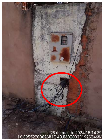
Figura 168 – Detalhes de cabos elétricos aparentes e com remendos...
