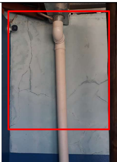
Figura 291 – Detalhes de rachaduras na parede, lado externo
