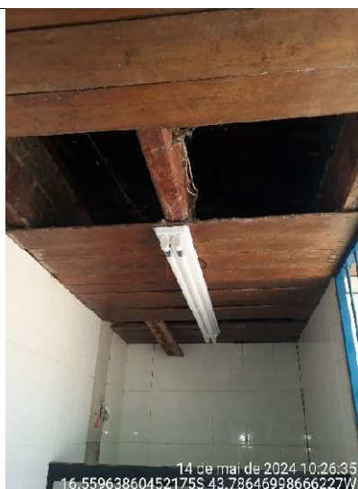
Figura 120 - Detalhe da precariedade do forro de madeira do banheiro
