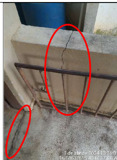
Figura 46 - Detalhes de rachaduras no piso e mureta
