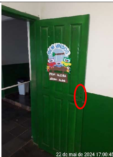
Figura 315 – Detalhe da porta da sala de aula sem maçaneta e fechadura
