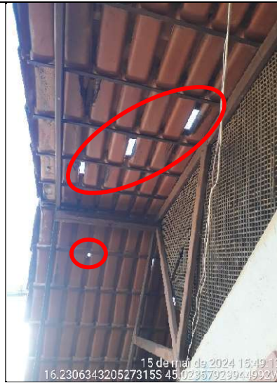
Figura 243 – Detalhes de problemas no beiral da cobertura...
