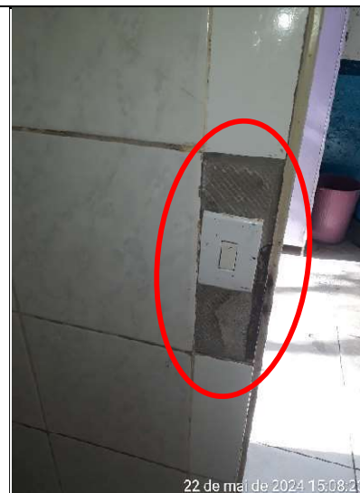
Figura 334 – Detalhe de trecho sem azulejos na parede do banheiro
