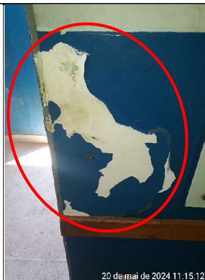
Figura 293 – Detalhe de desgaste da pintura da parede da sala de aula
