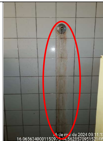
Figura 193 - Detalhe de vazamento no registro do banheiro masculino
