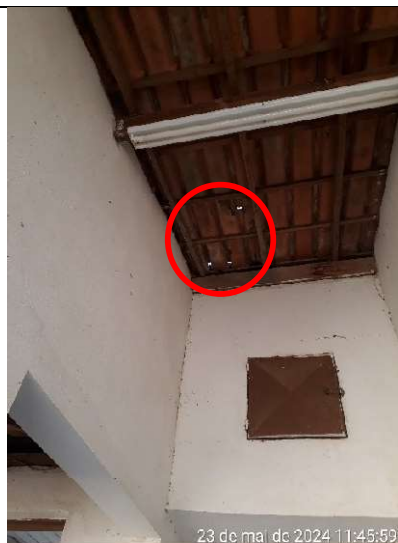
Figura 371 – Detalhe de frestas de luz na cobertura
