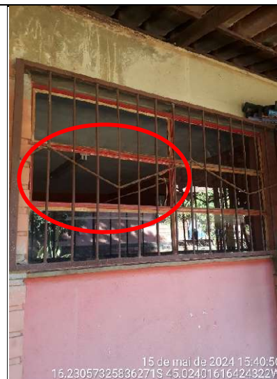
Figura 250 – Detalhe de vão da janela sem vidro
