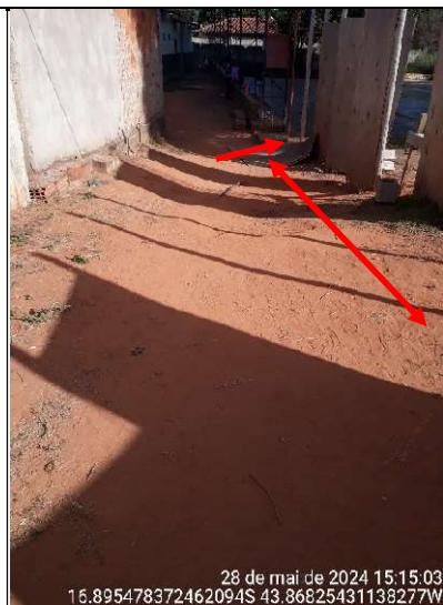
Figura 140 - Detalhe da ausência de calçada para acesso à quadra poliesportiva
