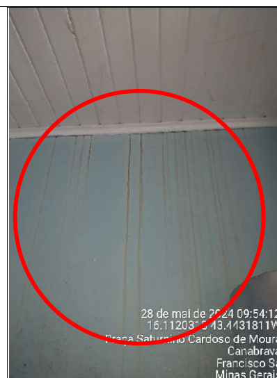
Figura 436 – Detalhe de manchas de infiltrações na parede da cozinha
