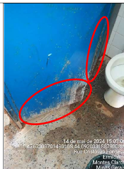
Figura 91 - Detalhe de ferrugem na porta do box do banheiro
