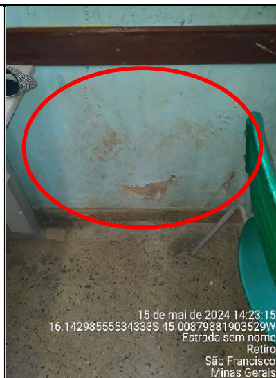
Figura 215 - Detalhe do desgaste da pintura da parede da sala de aula...
