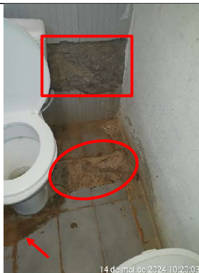
Figura 110 – Detalhes de problemas no piso e parede do banheiro
