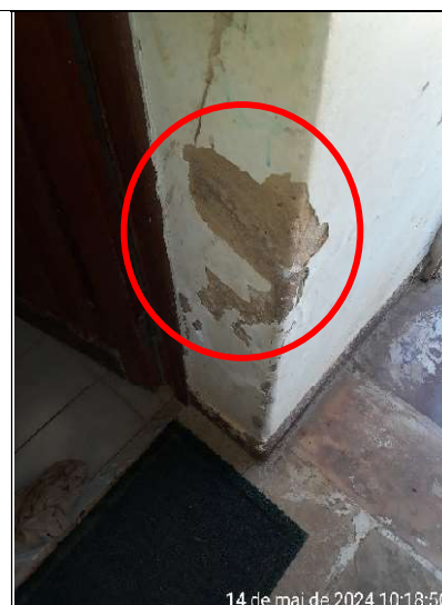
Figura 115 - Detalhe de problema no revestimento da parede
