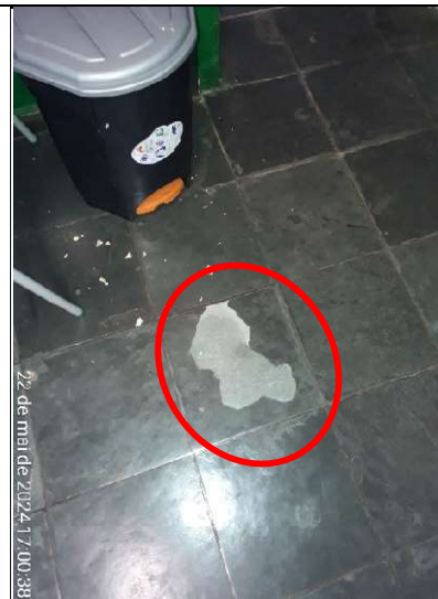
Figura 310 – Detalhe de desgaste no piso da sala de aula
