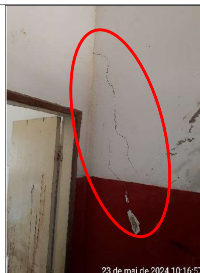
Figura 394 – Detalhes de rachaduras na parede do banheiro
