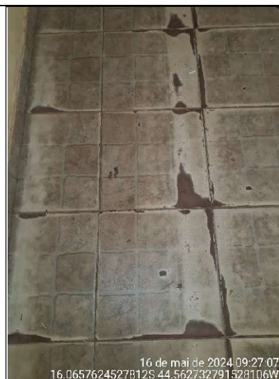
Figura 182 - Detalhe de desgaste do piso da sala de aula
