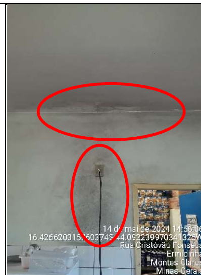
Figura 88 - Detalhes de manchas de umidade na laje e parede da cozinha
