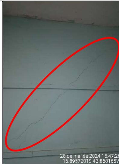
Figura 153 – Detalhe de rachadura na parede da sala de aula
