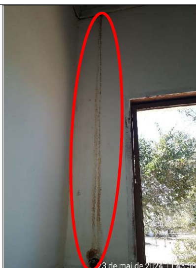
Figura 363 – Detalhe das manchas de infiltração na parede do banheiro
