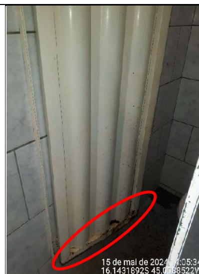
Figura 220 - Detalhe de ferrugem na porta do box do banheiro feminino
