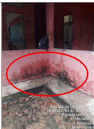
Figura 21 - Detalhe de manchas de infiltração na parede, lado externo
