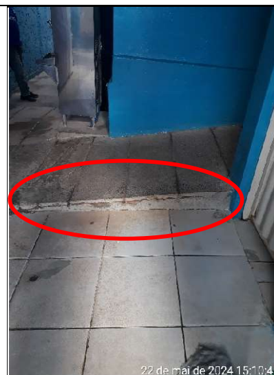
Figura 331 – Detalhe de trecho final da rampa sem proteção
