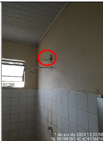
Figura 60 - Detalhe de cabo elétrico aparente e com remendo
