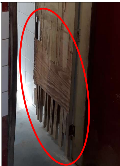
Figura 402 – Detalhe da situação precária da porta de madeira do banheiro
