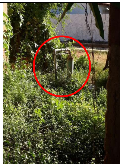
Figura 442 – Detalhe do poço comunitário que abastece a escola
