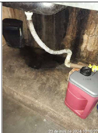
Figura 416 – Detalhe da precariedade das condições de higiene sob a pia da cozinha
