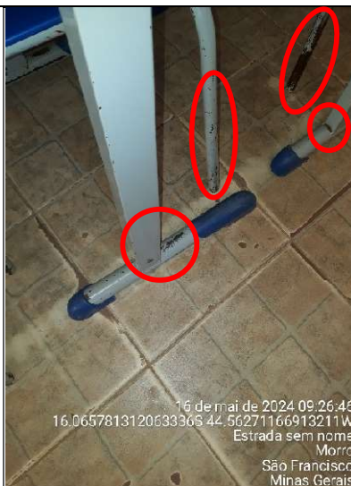
Figura 201 – Detalhes de ferrugens nas mesas e cadeiras da sala de aula
