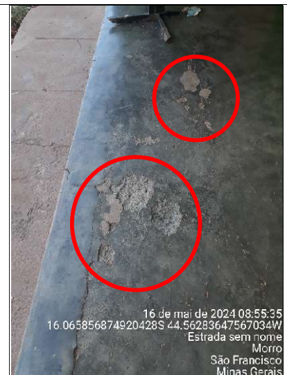
Figura 178 - Detalhes de buracos no piso do pátio
