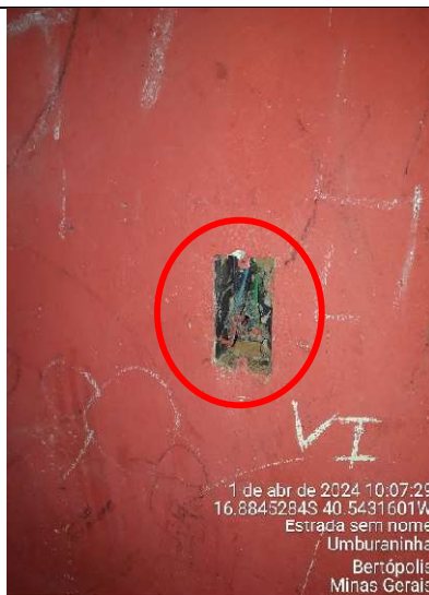
Figura 36 - Detalhe de tomada sem espelho e com cabos elétricos aparentes e com remendos
