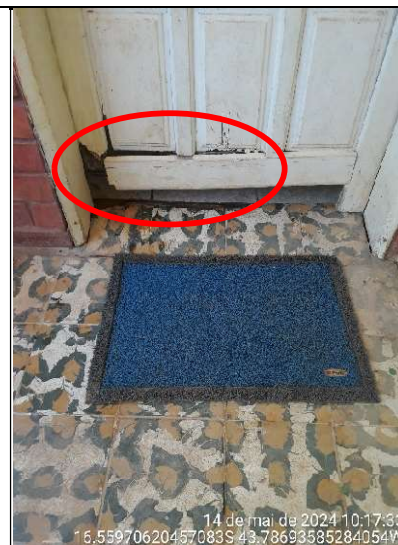
Figura 124 – Detalhe do mau estado de conservação da porta do banheiro masculino devido à umidade
