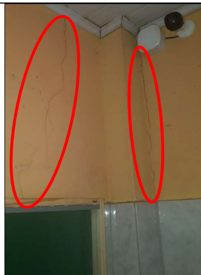
Figura 268 – Detalhes de trinca e rachadura na parede da cozinha
