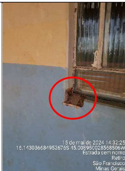
Figura 216 - Detalhe de trecho quebrado da parede, lado externo
