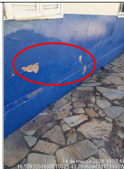
Figura 118 - Detalhes de desgastes na pintura da parede, lado externo
