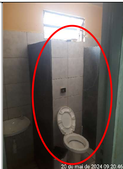
Figura 275 – Detalhe de ausência de porta no box do banheiro feminino
