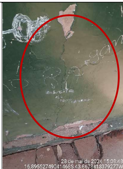
Figura 147 - Detalhe de trincas na parede, lado externo
