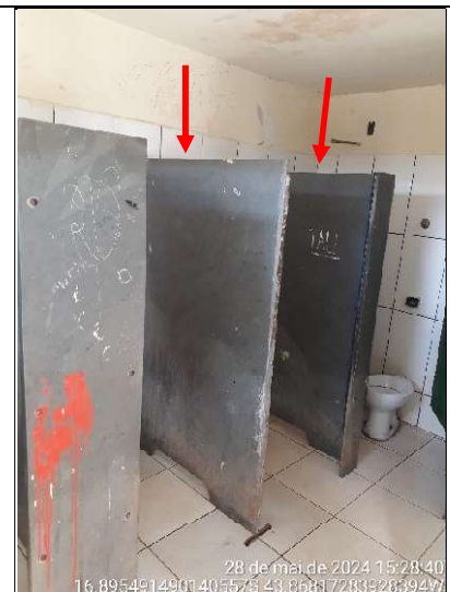
Figura 157 – Detalhes das ausências das portas dos boxes do banheiro
