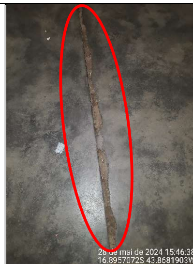
Figura 142 - Detalhe de buraco no piso da sala de aula
