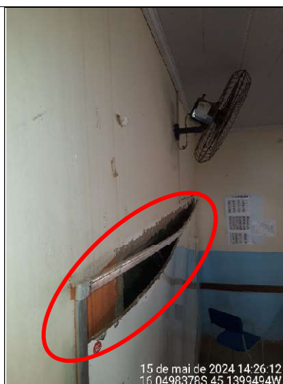
Figura 212 - Detalhe do descolamento do quadro escolar
