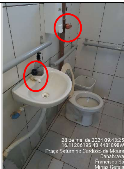
Figura 441 – Detalhes das ausências dos metais para acionamento da torneira e da válvula de descarga para PcD
