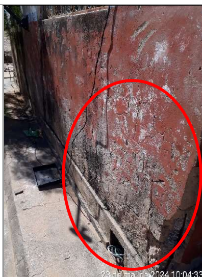
Figura 387 – Detalhes de trincas e rachaduras na parede frontal
