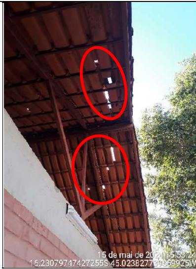
Figura 242 – Detalhes de problemas no beiral da cobertura
