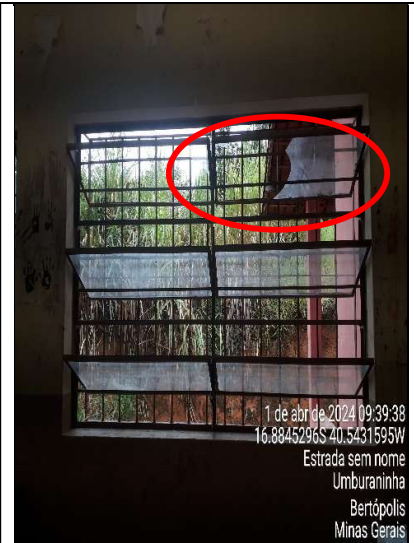
Figura 31 - Detalhe da janela da sala de aula com vidro danificado
