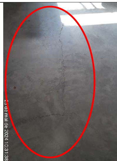
Figura 382 – Detalhes de rachaduras no piso da sala de aula
