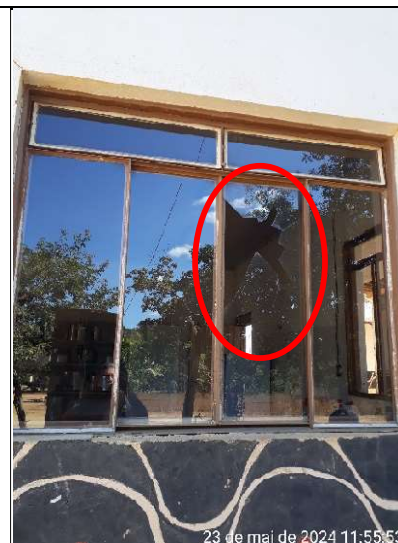
Figura 367 – Detalhe da janela da cozinha com vidro quebrado
