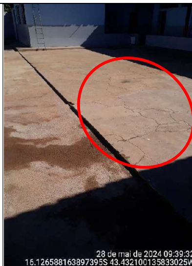
Figura 423 – Detalhe de rachaduras no piso do pátio descoberto interno
