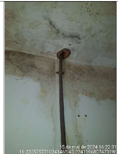
Figura 247 - Detalhes das manchas de infiltração na laje e parede do banheiro feminino
