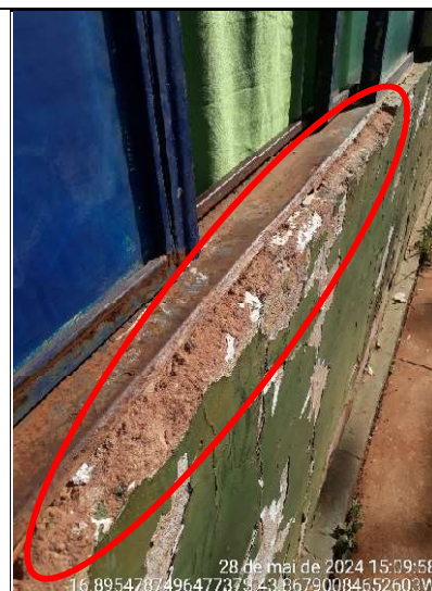
Figura 151 - Detalhe de desgaste do revestimento da parede, lado externo
