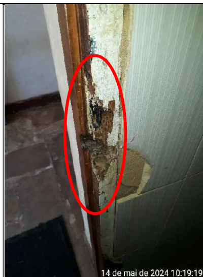
Figura 122 – Detalhe de problema no batente da porta
