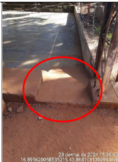
Figura 141 - Detalhe das ausências de guarda-corpo e corrimão na rampa de acesso à quadra poliesportiva
