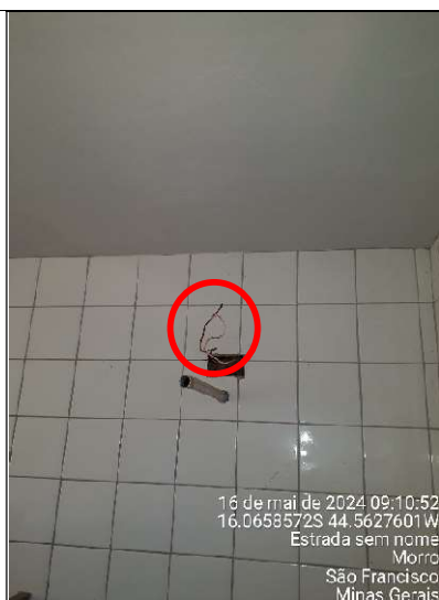
Figura 195 - Detalhe de cabos elétricos aparentes
