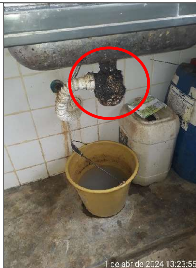
Figura 56 - Detalhe de falta de higiene na instalação sanitária sob a pia da cozinha
