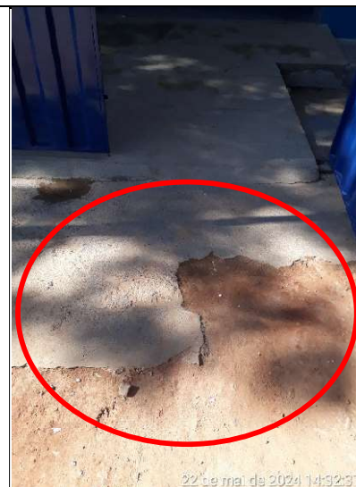
Figura 328 – Detalhe de trecho quebrado da calçada de acesso à escola, lado externo
