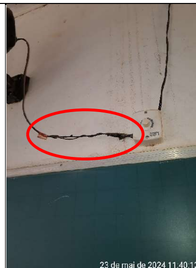
Figura 373 – Detalhe de cabos elétricos aparentes e com remendos
