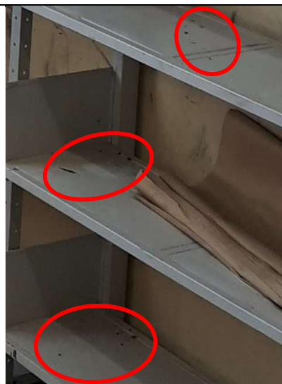
Figura 401 – Detalhe de ferrugem no armário da sala de aula
