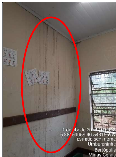
Figura 23 - Detalhe de manchas de infiltração na parede da sala de aula
