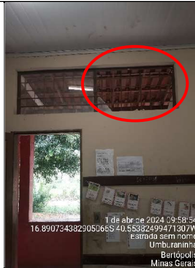
Figura 30 - Detalhe da janela da sala de aula com vidro danificado
