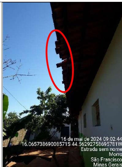
Figura 188 - Detalhe de problemas no beiral da cobertura
