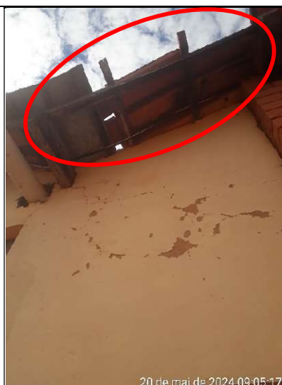
Figura 279 – Detalhe de problemas no madeiramento e telhas do beiral da cobertura
