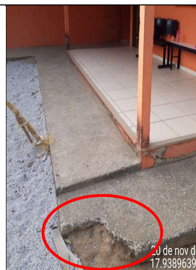
Figura 4 - Detalhe de trecho danificado da calçada
