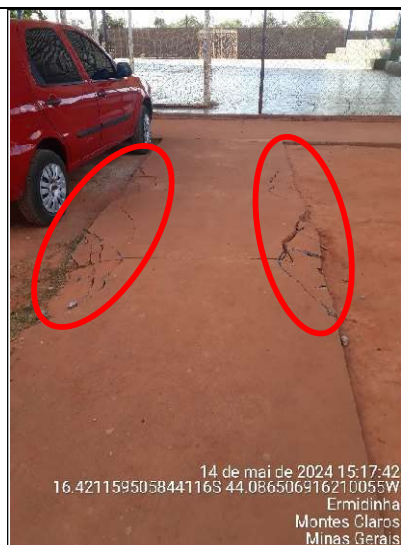
Figura 83 - Detalhes de trechos quebrados da calçada de acesso à quadra
