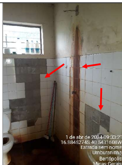
Figura 26 - Detalhes de mancha e trechos sem azulejos na parede do banheiro
