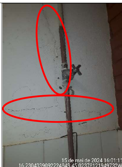
Figura 234 - Detalhes de trincas na parede do banheiro feminino
