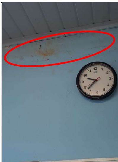
Figura 437 – Detalhe de manchas de infiltração na parede da sala de aula
