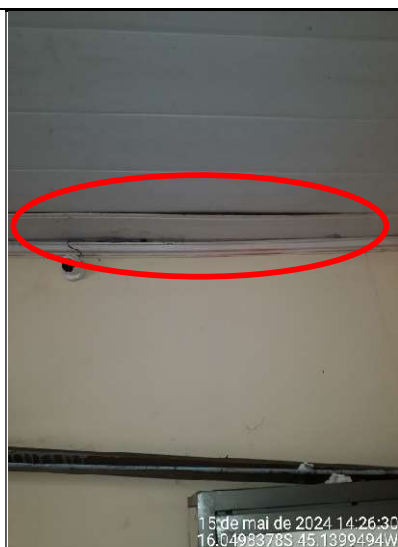
Figura 219 - Detalhe do deslocamento do forro da sala de aula devido à infiltração
