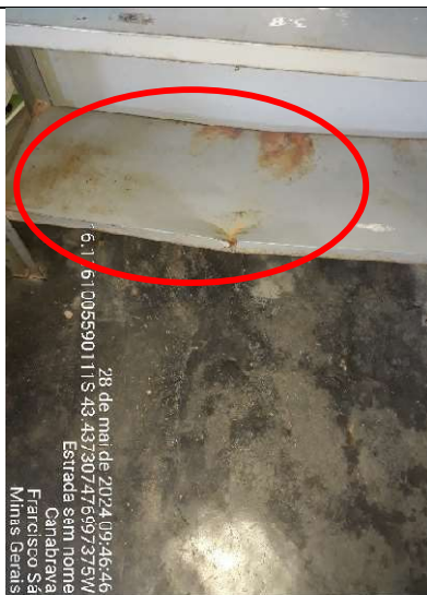
Figura 432 – Detalhe de ferrugem no armário da sala de aula
