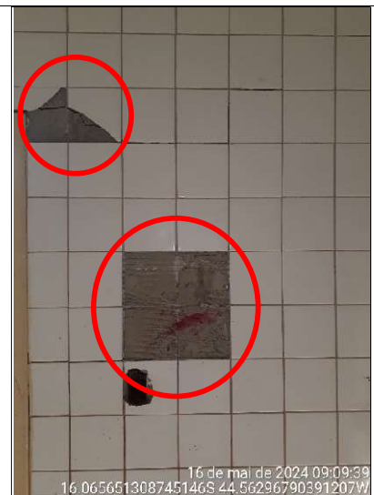
Figura 190 - Detalhes de problemas nos azulejos do banheiro masculino
