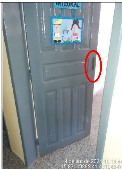
Figura 72 - Detalhe da ausência de maçaneta na porta da sala de aula
