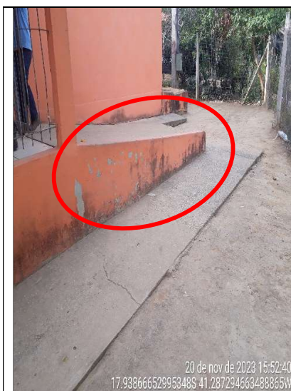
Figura 2 – Detalhe da rampa de acesso principal à escola, sem corrimão
