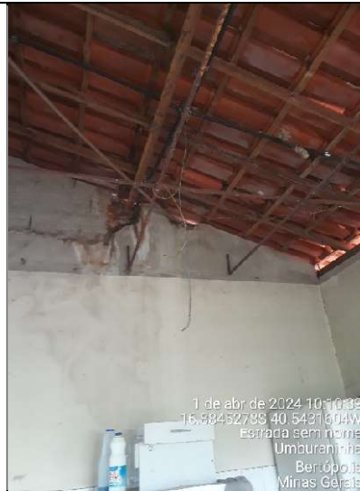
Figura 29 - Detalhe da ausência de forro na cozinha
