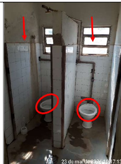
Figura 403 – Detalhes das ausências: das portas dos boxes do banheiro e dos assentos das bacias sanitárias
