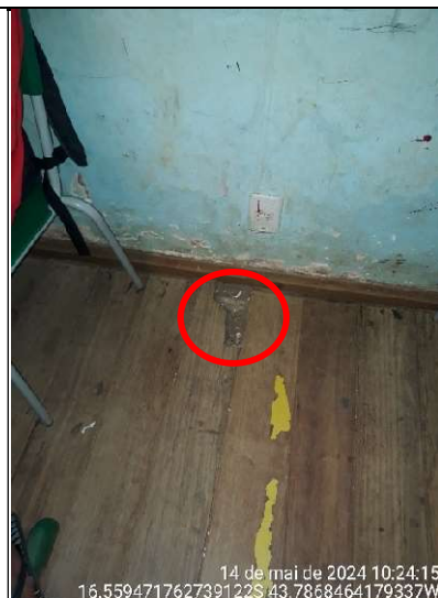
Figura 111 – Detalhe de buraco no piso da sala de aula
