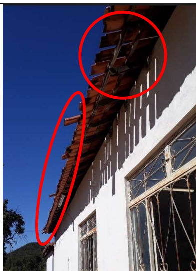
Figura 408 - Detalhes de problemas no beiral da cobertura...
