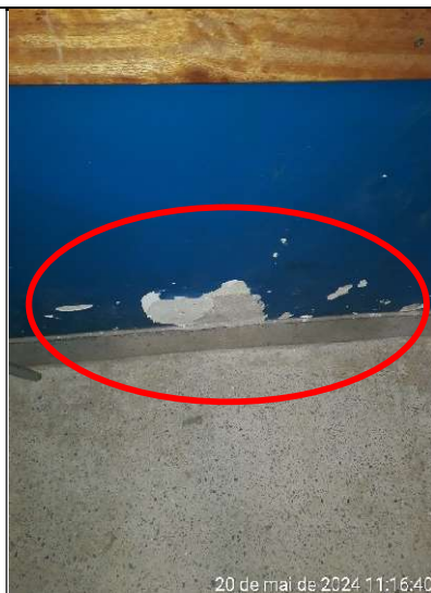
Figura 294 – Detalhe de desgaste da pintura da parede da sala de aula...
