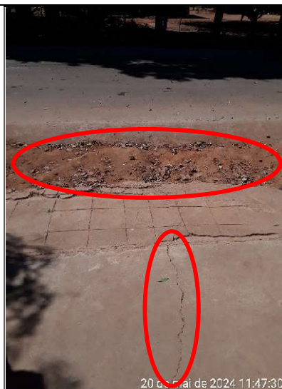
Figura 288 – Detalhes de trecho em terra e rachadura na rampa de acesso à escola
