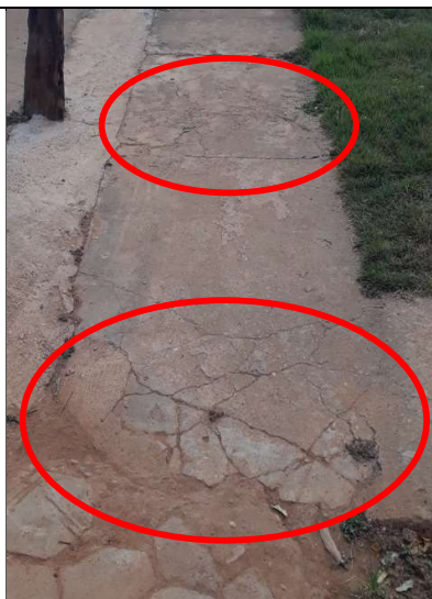
Figura 420 – Detalhe de rachaduras na rampa lateral de acesso à escola, lado externo
