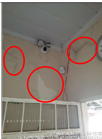
Figura 213 - Detalhes do desgaste da pintura da parede da cozinha
