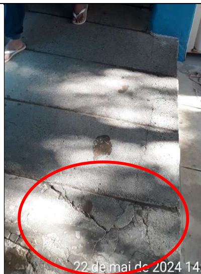
Figura 332 – Detalhe de rachaduras no piso da rampa
