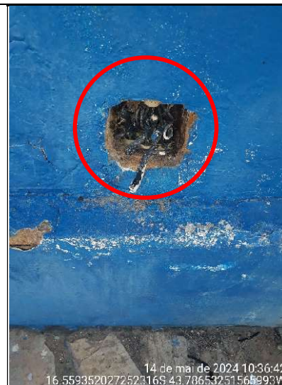
Figura 127 - Detalhe de cabo elétrico aparente devido à ausência do espelho da tomada
