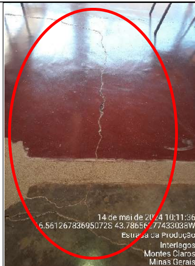
Figura 107 - Detalhe de rachaduras no piso da varanda externa
