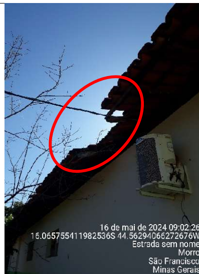
Figura 189 - Detalhe de problema no beiral devido à quebra do madeiramento
