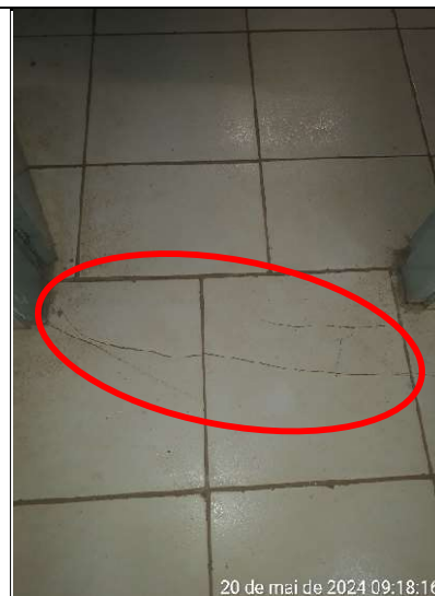
Figura 265 – Detalhe de trincas no pisos da sala de aula
