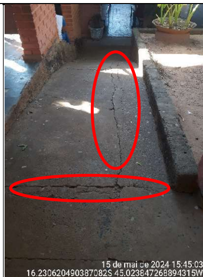
Figura 230 - Detalhes de rachaduras na calçada
