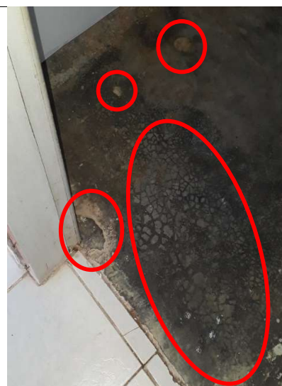
Figura 430 – Detalhes de manchas, fissuras e buracos no piso da despensa
