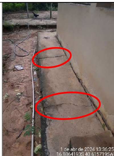
Figura 44 - Detalhes de rachaduras na calçada
