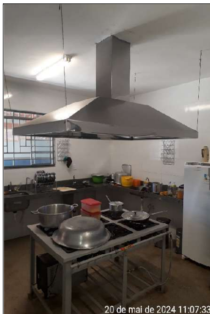
Figura 450 – Detalhe da coifa na cozinha
