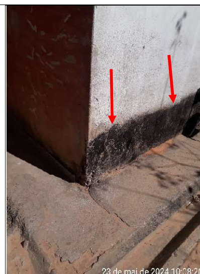
Figura 400 – Detalhe de mancha de infiltração na parede, lado externo
