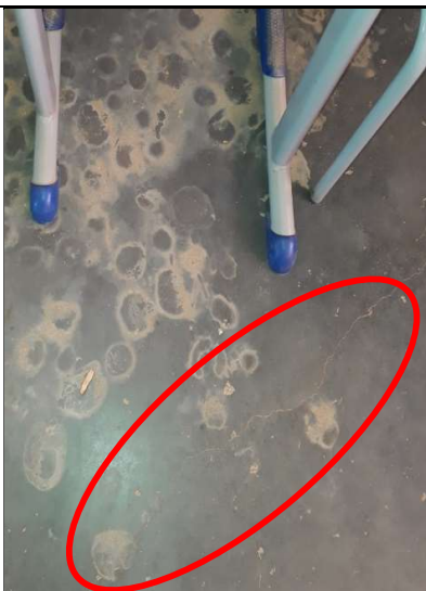
Figura 351 – Detalhes de trinca e manchas no piso da sala de aula
