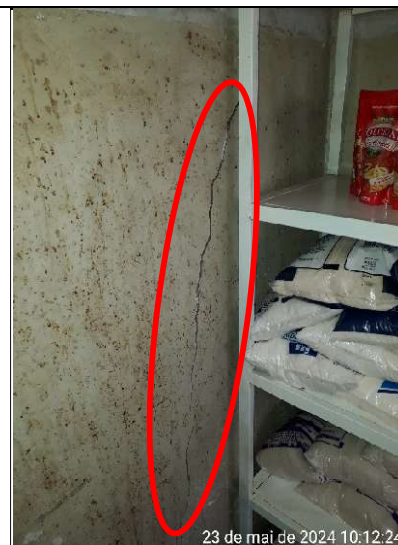
Figura 391 – Detalhe de rachadura na parede da cozinha
