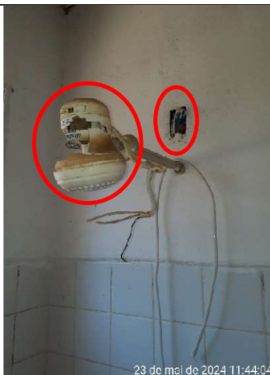
Figura 372 – Detalhes de cabos elétricos aparentes e chuveiro em situação precária
