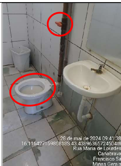
Figura 440 – Detalhes das ausências de assento na bacia sanitária e da válvula de descarga
