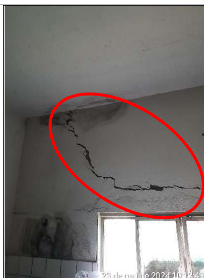
Figura 392 – Detalhe de rachadura na parede da cozinha
