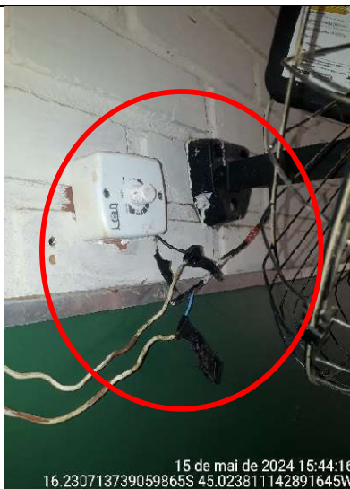
Figura 237 – Detalhes de cabos elétricos aparentes e com remendos na sala de aula
