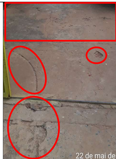
Figura 304 – Detalhes de buracos e rachaduras na rampa de acesso à escola, lados externo e interno
