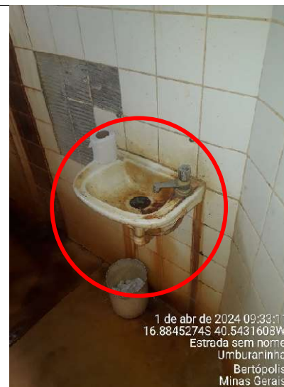
Figura 40 – Detalhe da precariedade das condições de higiene do lavatório
