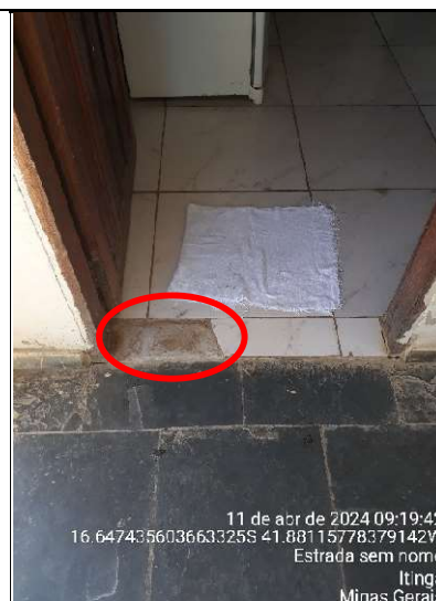
Figura 7 - Detalhe de piso quebrado na entrada da cozinha
