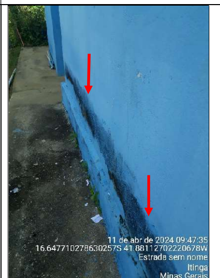
Figura 8 - Detalhe de manchas de umidade na parede, lado externo
