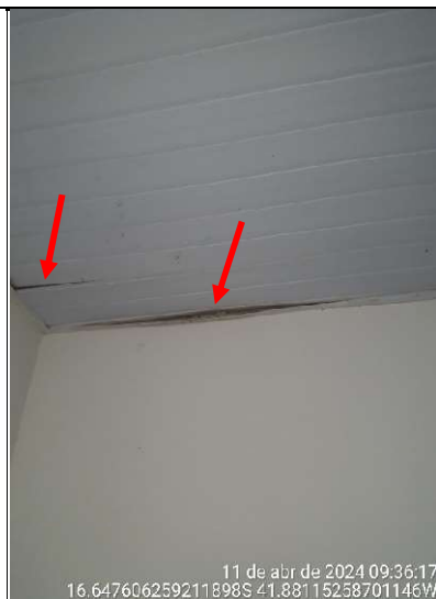
Figura 16 - Detalhe de infiltração no forro de PVC
