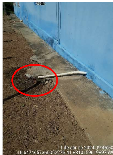
Figura 17 - Detalhe de lançamento direto no solo de efluente de esgoto da cozinha
