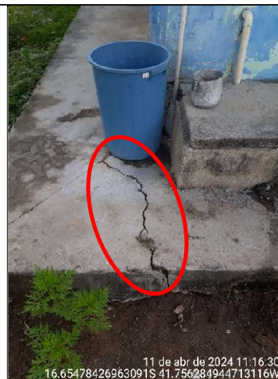
Figura 29 - Detalhe da rachadura na calçada
