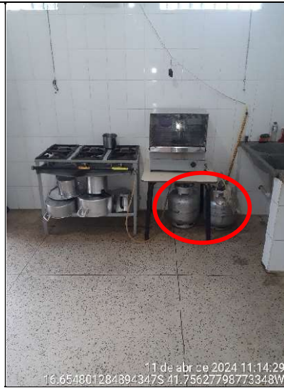
Figura 39 - Detalhe de dois botijões de GLP em uso (fogão e forno) na cozinha
