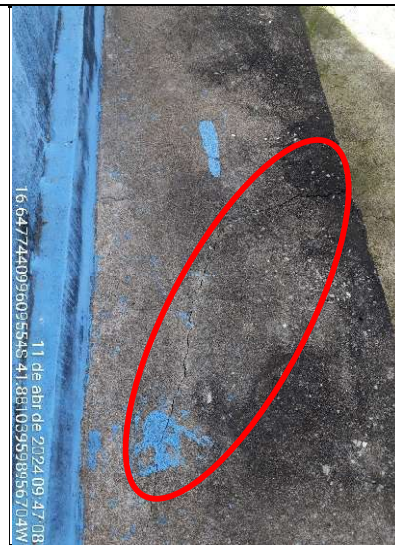
Figura 4 - Detalhe de trinca na calçada
