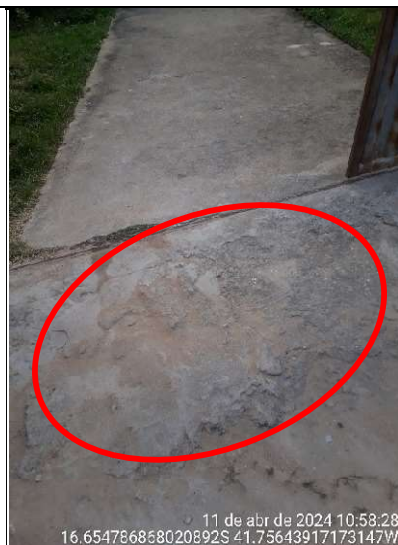
Figura 28 - Detalhe do concreto sem acabamento da rampa de acesso à escola
