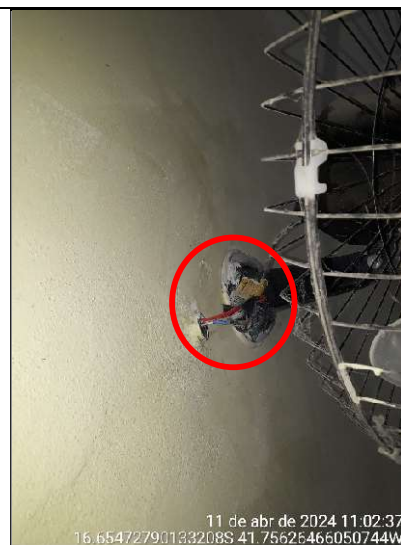
Figura 38 - Detalhe de remendo de cabo elétrico
