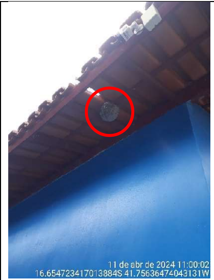
Figura 41 - Detalhe de caixa de marimbondo no beiral da cobertura
