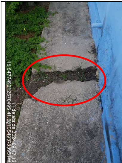
Figura 3 - Detalhe da calçada com trecho quebrado
