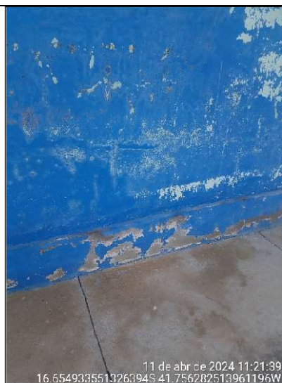
Figura 30 - Detalhes de desgastes na pintura, lado externo
