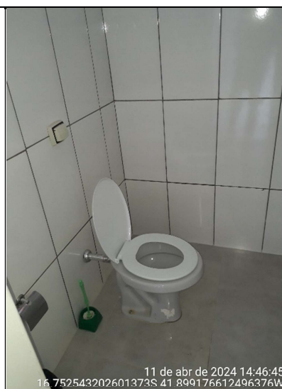
Figura 25 - Detalhe da ausência de barras e metais específicos para PcD
