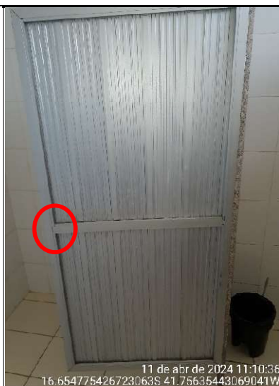
Figura 37 - Detalhe de porta de box sem trinco/fecho
