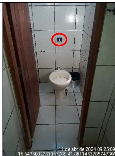
Figura 18 - Detalhe de bacia sanitária sem assento e válvula de descarga sem acabamento
