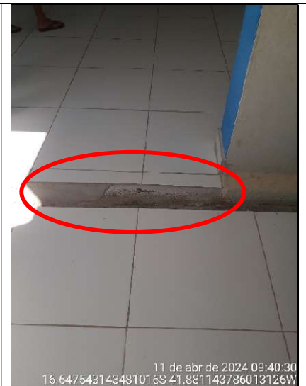
Figura 5 - Detalhe de desnível na entrada da sala de aula
