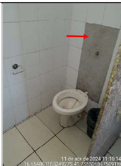
Figura 31 - Detalhes de bacia sanitária sem assento e parede sem azulejos
