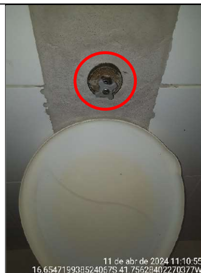
Figura 32 - Detalhe da válvula de descarga sem acabamento
