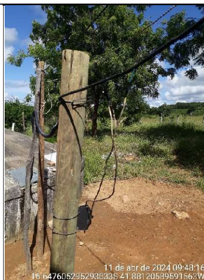
Figura 19 - Detalhe de cabo elétrico aparente e com remendos
