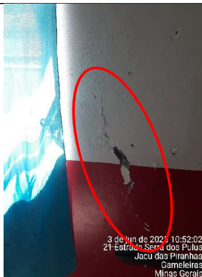
Figura 10 - Detalhe de rachadura na parede da sala de aula
