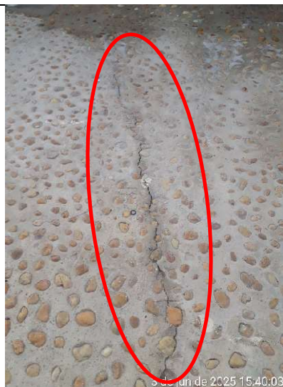
Figura 31 - Detalhe de rachadura na calçada interna de pedra
