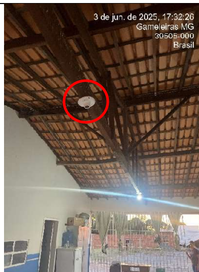
Figura 55 - Detalhe da ausência de lâmpada no pátio
