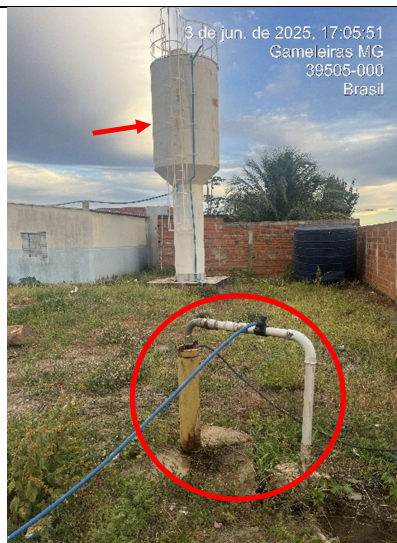
Figura 57 - Detalhes do poço próprio e reservatório da unidade escolar
