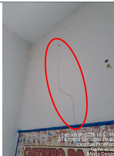
Figura 9 - Detalhe de trinca na parede da sala de aula
