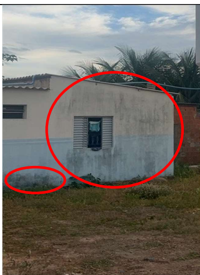
Figura 61 – Detalhe do desgaste da pintura da parede da sala de aula, lado externo
