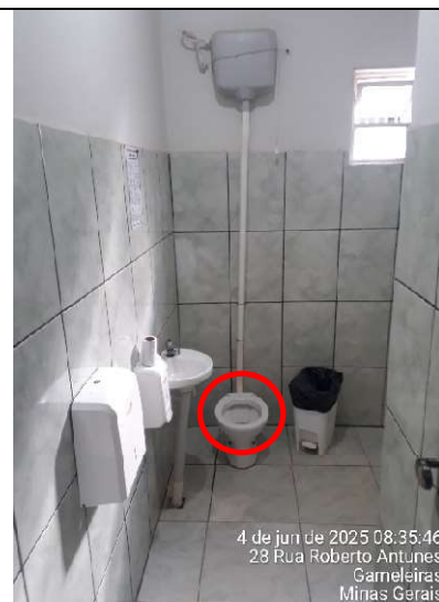
Figura 68 – Detalhe da ausência de assento na bacia sanitária
