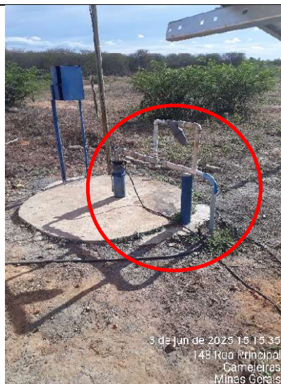
Figura 27 - Detalhe do poço próprio da escola
