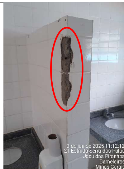
Figura 11 - Detalhe de parede danificada do banheiro masculino
