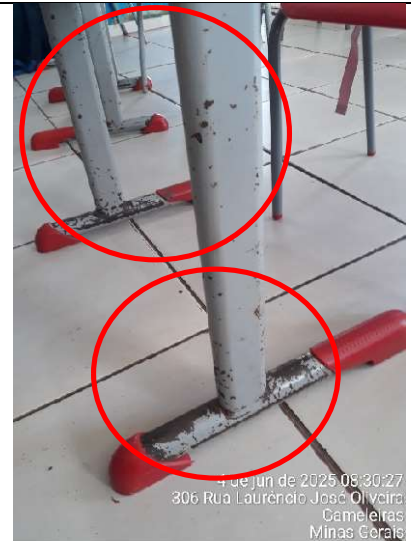
Figura 53 - Detalhe de ferrugem na mesa da sala de aula
