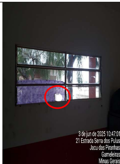
Figura 15 - Detalhe da janela da sala de aula com vidro quebrado
