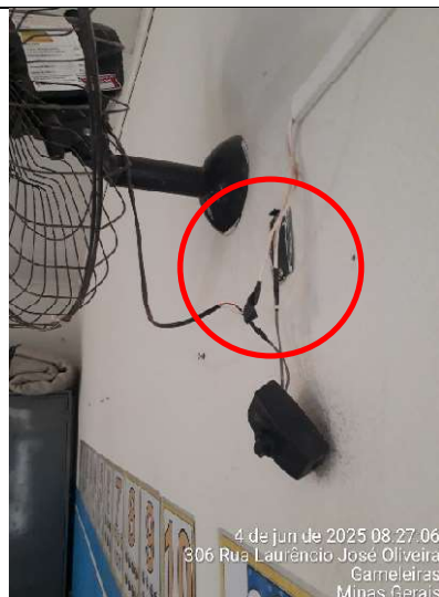
Figura 54 - Detalhe de cabos elétricos aparentes e com remendos
