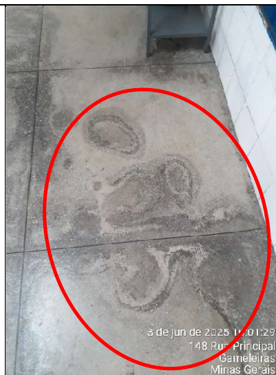
Figura 33 - Detalhe de manchas de umidade no piso da sala de aula
