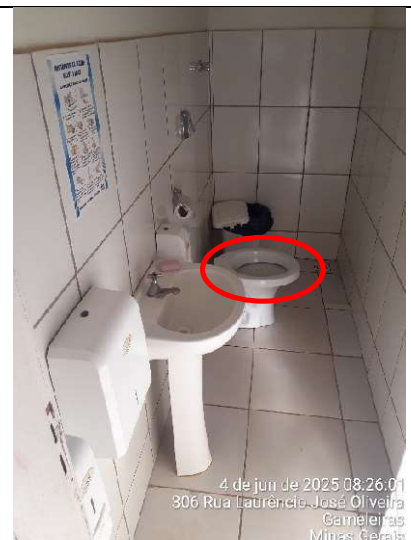
Figura 56 - Detalhe de bacia sanitária sem assento
