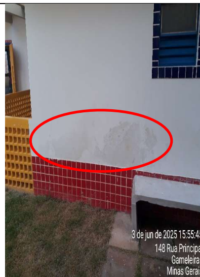
Figura 35 - Detalhe de mancha de umidade na parede da sala de aula, lado externo
