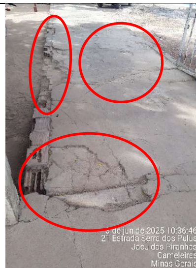
Figura 5 - Rampa de acesso à escola, com detalhes dos trechos quebrados, com buracos e rachaduras
