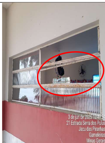
Figura 14 - Detalhe do vão sem vidro na janela da sala de aula
