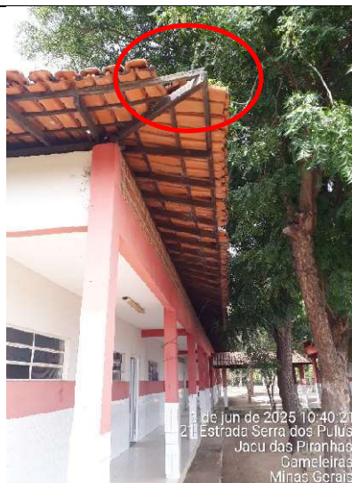
Figura 16 – Detalhe da ausência de telhas no beiral da cobertura
