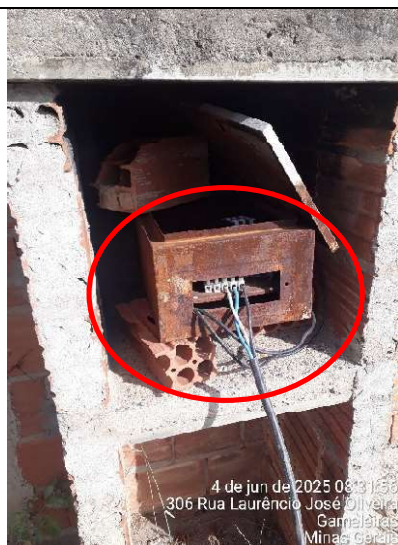
Figura 66 – Detalhe da precariedade da instalação elétrica da bomba do poço
