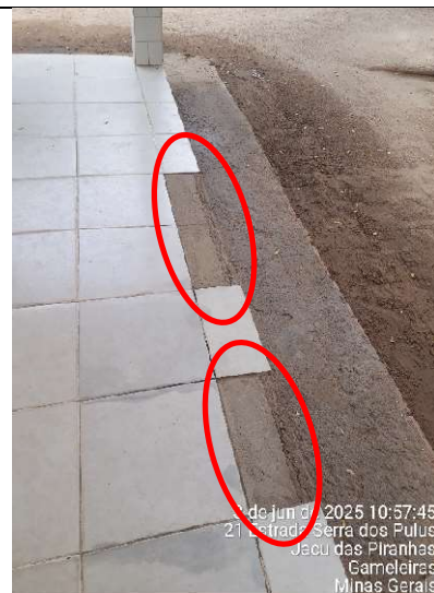
Figura 8 - Detalhe da ausência de pisos no pátio coberto da administração
