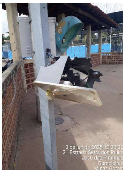
Figura 19 - Detalhe do quadro do medidor de entrada de energia quebrado
