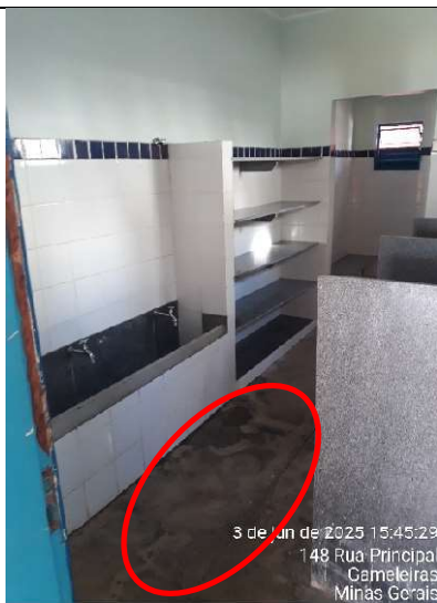
Figura 34 - Detalhe de manchas de umidade no piso do banheiro
