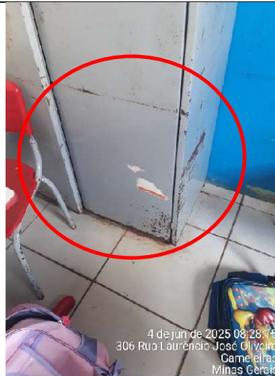
Figura 52 - Detalhe de ferrugem no armário da sala de aula
