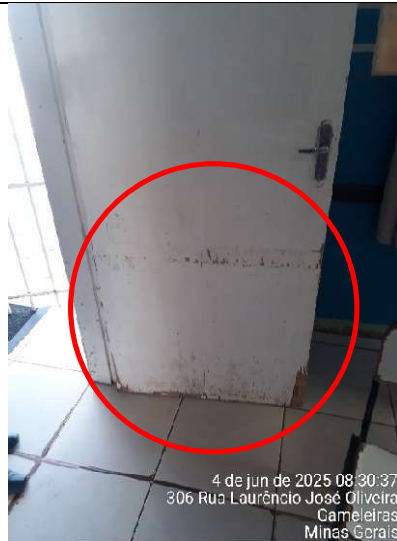
Figura 51 - Detalhe do mau estado de conservação da porta da sala de aula
