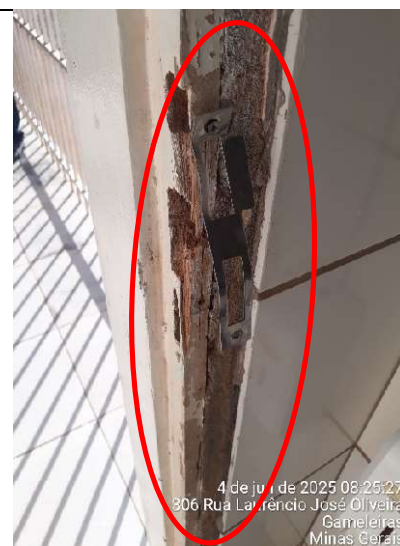
Figura 50 - Detalhe da precariedade do batente da porta do banheiro masculino
