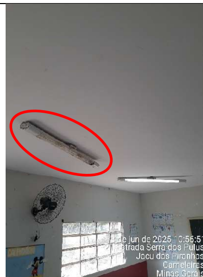
Figura 17 – Detalhe de lâmpada queimada na sala de aula
