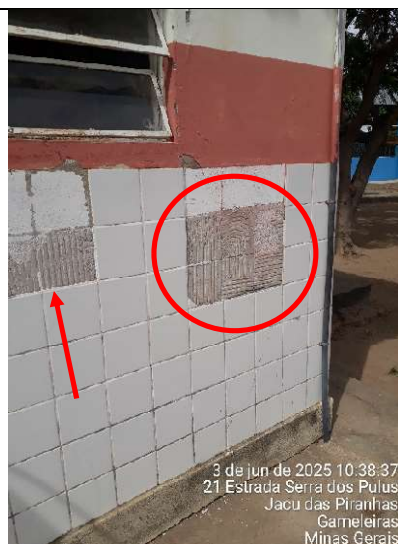
Figura 12 - Detalhes de trechos sem azulejos na parede, lado externo
