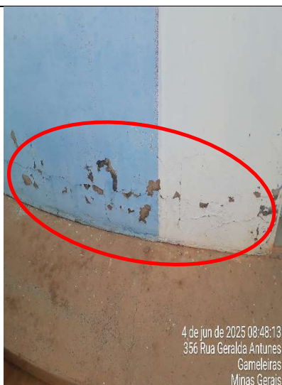
Figura 60 – Detalhe do desgaste da pintura da parede do banheiro, lado externo
