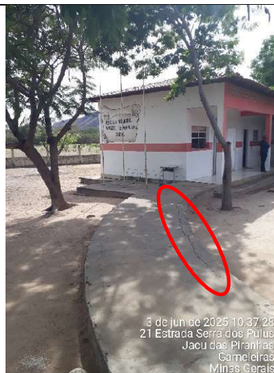
Figura 6 - Detalhe de rachadura na rampa de acesso ao bloco administrativo da escola
