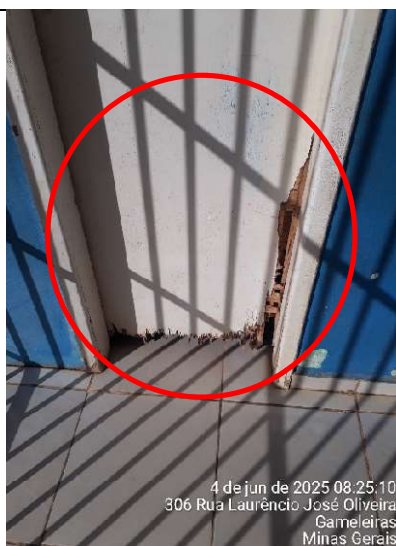
Figura 49 - Detalhe do mau estado de conservação da porta do banheiro masculino
