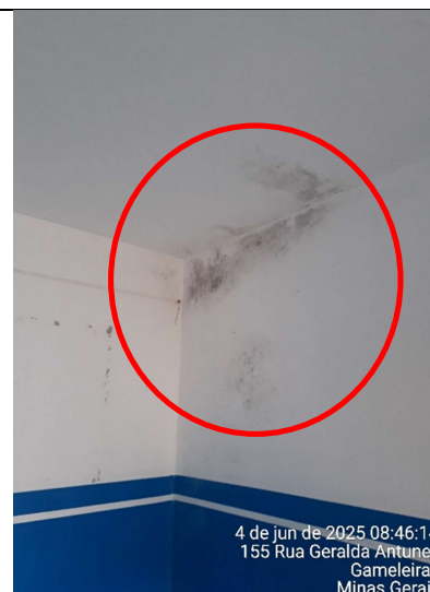
Figura 62 – Detalhe de manchas de umidade na parede e laje da sala de aula
