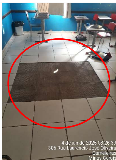
Figura 46 - Detalhe de local sem piso na sala de aula
