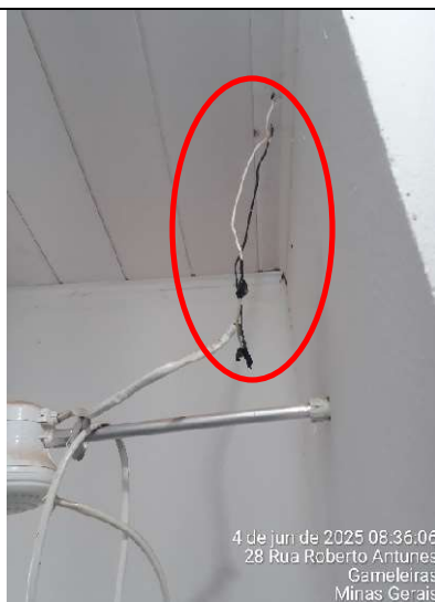
Figura 67 – Detalhe de cabos elétricos aparentes e com remendos
