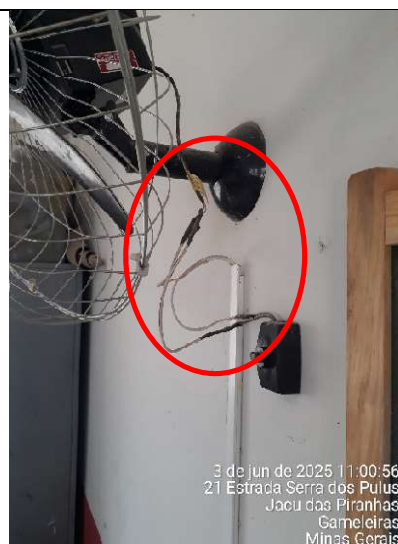
Figura 18 - Detalhe de remendos no cabo do ventilador da sala de aula
