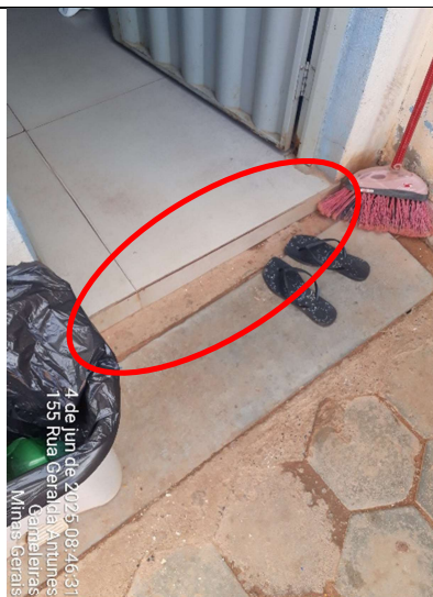
Figura 58 – Detalhe do desnível para acesso ao banheiro
