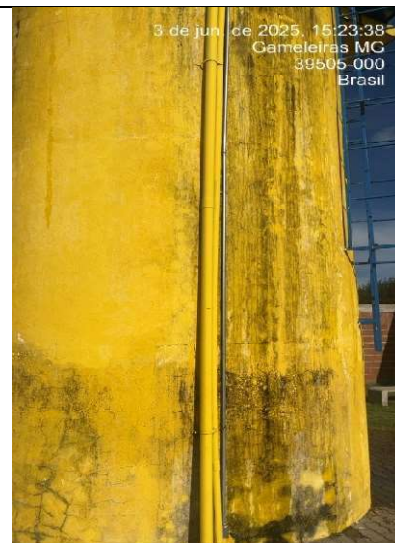
Figura 38 - Detalhe de manchas de infiltração no reservatório
