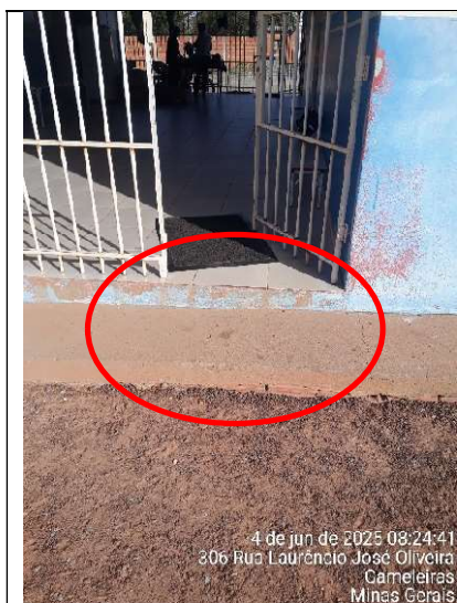
Figura 45 - Detalhe de desníveis da entrada principal para acesso ao pátio interno
