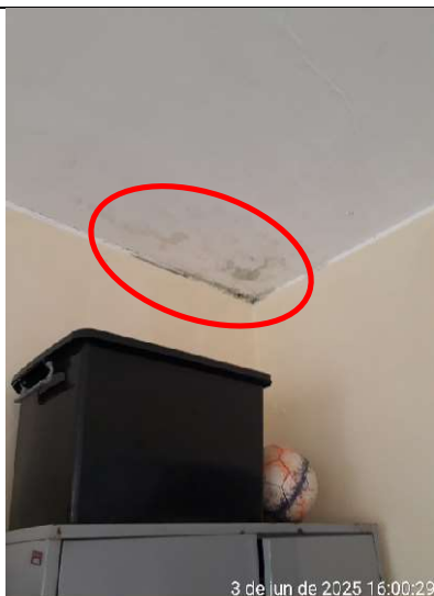
Figura 37 - Detalhes de mancha de umidade na laje da sala de aula
