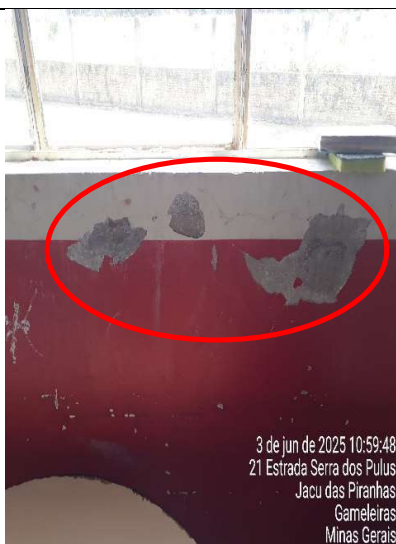
Figura 13 - Detalhe do desgaste da pintura na parede da sala e aula
