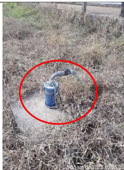
Figura 3 - Detalhe do poço que fornece água à escola
