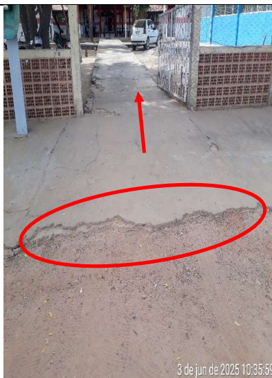
Figura 4 - Detalhe da calçada de acesso à escola, com bordas quebradas
