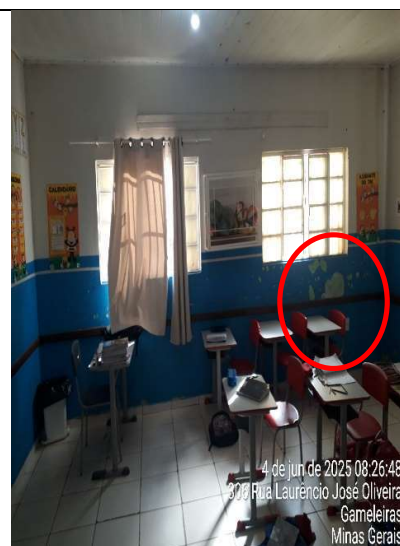
Figura 47 - Detalhe do desgaste da pintura da parede da sala de aula
