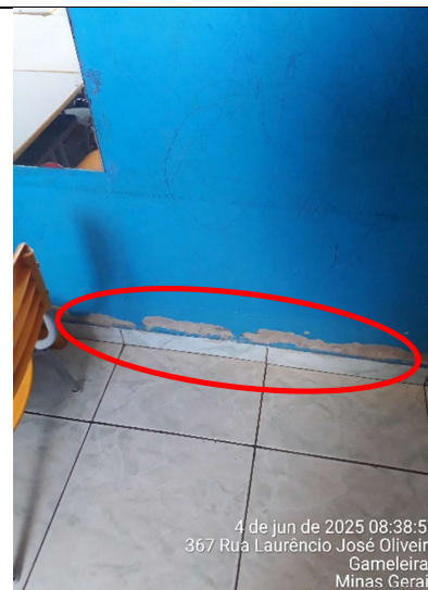
Figura 59 – Detalhe do desgaste da pintura da parede da sala de aula
