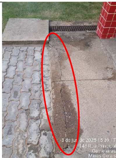
Figura 30 - Detalhe de rachadura na calçada interna de concreto
