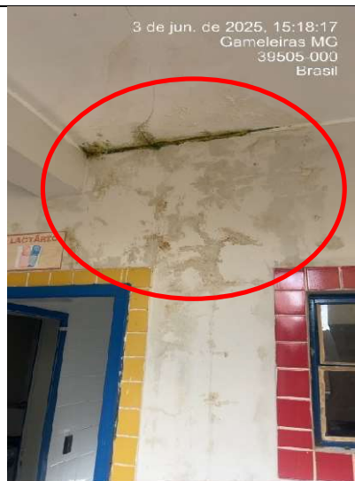
Figura 36 - Detalhe de manchas de infiltração na parede e laje do pátio
