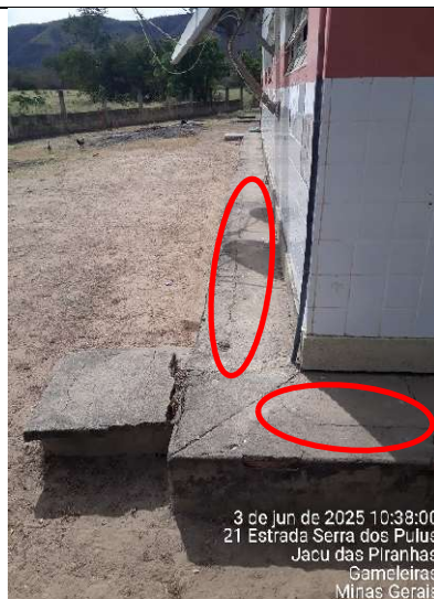
Figura 7 - Detalhes das rachaduras na calçada perimetral do bloco administrativo
