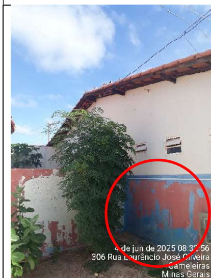
Figura 48 - Detalhe do desgaste da pintura da parede do banheiro, lado externo
