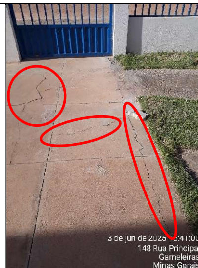
Figura 29 - Detalhe de trincas e rachaduras na calçada interna de acesso ao pátio
