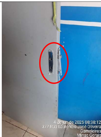
Figura 63 – Detalhe da ausência de maçaneta na porta do banheiro
